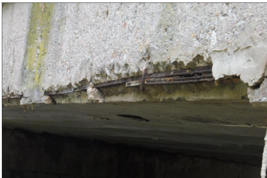
odhalená korodující výztuž v hraně NK.
