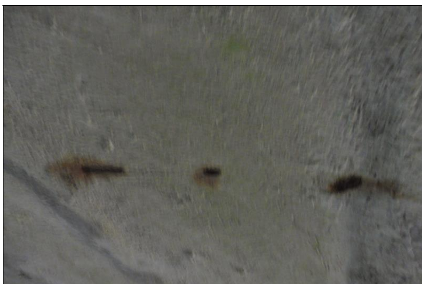
malá krycí vrstva + odhalená korodující výztuž na spodku NK.
