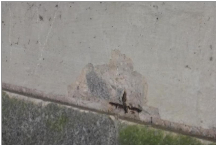
malá krycí vrstva + odhalená korodující výztuž v čele op.
