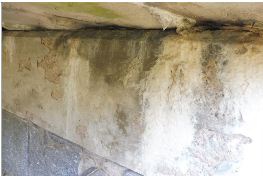
Zatékání v čele O2.
