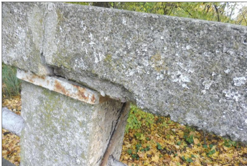
Poškození bet. sloupku.
