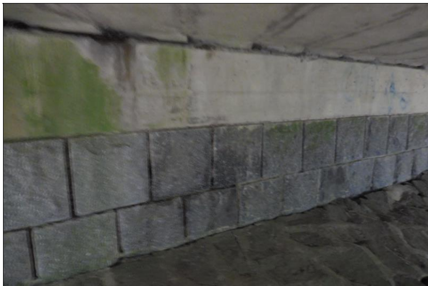
průsaky a výluhy v čele O2.
