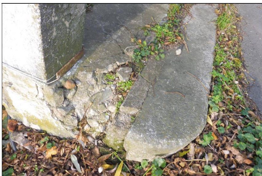
Poškozený konec římsy.
