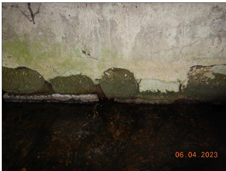
Detail vypadaného spárování v úrovni hladiny.
