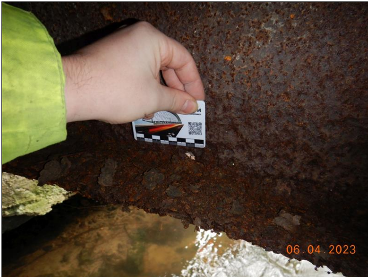
Silná koroze ocelových podélných nosníků - v jednom místě zcela prorezlá stojna.
