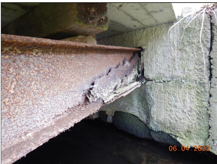
Silná koroze (delaminace) pásnic a stojny v místě uložení (pravý krajní nosník) u O2.
