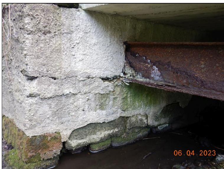
Silná koroze (delaminace) pásnic a stojny v místě uložení (pravý krajní nosník) u O1.
