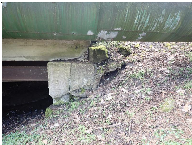
Eroze svahu levého křídla O1.
