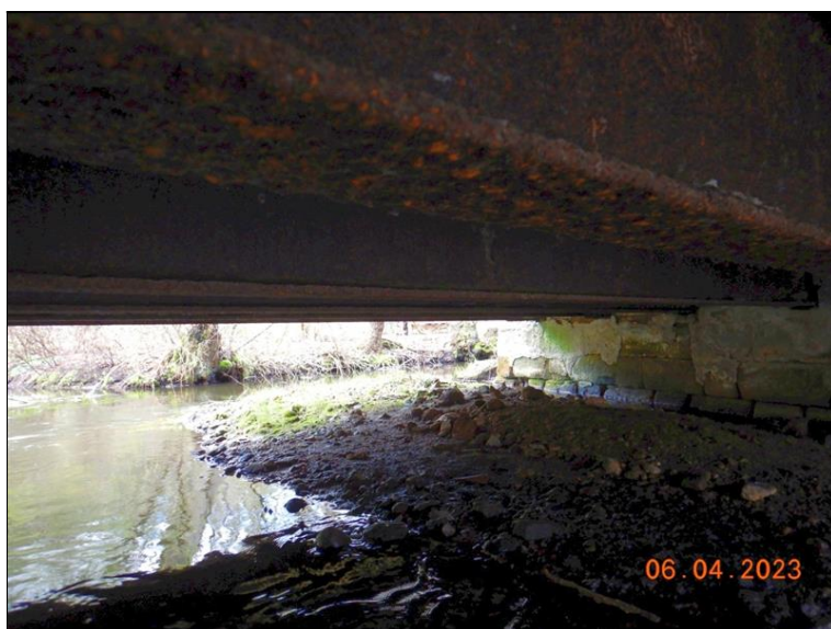
Silné nánosy v korytě, zvláště u opěry O2.
