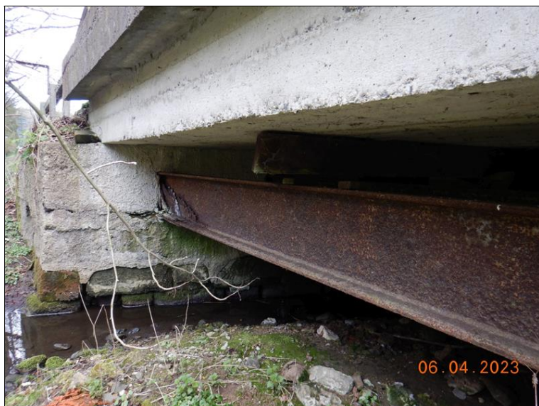
Pohled pod pravou římsou na O1 - podemleté zdivo, vypadané spárování.
