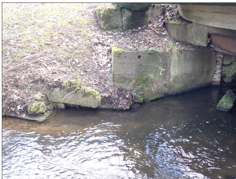
Podemletí křídla O2 na levé straně.
