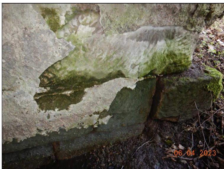
Detail rozvolněného zdiva na levém rohu opěry O1.
