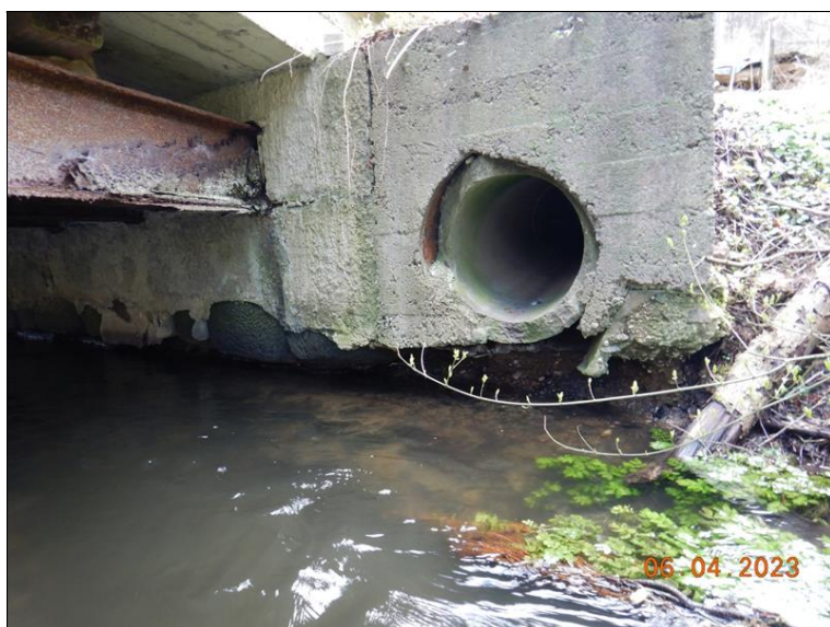
Silně podemletý vyústění trubky na pravé straně O2.
