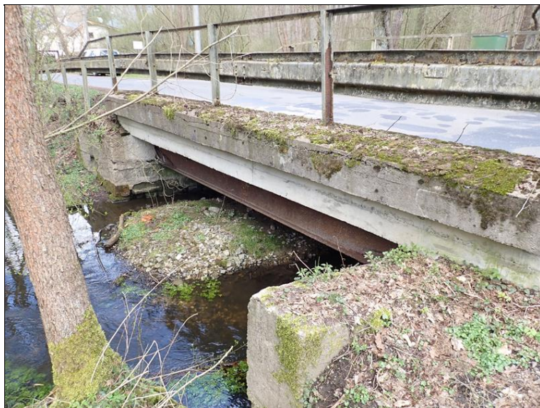
Celkový pohled na pravou stranu mostu. Množství nánosů v korytě.
