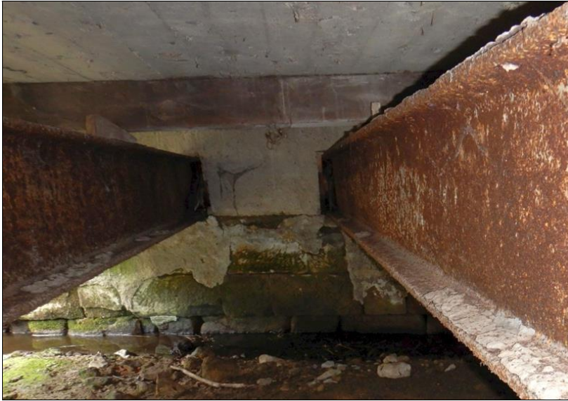
Pohled na O1 s opadaným torkretem a vypadaným spárování zdiva (zvláště v úrovni hladiny).
