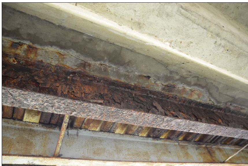
3.5_NK pole 1_detail koroze.jpg
