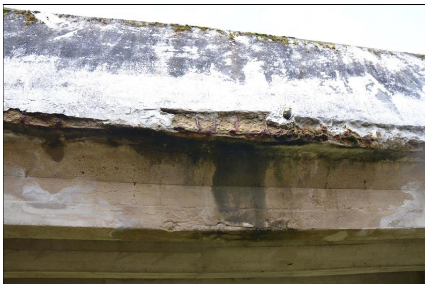
4.4_Levá římka detail koroze.jpg
