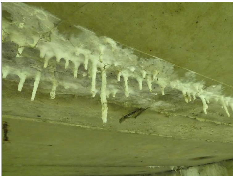
Podhled NK u levého okraje.
