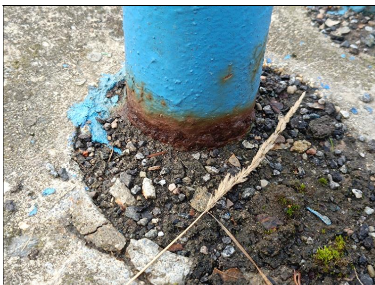
109_Korozní oslabení sloupku zábradlí.jpg
