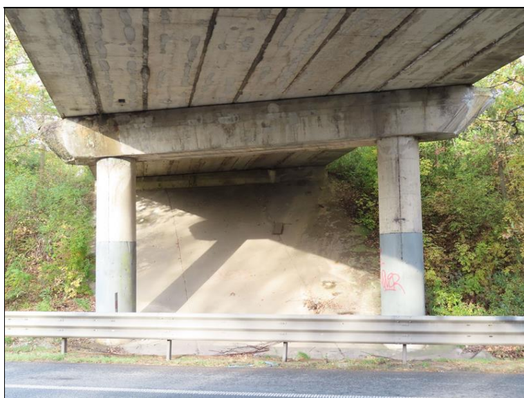
321_Pilíř P2 zatékání hloubková degradace betonu.JPG
