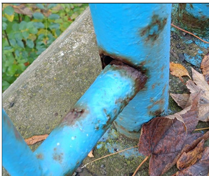
103_Přerušený dolní prvek zábradlí.jpg
