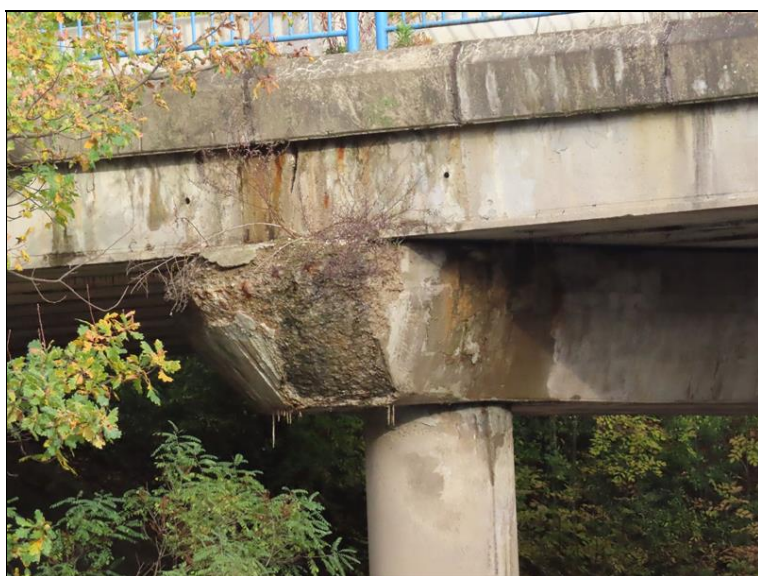
324_Pilíř P2 zatékání hloubková degradace betonu.JPG
