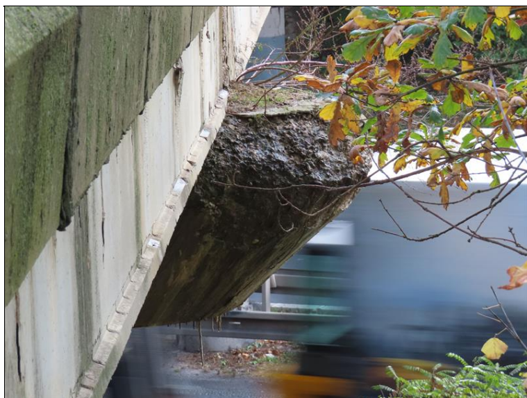
308_Hloubková degradace betonu pilíře P2.JPG
