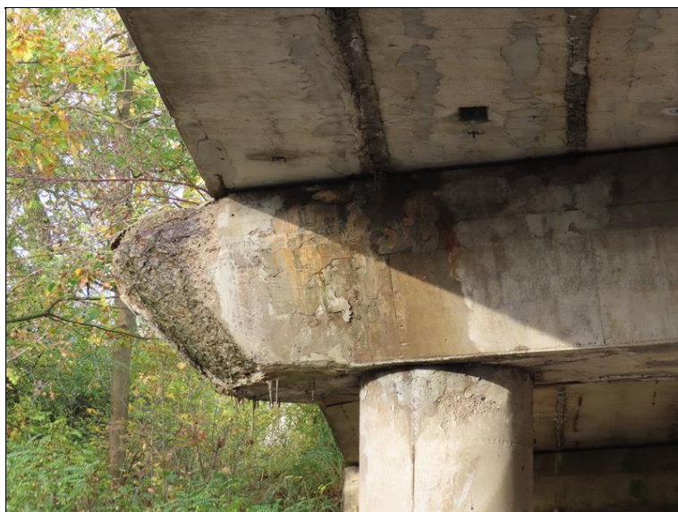
323_Pilíř P2 zatékání hloubková degradace betonu.JPG
