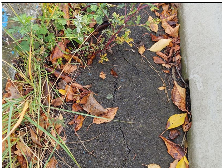
106_Vegetace ve spárách chodníku trhliny v krytu.jpg
