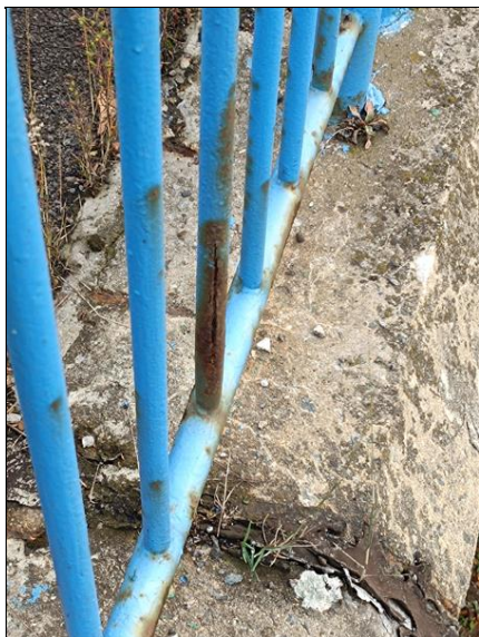
110_Trhlina ve svislici zábradlí.jpg
