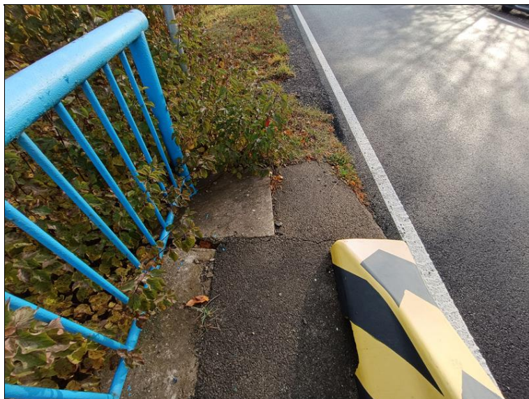
118_Uvolněný betonový blok za opěrou O1.jpg
