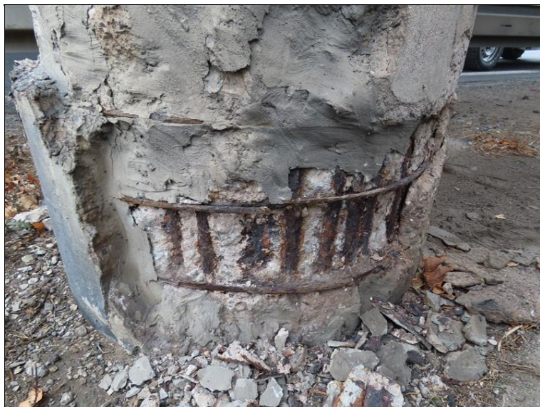
414_Pilíř P3 hloubková degradace betonu a koroze výztuže.JPG
