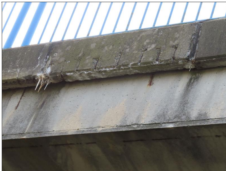
504_Výluhy na povrchu římsy.JPG
