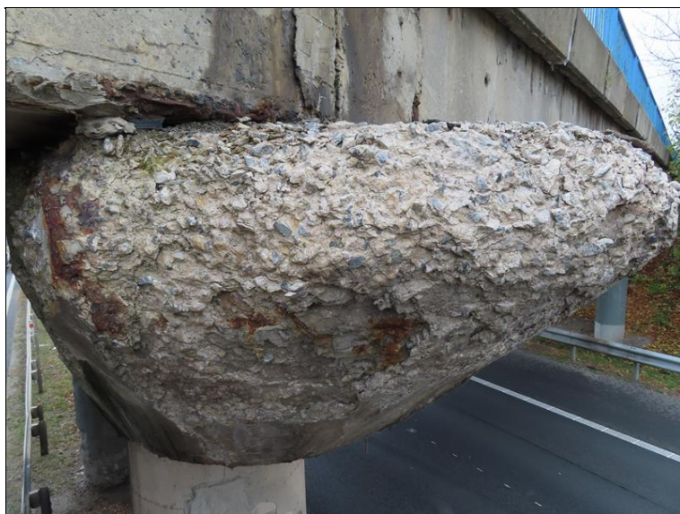
422_Degradace betonu stativa pilíře P3.JPG
