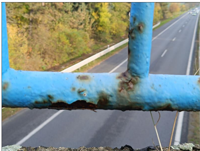
116_Koroze prvku zábradlí.jpg
