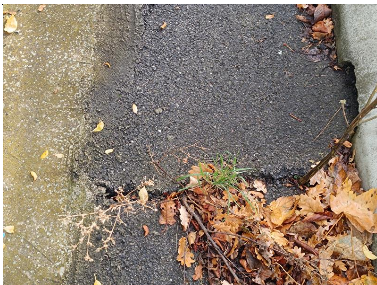
115_Příčná trhlina v krytu pravostranného chodníku.jpg
