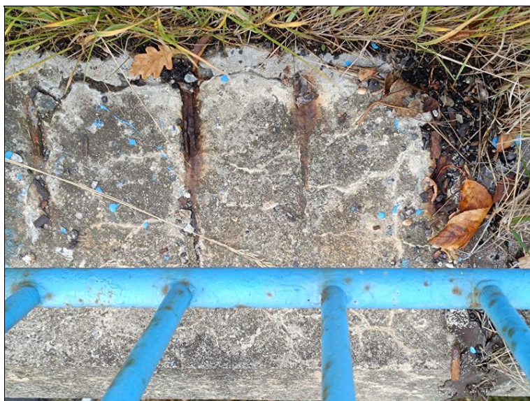
107_Koroze výztuže římsy.jpg
