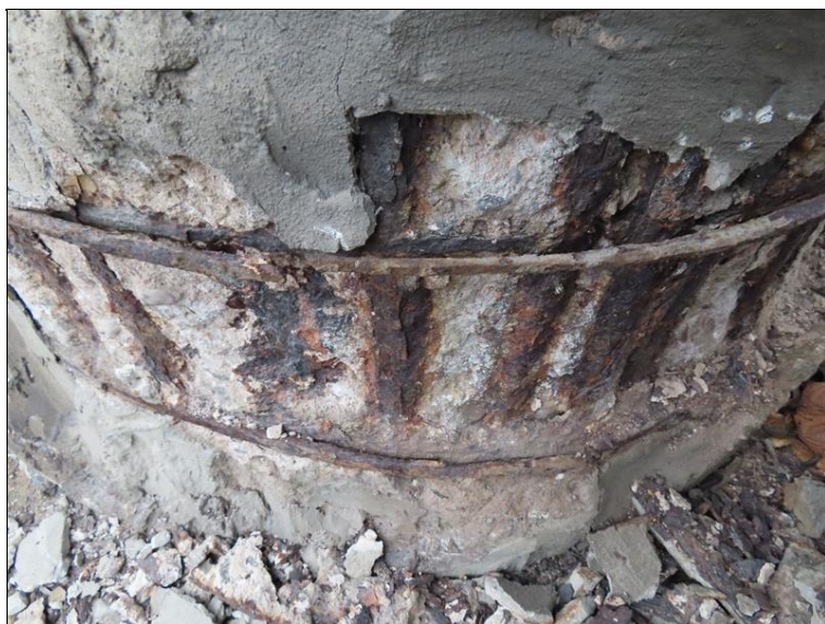
415_Pilíř P3 hloubková degradace betonu koroze podélné i příčné výztuže.JPG
