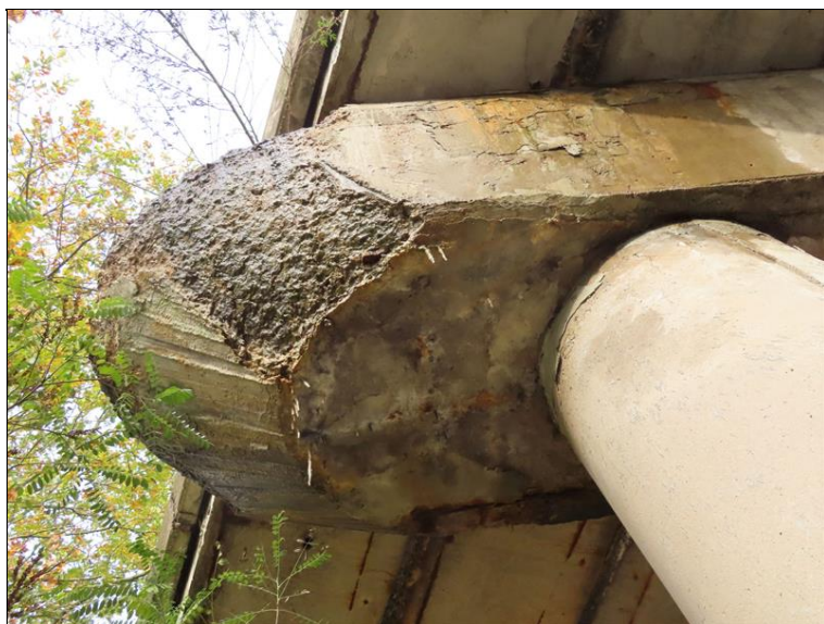
322_Pilíř P2 zatékání hloubková degradace betonu.JPG
