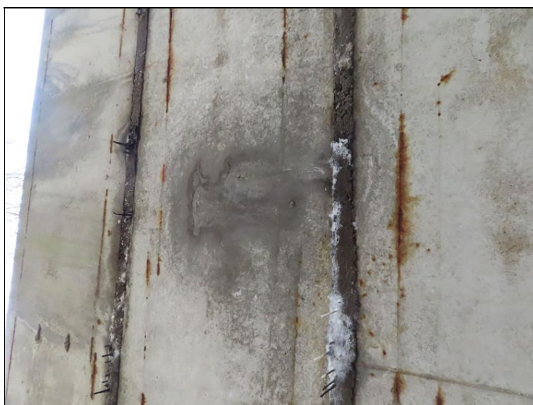
602_Podélná trhlina v nosníku.JPG
