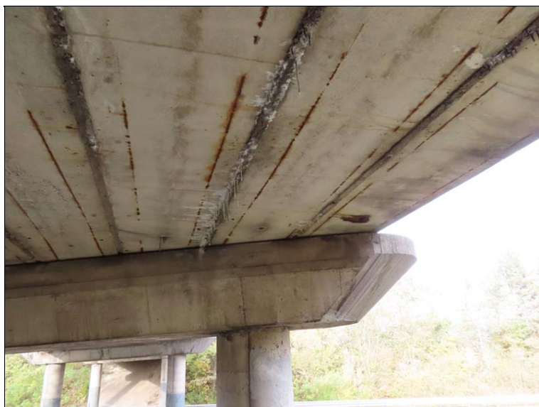
604_Pole 4 výluhy sintru mezi nosníky KA.JPG
