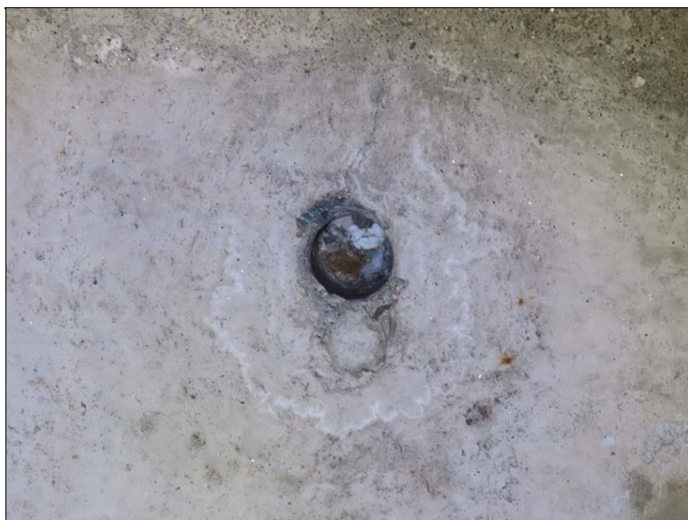
352_Pole 2 odvodňovací otvor je ucpan.JPG
