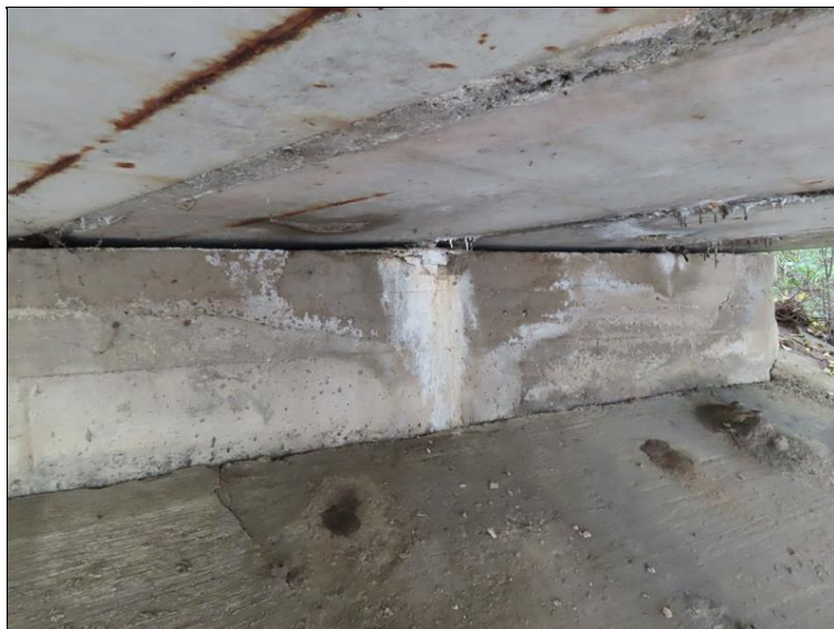
204_Výluhy ze spár nosníků KA.JPG
