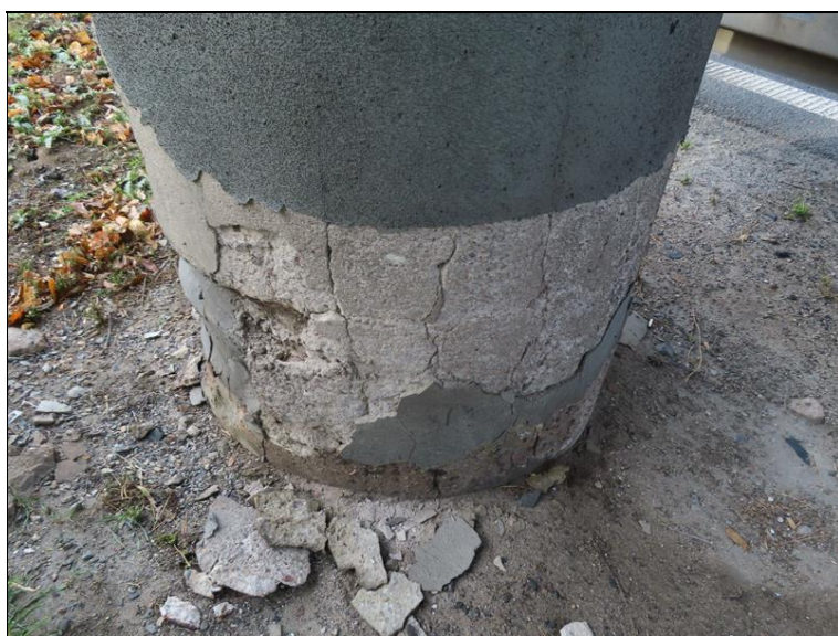
416_Pilíř P3 hloubková degradace betonu.JPG
