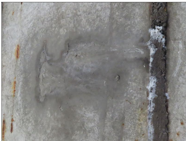
603_Podélná trhlina v nosníku.JPG
