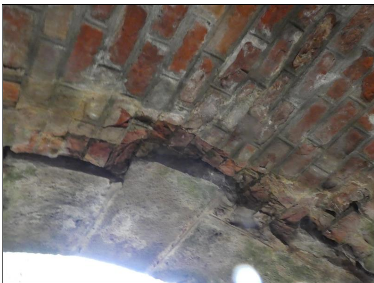
Separace čelní zdi.
