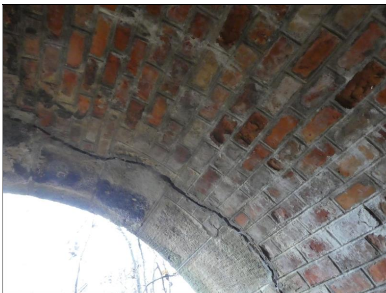
Separace čelní zdi.
