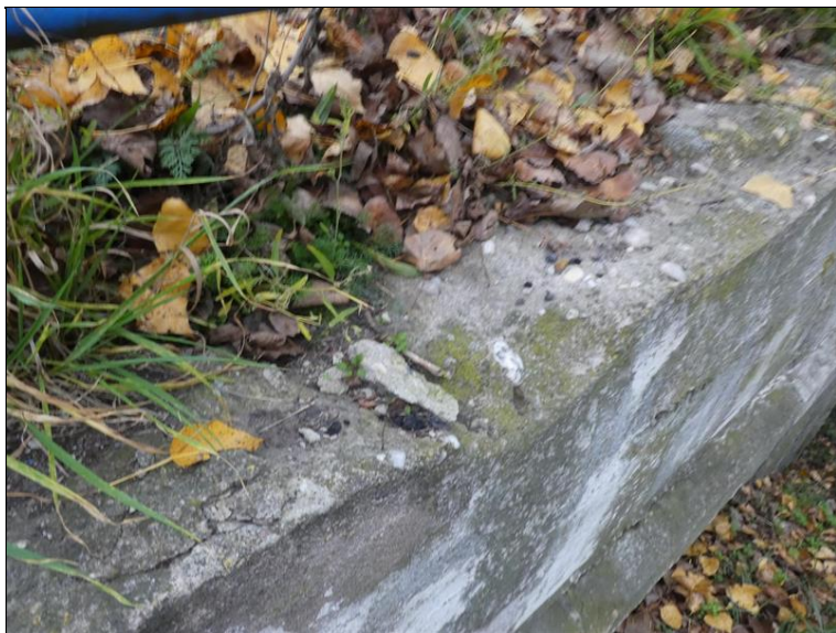
degradace betonu římsy.
