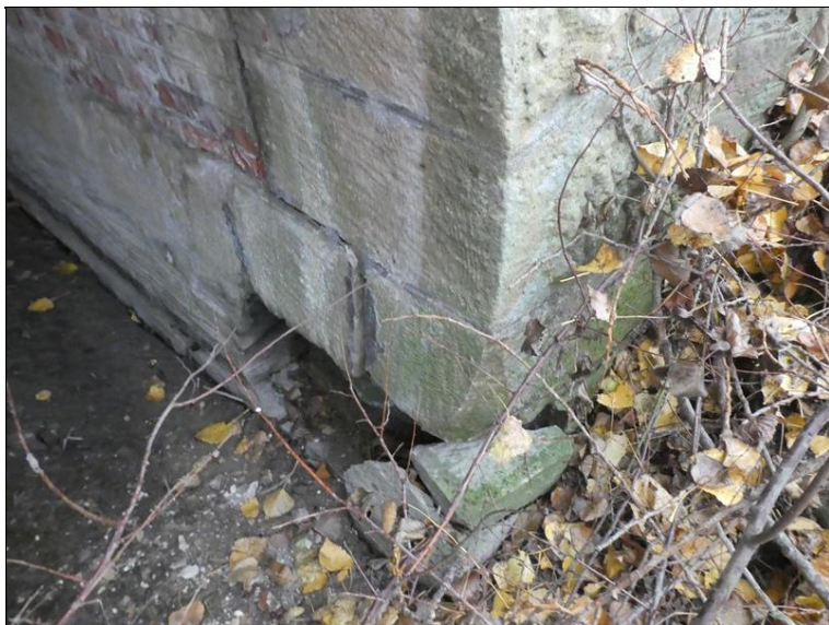
Podemletí rohu opěry.
