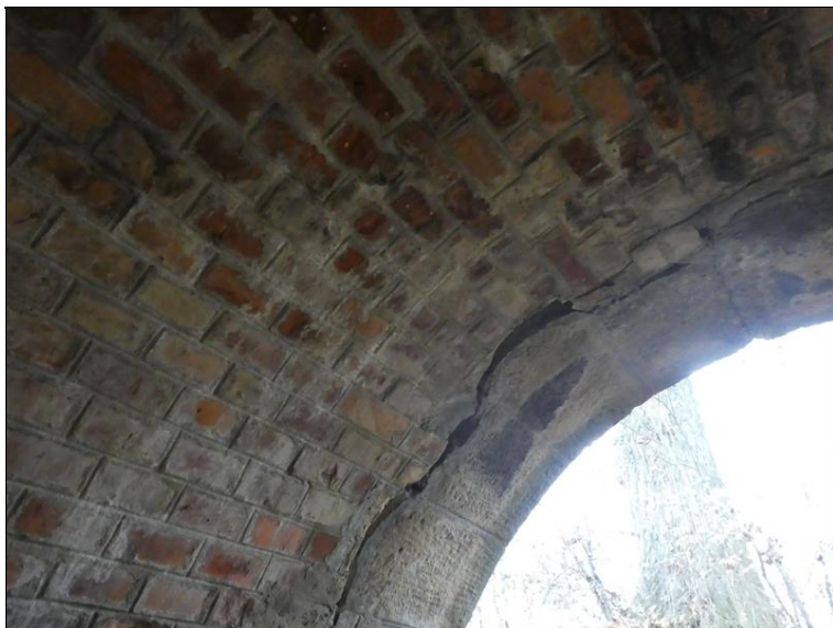
Separace čelní zdi.
