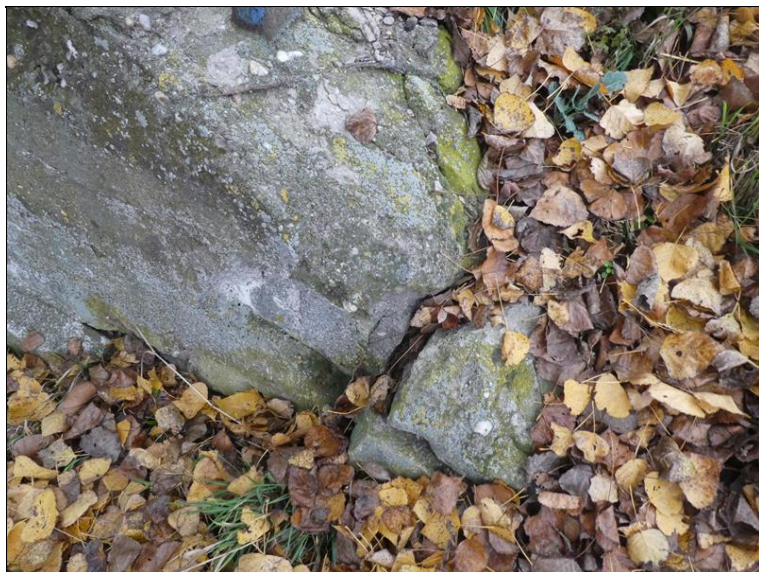
odpadlý kus betonu na konci římsy.
