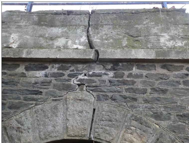
Svislá trhlina v ČZ.
