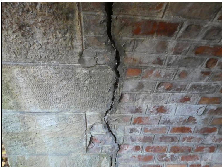
Separace čelní zdi.
