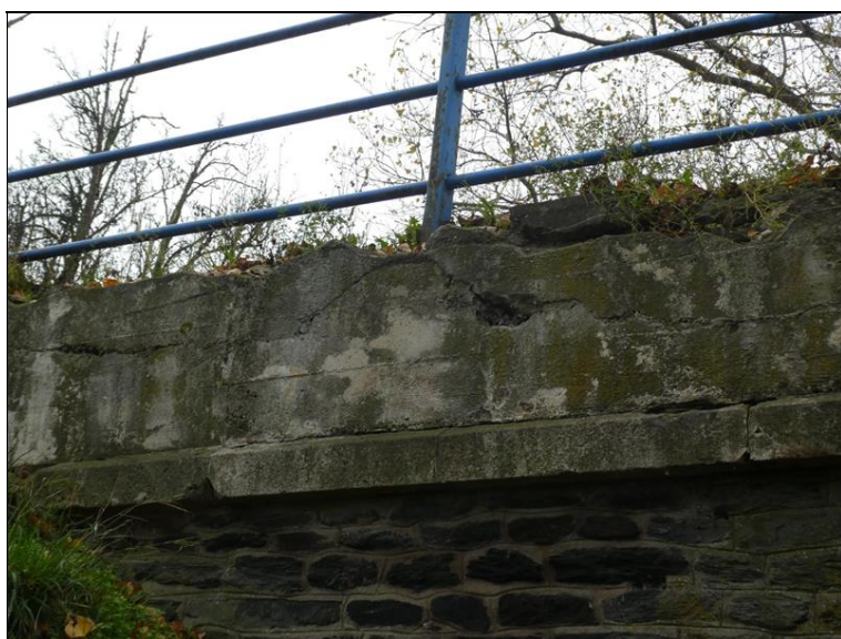
hloubková degradace betonu římsy.
