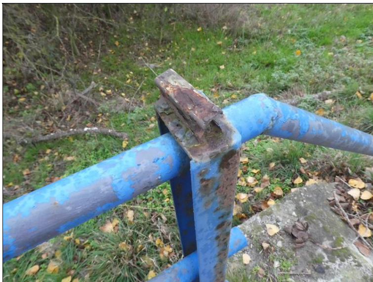
Stav PKO zábradlí.
