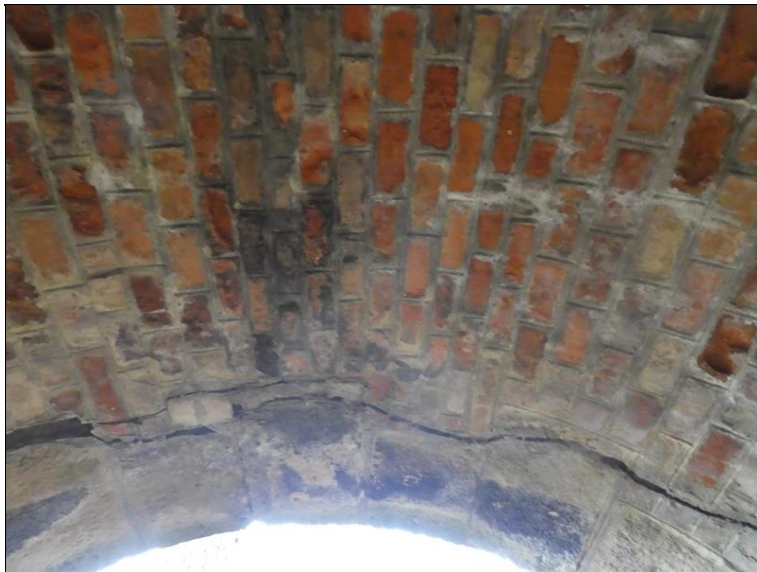
Separace čelní zdi.
