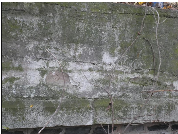
průsaky a výluhy na boku římsy.
