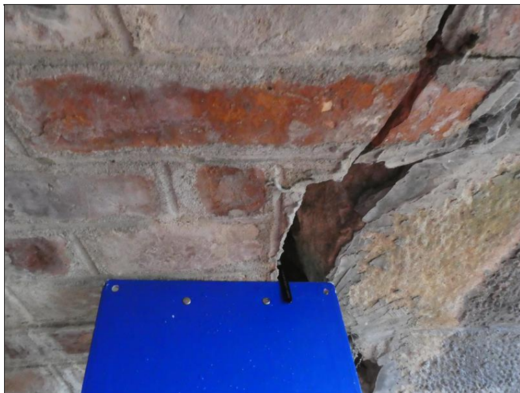
Separace čelní zdi.
