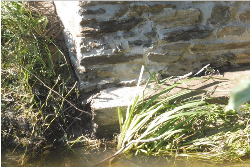
Poškození prahu před O2 L.
