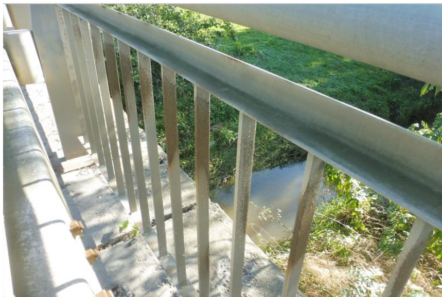
Stav PKO zábradlí.
