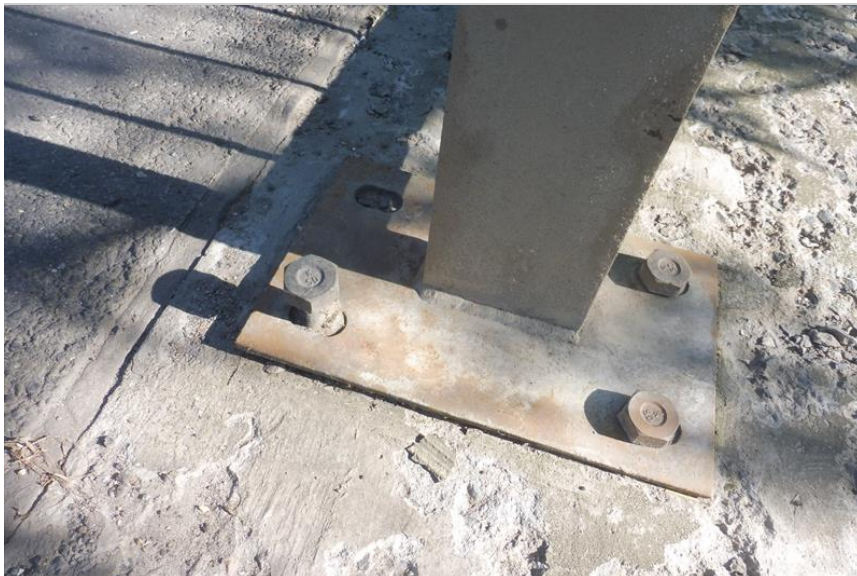
Koroze pat. desky svod.
