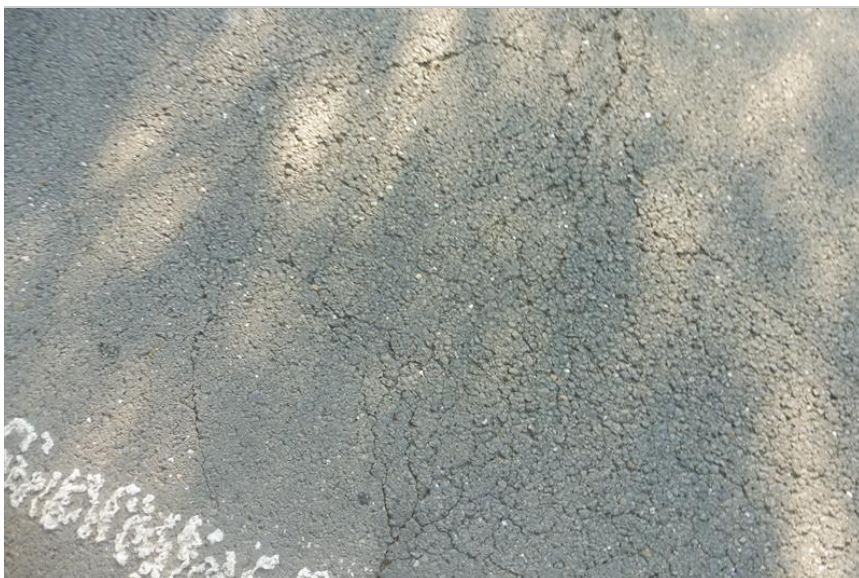
degradace asfaltového krytu vozovky.
