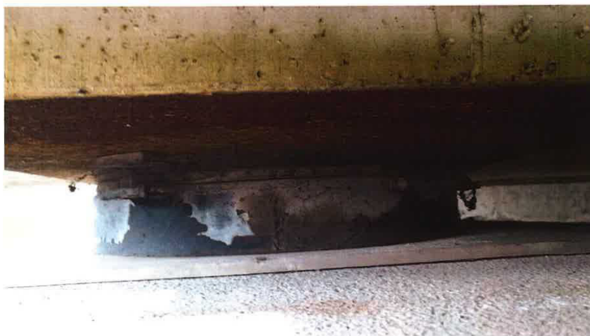
Opěra O1, pravé ložisko – pohled na pravé ložisko, plošná koroze klínové desky, degradovaný nátěr ložiska, mezera mezi povrchem opěry PVC vložkou
