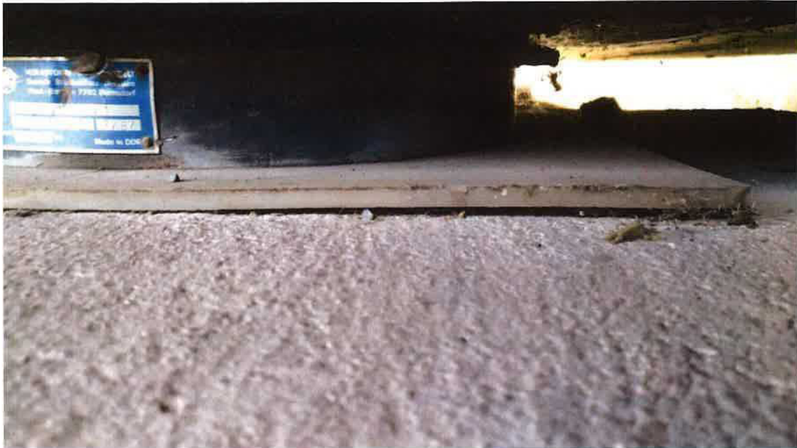
Opěra O1, levé ložisko – mezera mezi opěrou a PVC vložkou.
