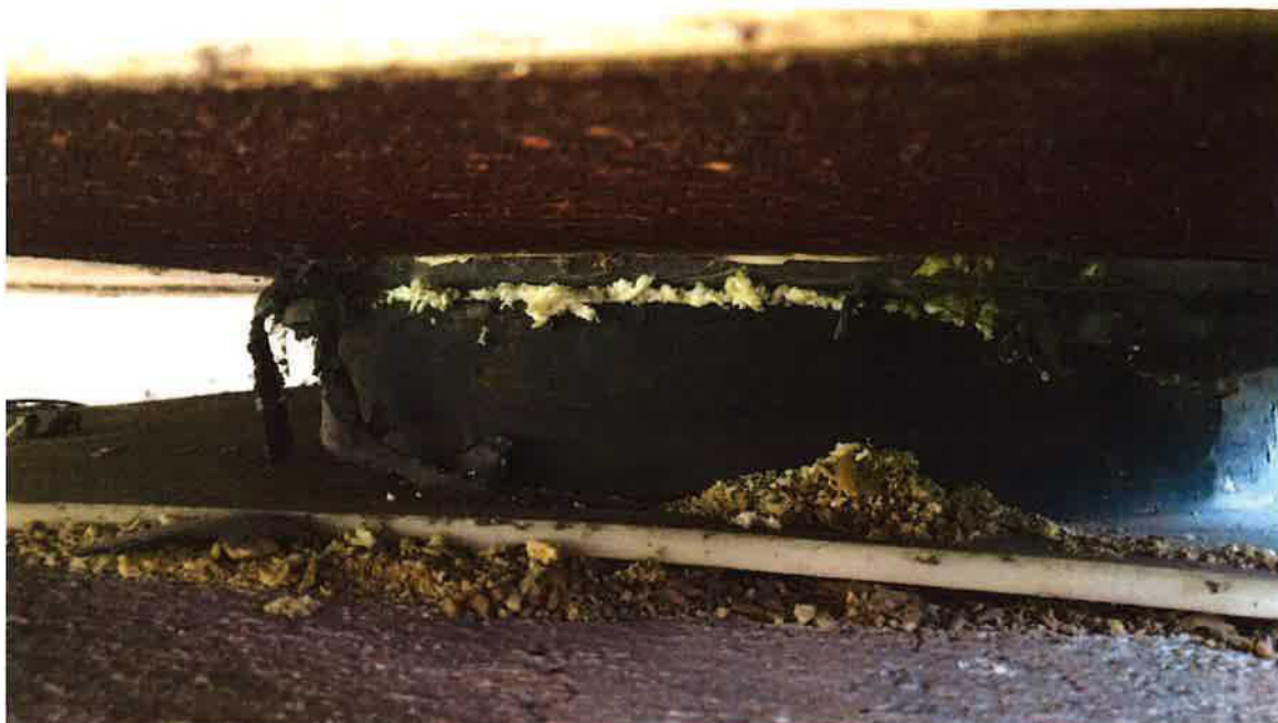
Opěra O1, levé ložisko – vytlačování vnitřní vložky, poškozené vnější těsnění, koroze klínové desky a deformace vložky mezi ložiskem a opěrou.
