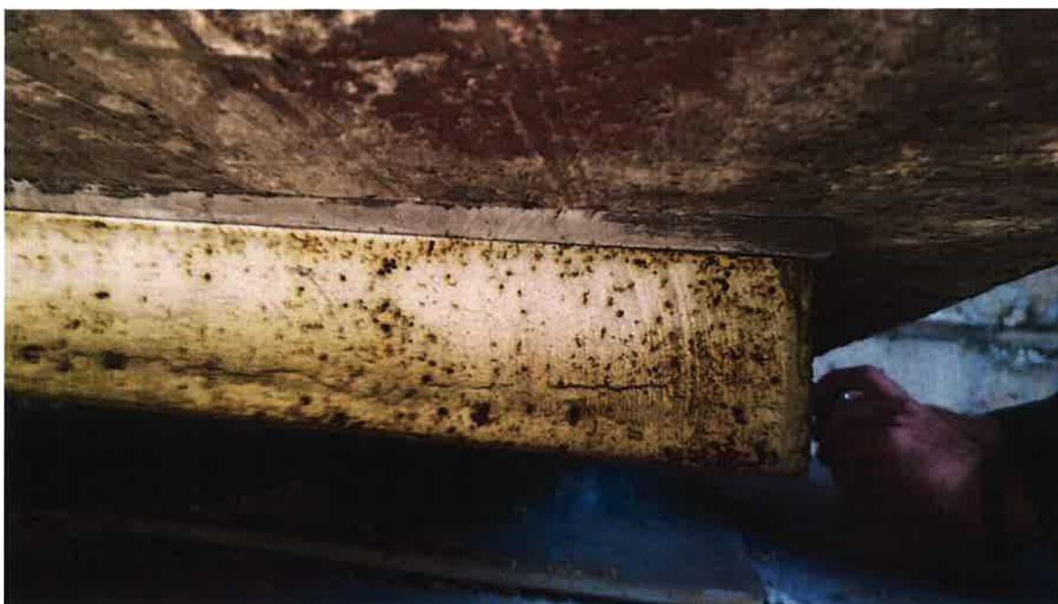
Opěra O1, levé ložisko – detail klínové desky a PVC nebo polyamidové vložky
