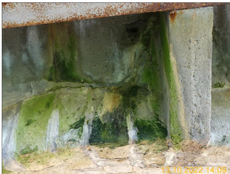
Průsaky a bionapadení na nosné konstrukci
