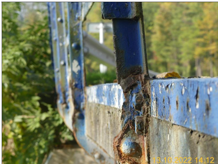
Koroze zábradlí v místě upevnění
