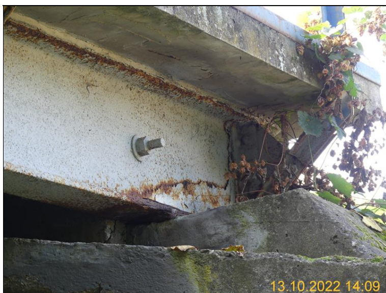
Koroze na nosníku pravého chodníku
