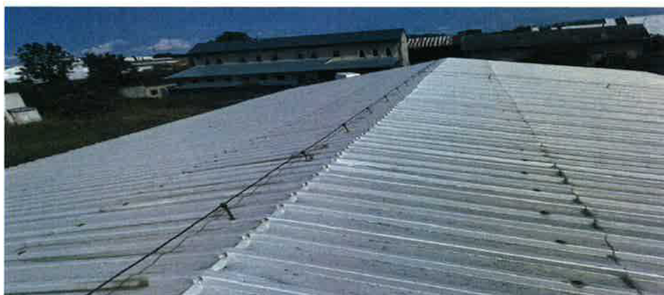
- nutno projít všechny spoje a těsnit tmelem kotevní prvky
