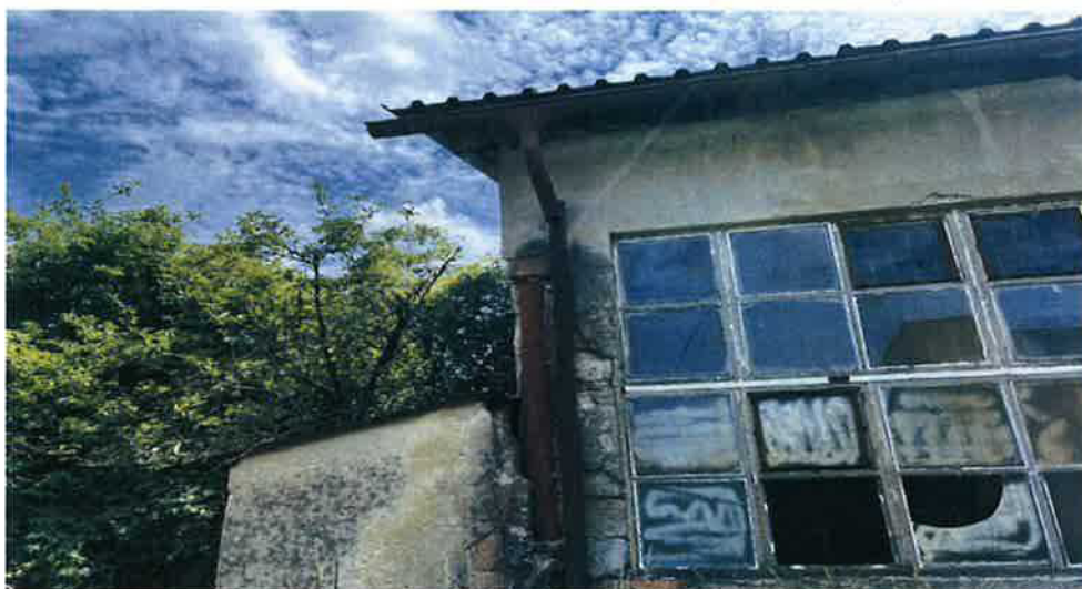
Budova č.2 – opravit, spojit svod
