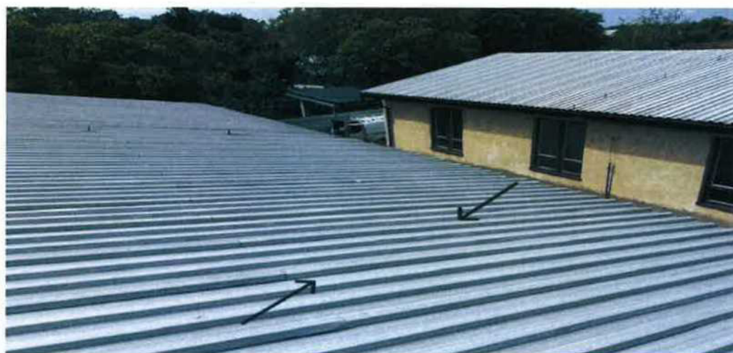
Budova č.3 a č.4 – chybějící U profil na spoji plechů 12bm
