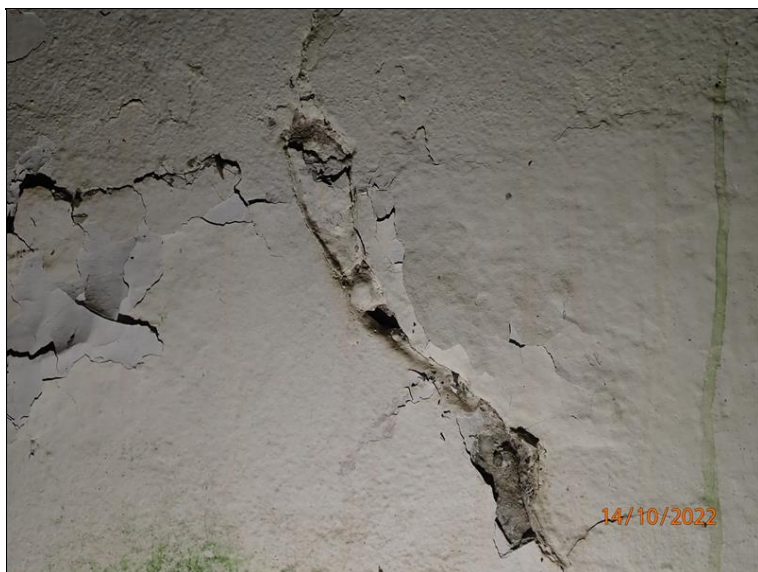
70 - Detail poškození betonové obezdívky a nátěru (lokace dle předchozího snímku).
