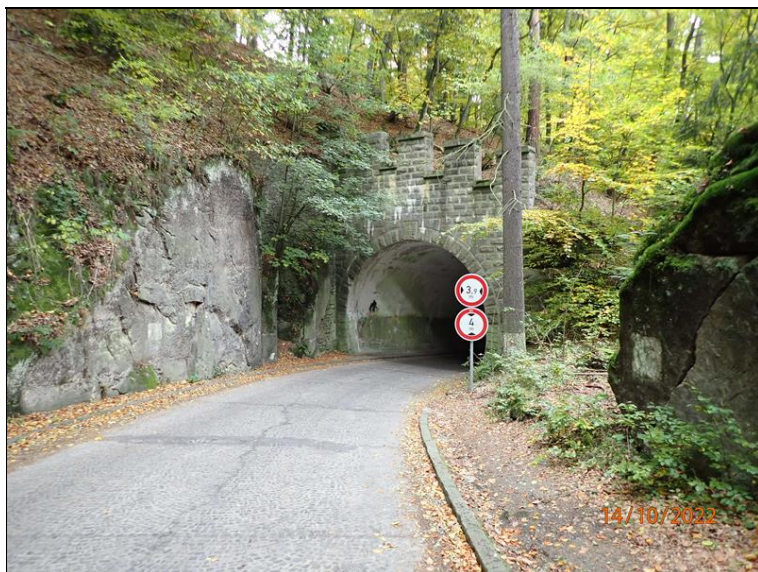
01 - Celkový pohled zdola na západní portál tunelu od pravé strany III/2733 (po směru staničení)
