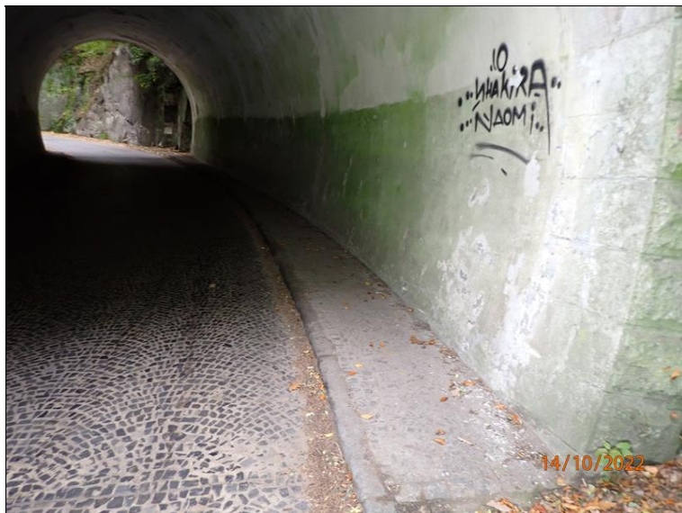
25 - Pohled na levý chodník v podjezdu od levé strany východního portálu (proti směru staničení)
