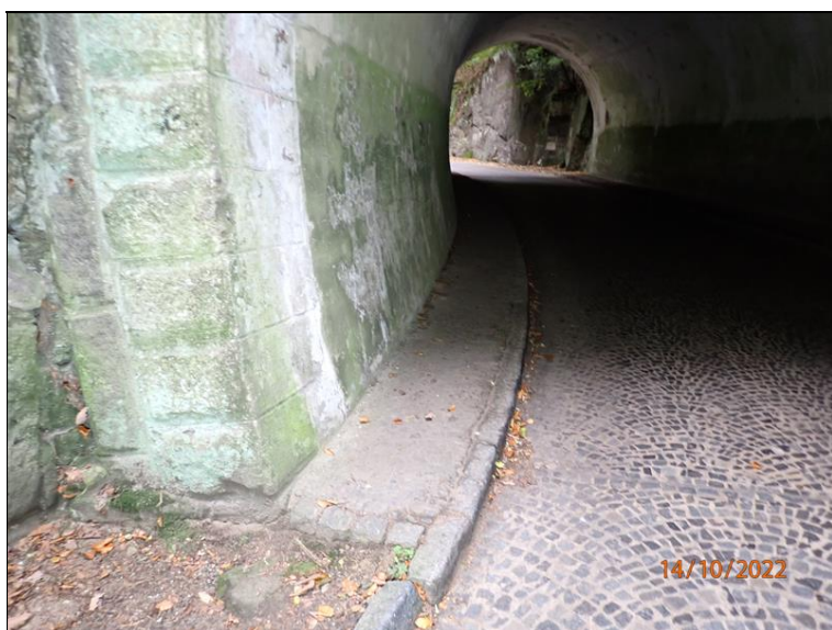
24 - Pohled na pravý chodník v podjezdu od pravé strany východního portálu (proti směru staničení)
