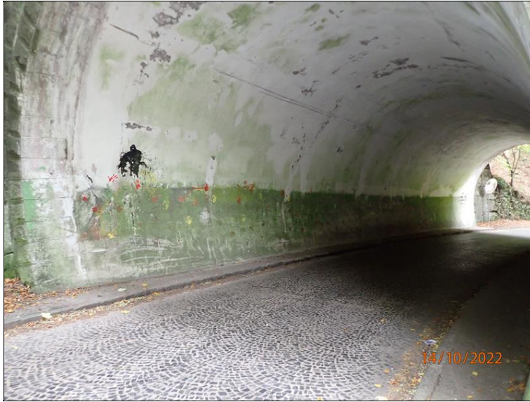
19 - Celkový pohled na levou stranu tunelu (levou opěru) od pravé strany západního portálu
