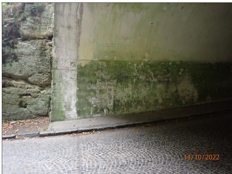
56 - Kvádrové zdivo v dolní části pravé strany východního portálu a navazující obetonávka (pravá opěra) v podjezdu.
