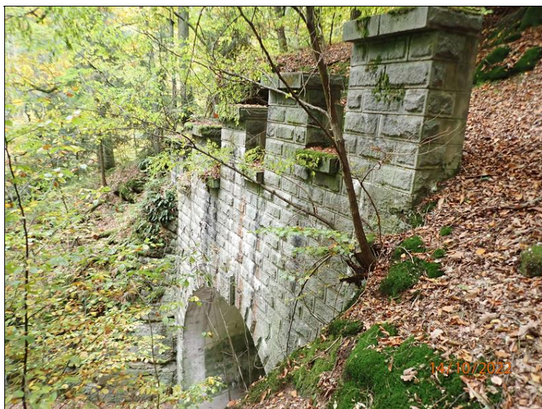
32 - Boční pohled shora na cimbuří a horní část východního portálu tunelu (zleva)
