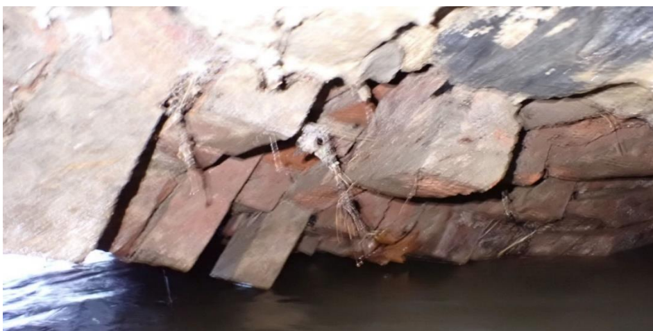
Obr 9: Významné poruchy nosné konstrukce mostu ev.č. 337-010
