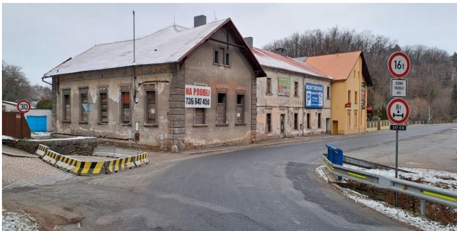
Obr 10: Pohled na most ev.č. 337-010 – stavební úpravou zamezeno najíždění nad poruchy klenby
