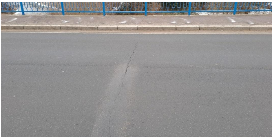
Obr 13: Neřešené dilatační pohyby konstrukce mostu 337-011
