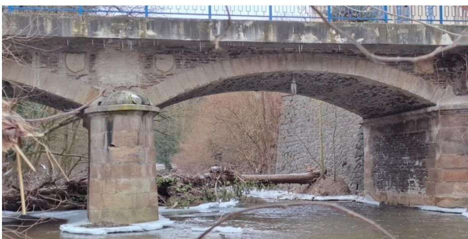
Obr 11: Most ev.č. 337-011 – nefunkční izolační systém
