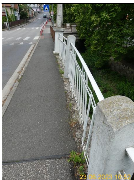
Deformované pravé zábradlí
