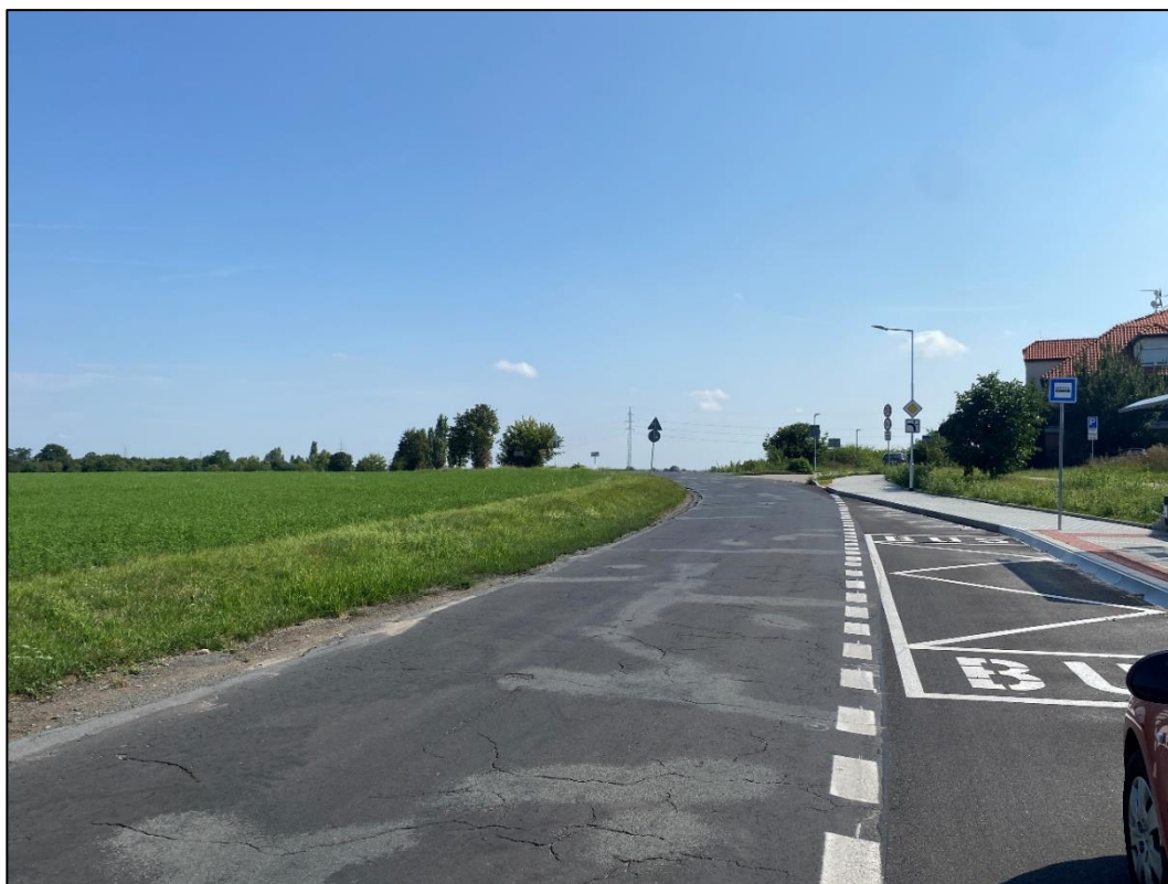
Foto 3: Silnice III/24015 v místní části Kozinec
