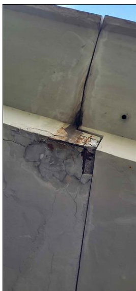
Ozub 4 - detail poškození
