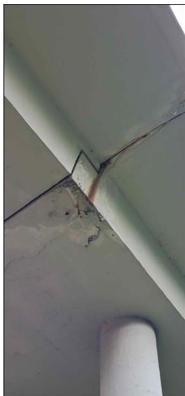
Ozub 4 - detail poškození
