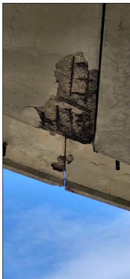
Ozub 3 - odpadlý beton
