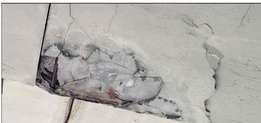
Ozub 4 - detail poškození
