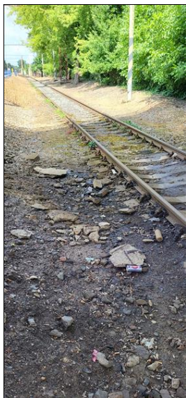
Odpadlý beton v kolejišti pod ozubem 3 na vnější straně
