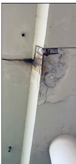
Ozub 4 - detail poškození
