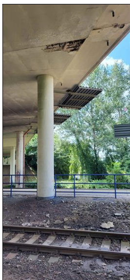
Ozub 3 - odpadlý materiál pod nosnou konstrukcí
