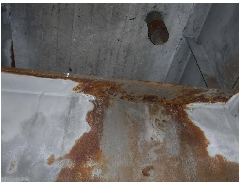
Obrázek č. 29: Koroze příčnicku při zkušebním místě č. 2 způsobená svodem vody z odvodňovače přímo na nosníky NK
