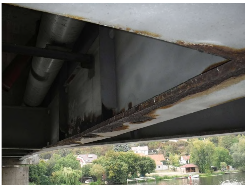
Obrázek č. 30: Koroze nosíku při zkušebním místě č. 3
