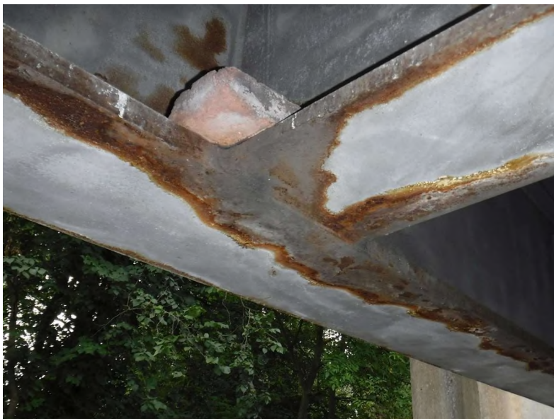
Obrázek č. 28: Koroze nosíku a příčnicku při zkušebním místě č. 1
