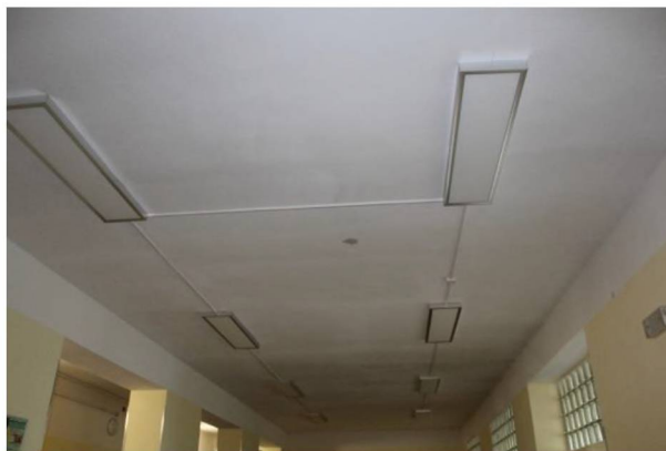
Obrázek 4 - LED osvětlení chodba
