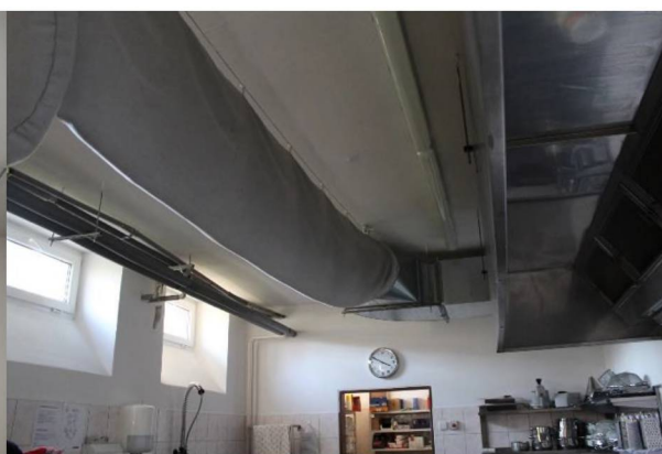
Obrázek 60 - Vzduchovod v kuchyni
