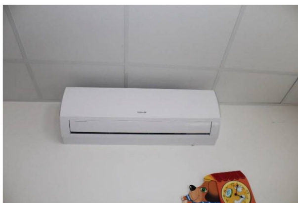
Obrázek 59 - Klimatizační jednotka v ložnici dětí
