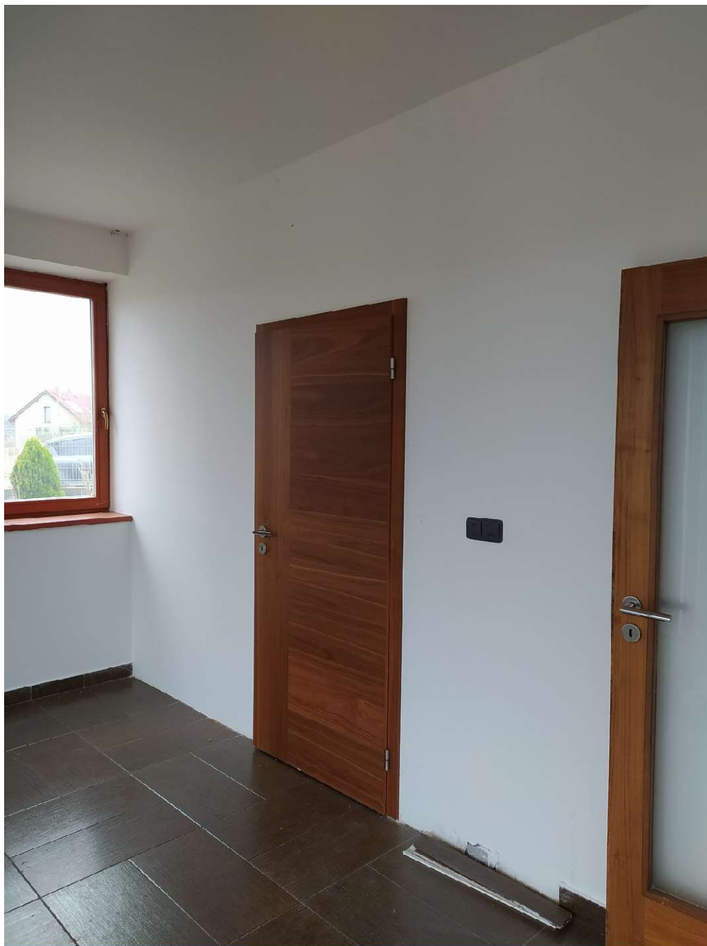
pohled na příčku z m. č. 1.04
