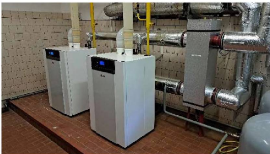
Plynové kotle v objektu Domov mládeže
