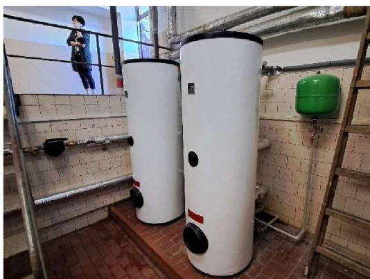
Ohřev TV v objektu Domov mládeže
