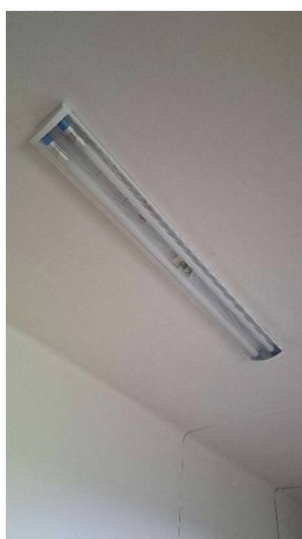
Osvětlení v objektu Domov mládeže
