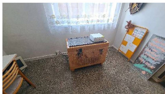
Elektrické akumulční topidlo v objektu Cukrářských dílen
