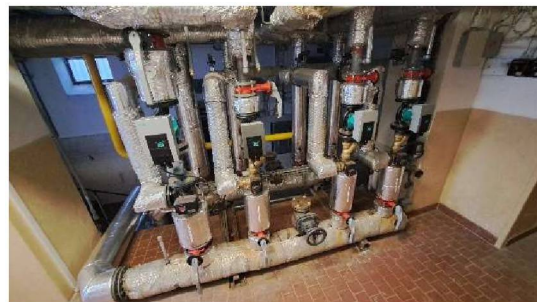
Rozdělovač/sběrač v objektu Domov mládeže
