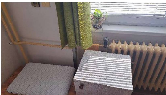
Otopné těleso s ručním ventilem v objektu Domov mládeže
