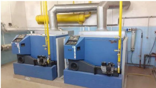
Kotle v centrální kotelně
