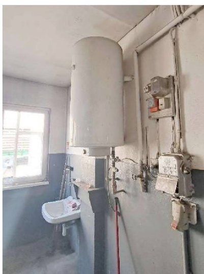
Ohřev TV v objektu Dílny opravářů
