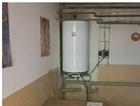
Ohřev TV v objektu Domov mládeže
