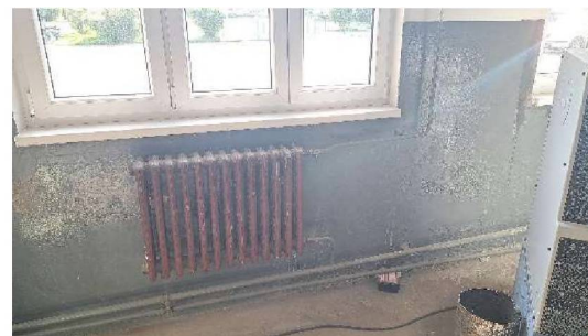
Otopné těleso s ručním ventilem v objektu Dílen opravářů
