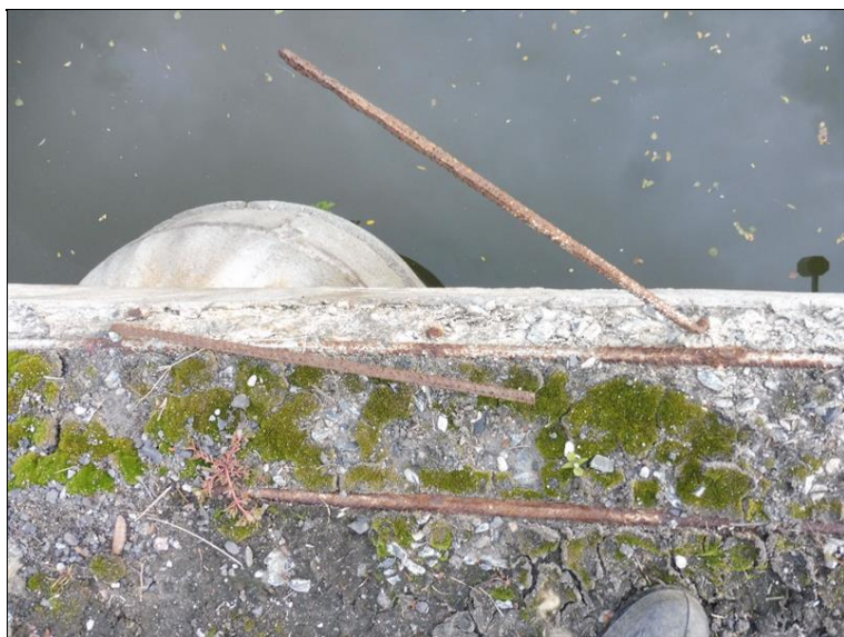
Obnažená výztuž římsy v P.
