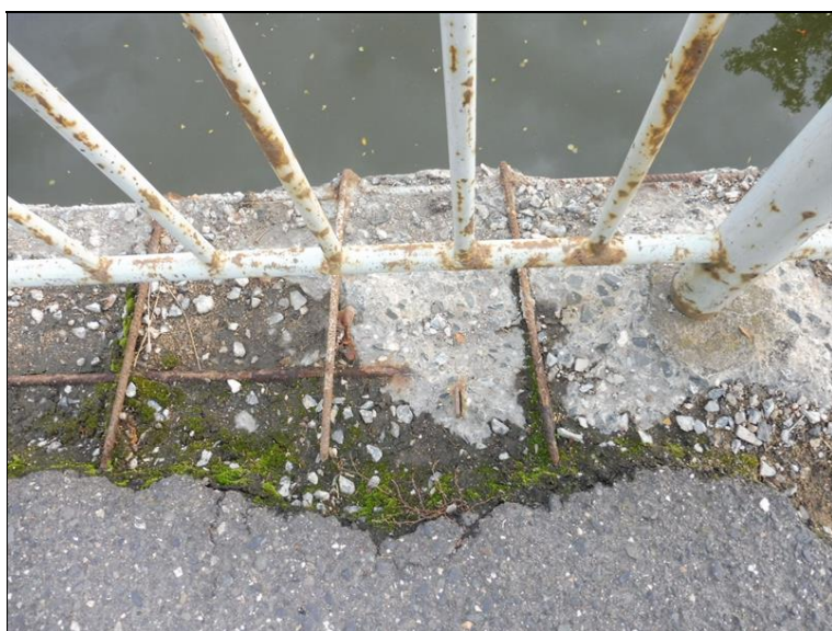
Obnažená výztuž římsy v P.
