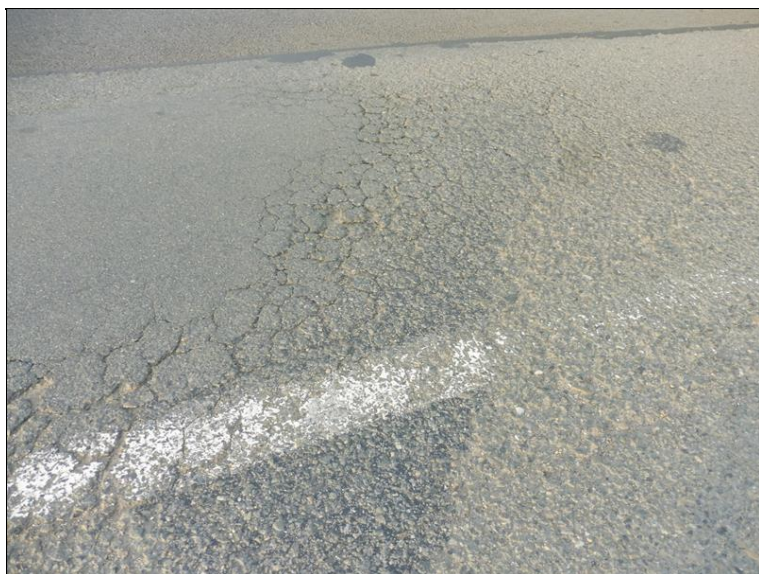
Kerný rozpad vozovky.
