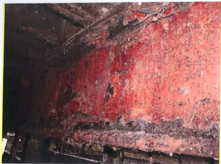
Stav ocelových I-profilů
