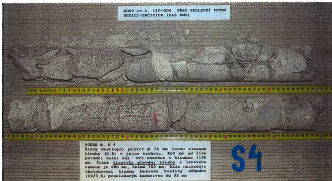
Obr. E17-01: SONDA č. S4. Šikmý dostropní průvrt Ø 75 mm levou stranou klenby (Č.3) v jejím vrcholu, 850 mm od líce povodní čelní zdi. Vrt ukončen v hloubce 1180 mm. Šikmá tloušťka původní klenby z lomového kamene je 880 mm, kolmá 700 mm. Dále následuje obetonování klenby betonem kvality odhadem (C3/3,5) prokládaným kamenivem do 55 mm.
