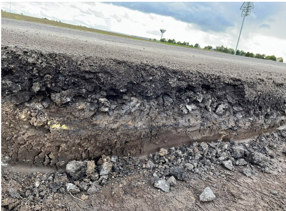
Obrázek 1 Pohled na část vozovky, která měla být zahována
