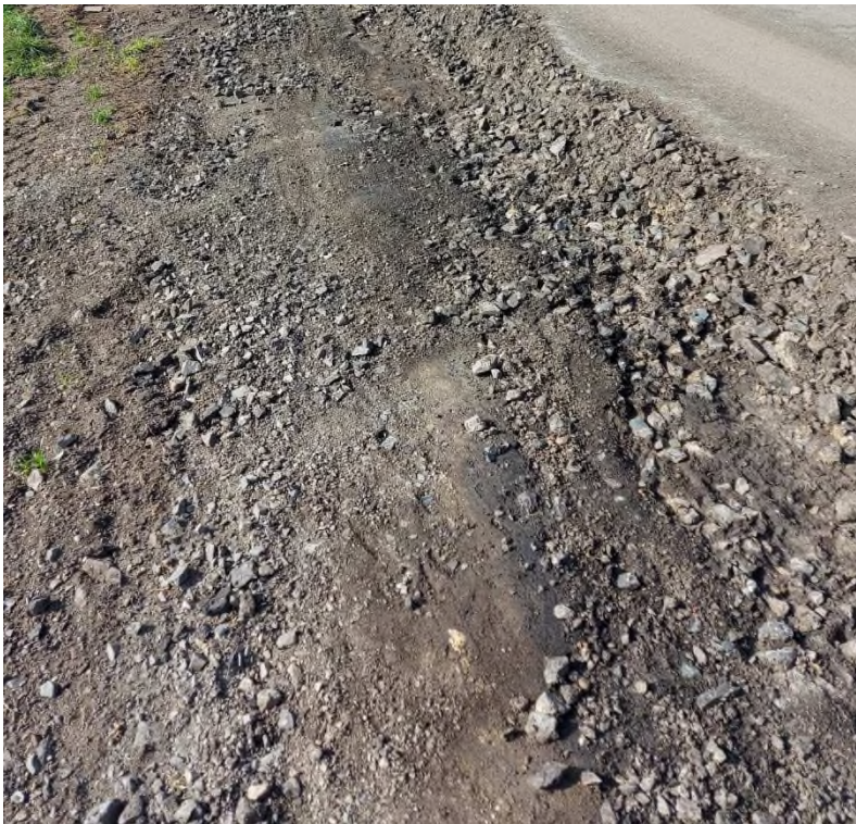
Obrázek č. 1: Pohled na odhalený kraj vozovky
