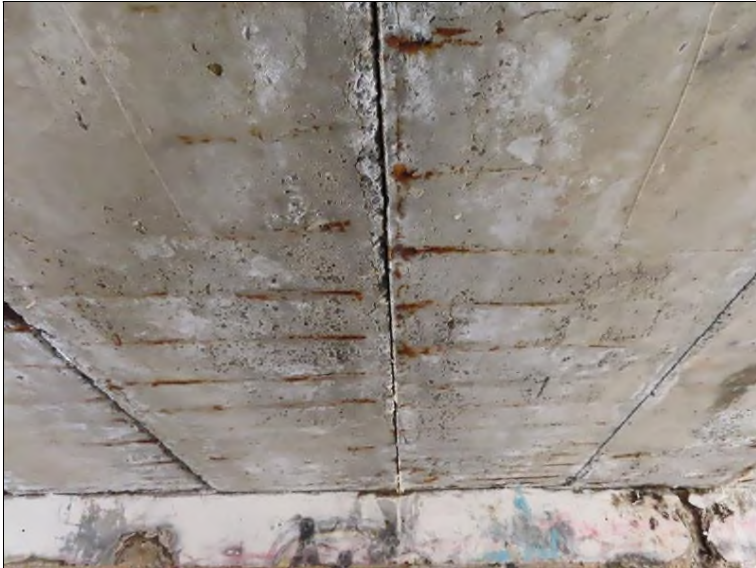
Pohled směrem k OP1 zleva 11-12. nosník - stopy po průsacích spárou mezi nosníky Rezavé výluhy v poloze třmínků
