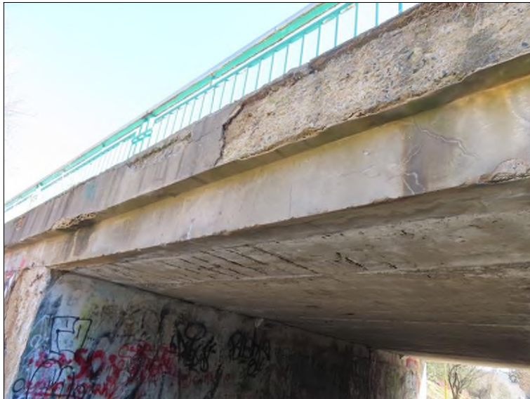
Pohled na bok 21. nosníku zprava od OP2 Projevy zatékání pod římsou Římsa -plošné odpadnutí omítky, separace
