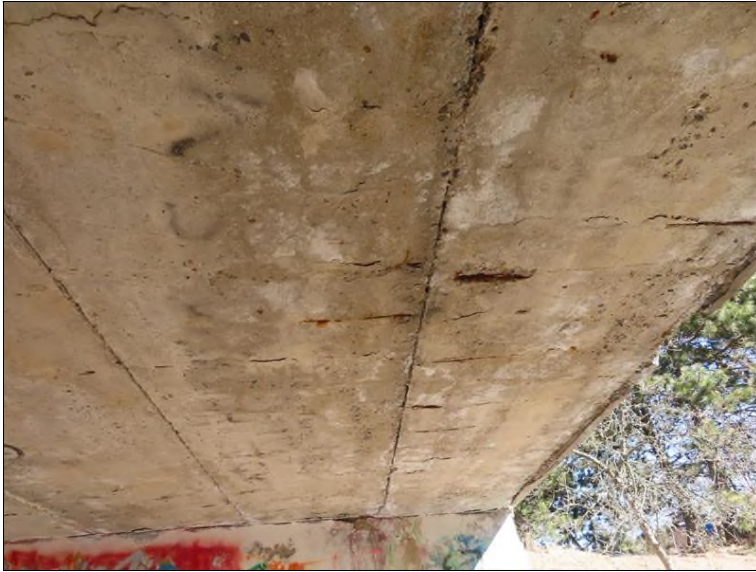
Pohled směrem k OP1 zleva Projevy zatékání spárou mezi 1-2. nosníkem a pod římsou Separace dobetonánky líc 1. nosníku
