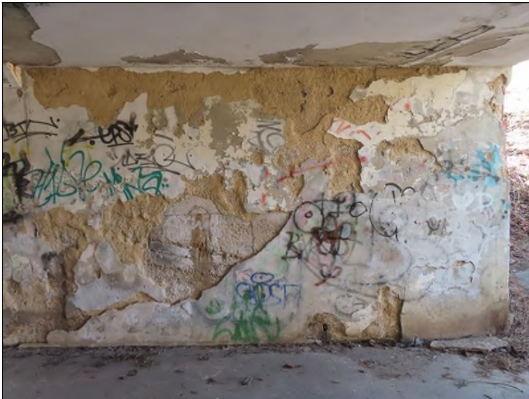
Pohled na OP2 PS Pod 16-18. nosníkem Hlubková degradace omítky, obnažen nekvalitní beton opěry
