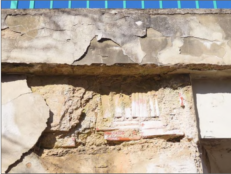
Pohled na OP2 a křídlo zleva Nekvalitně provedené dozdění boku nosníku Římsa - trhliny v omítce
