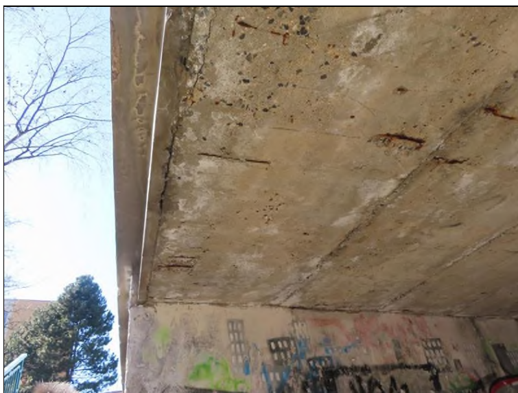
Pohled na OP2 zleva Projevy zatékání spárkou pod římsou a mezi 1-2. nosníkem do spodního líce, separace odpadnutí krycí vrstvy Obnažená výztuž třmenů
