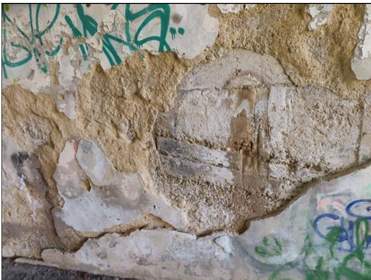
Pohled na OP2 PS Pod 16-18. nosníkem Hlubková degradace omítky, obnažen nekvalitní beton opěry, otevřené pracovní spáry
