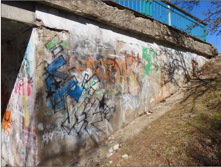
Pohled na OP1 a křídlo zleva Trhliny a separace omítky Nekvalitní dozvěnění boku nosníku
