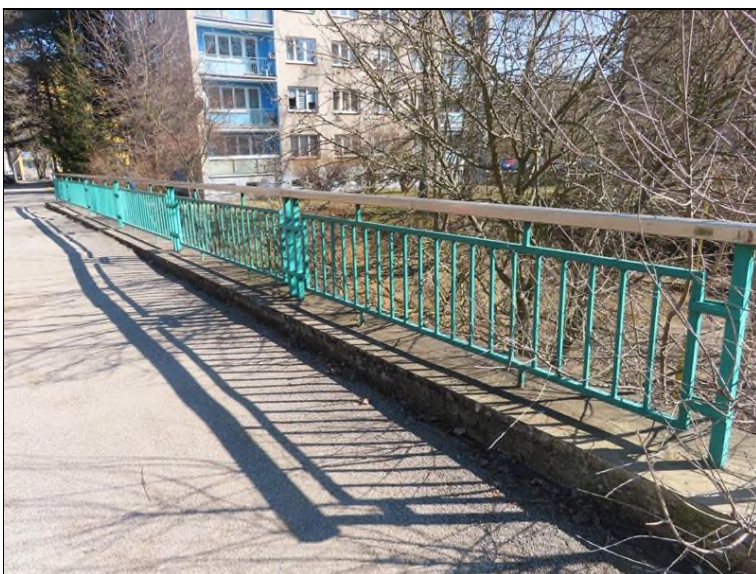
Levá strana podél křídla OP2 Chodník - trhliny a pokles Zábradlí
