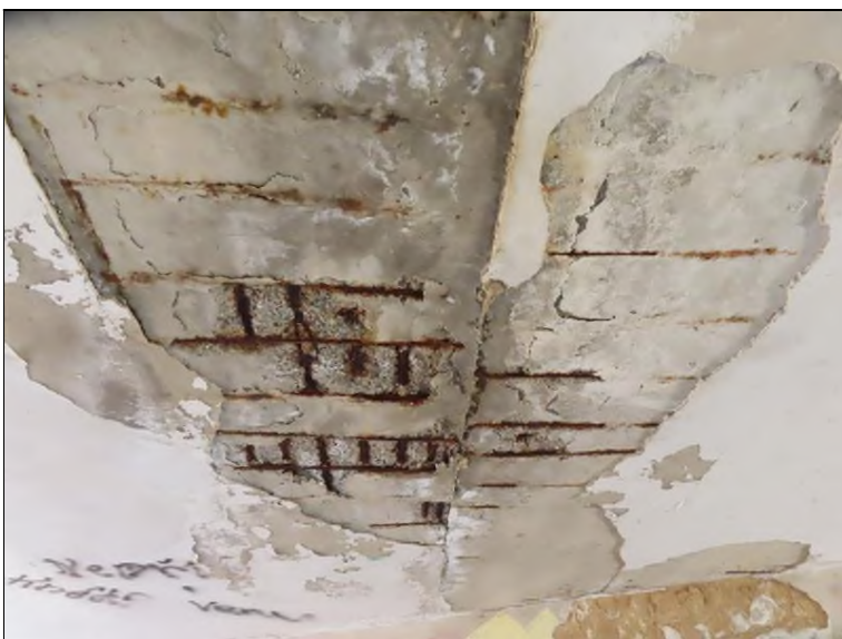
Pohled od OP2 PS na 15. nosník Zatékání spárou mezi 14-15. nosníkem Plošné odpadnutí omítky a krycí vrstvy, její separace Obnažení 7 prutů hlavní výztuž- silná koroze s oslabením
