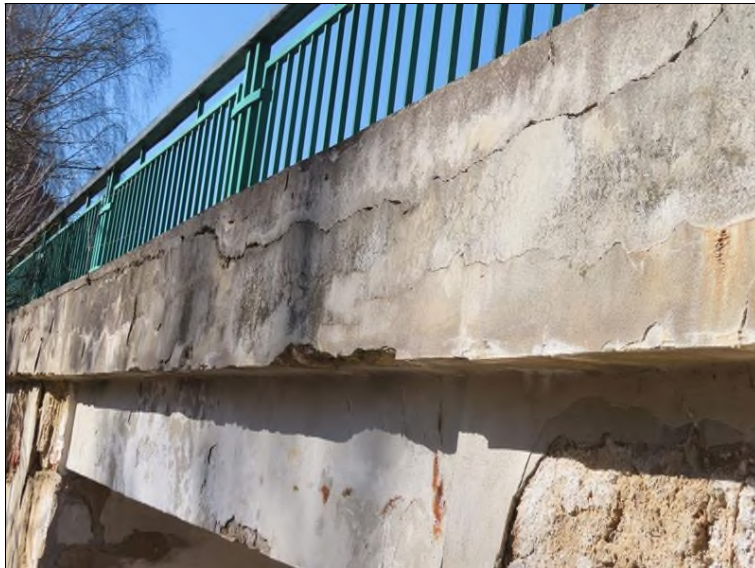
Pohled na most zleva od OP1 Krajní nosník a římsa Separace omítky a dobetonávky
