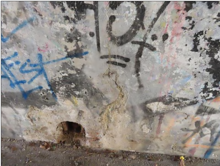
Pohled směrem k OP2 zleva Svislá trhлина Odvodnění rubu opěry -
