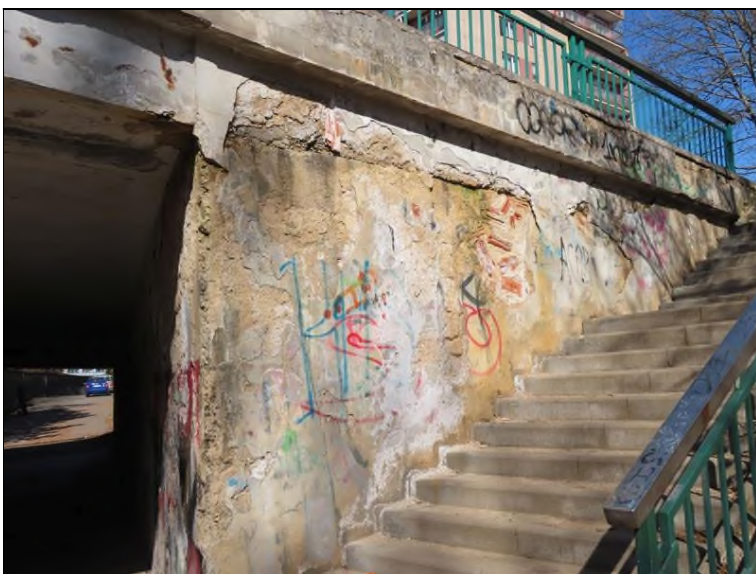
Pohled na OP1 a křídlo zleva Plošné odpadnutí omítky, místy separace
