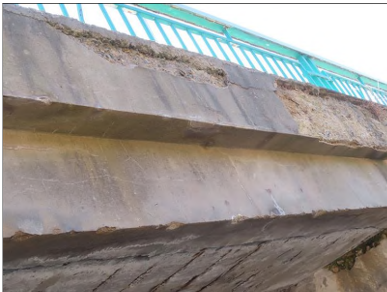
Pohled na bok 21. nosníku zprava od OP1 Římsa -separace a plošné odpadnutí omítky, oddělení nadbetonávky
