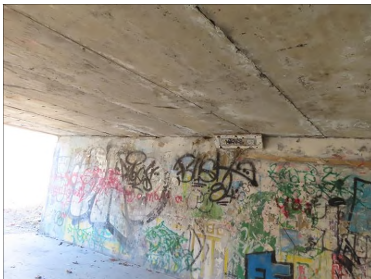
Pohled směrem k OP1 PS 15.-21. nosník - stopy po průsacích spárou mezi nosníky
