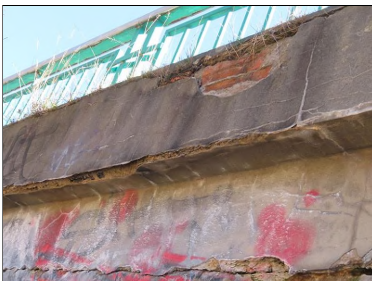
Pohled nad OP1 a křídlo zprava Římsa - rozpad
