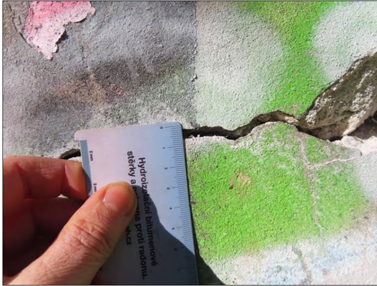
Pohled na OP2 a křídlo zleva Horizontální trhlina v omítce u svislé hrany š. 4-5 mm
