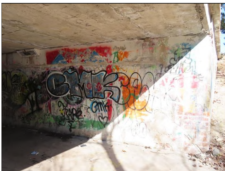
Pohled na OP1 zleva Projevy zatékání spárou na líc opěry pod 1-2. nosníkem
