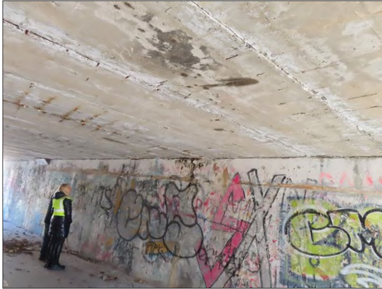
Pohled směrem k OP1 zleva 8. nosník - stopy po průsacích Zatékání spárami mezi nosníky
