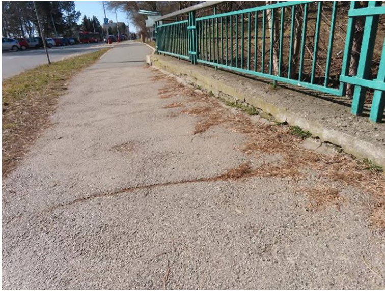
Pravá strana za OP2 Chodník - trhliny a pokles
