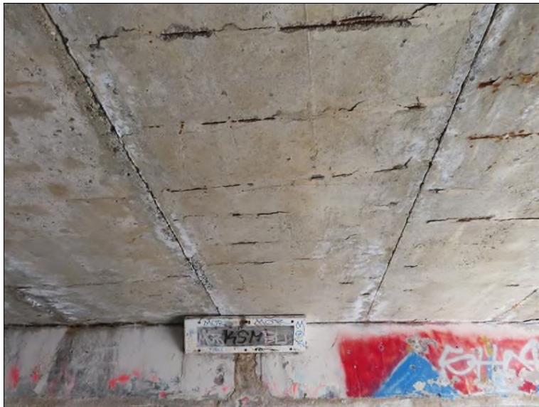
Pohled směrem k OP1 zleva 5. nosník - separace krycí vrstvy nad třmeny
