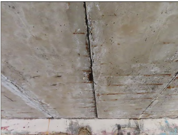
Pohled směrem k OP1 zleva 12-13. nosník - stopy po průsacích spárou mezi nosníky Rezavé výluhy v poloze třmínků
