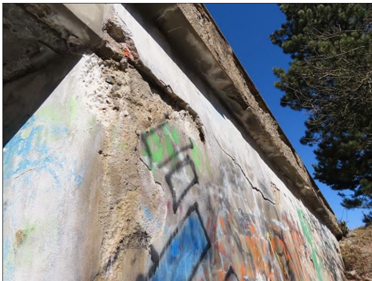
Pohled na OP1 a křídlo zleva Trhliny a separace omítky Nekvalitní dozvěnění boku nosníku
