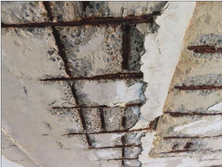
Pohled od OP1 PS na 18. nosník Plošné odpadnutí omítky a krycí vrstvy, její separace Obnažení 3 prutů hlavní výztuže- silná koroze s oslabením
