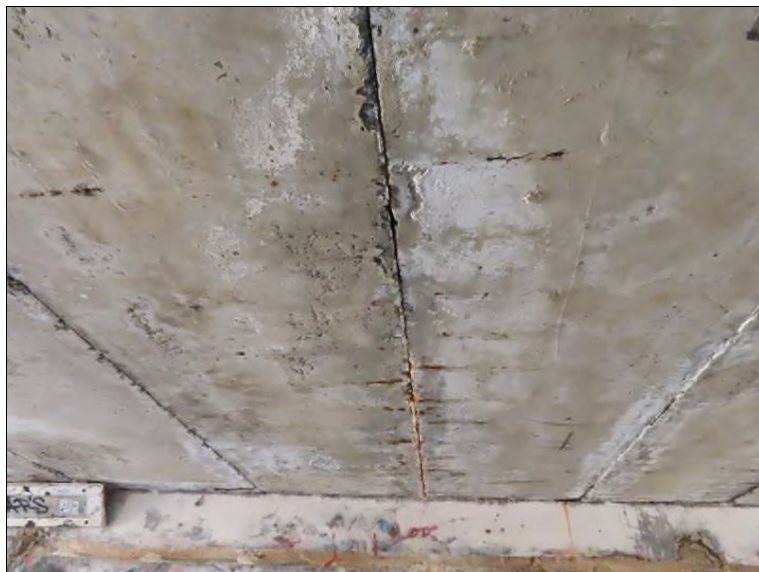
Pohled směrem k OP1 PS 14-15. nosník - stopy po průsacích spárou mezi nosníky
