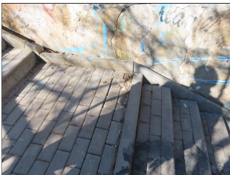
Pohled před křídlo OP2 zleva Přístupové schodiště - pokles podesty
