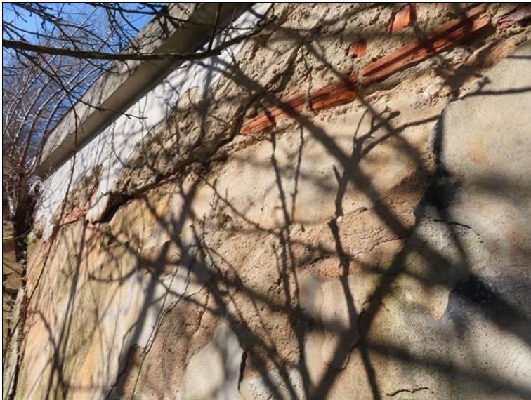
Pohled na OP2 a křídlo zleva Nekvalitně provedené dozdění horní části křídla
