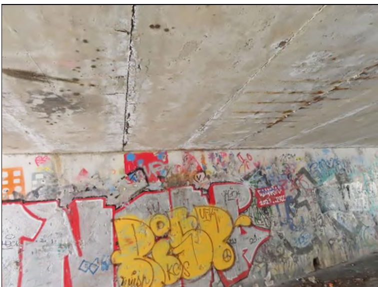
Pohled směrem k OP2 zleva 8-9 nosník - separace krycí vrstvy
