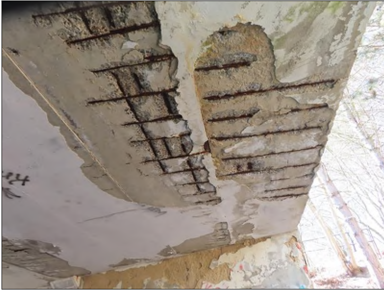
Pohled od OP1 PS na 18 a 19. nosník Zatékání spárou mezi 18-19.nosníkem Plošné odpadnutí omítky a krycí vrstvy, její separace Obnažení 3 prutů hlavní výztuže- silná koroze s oslabením
