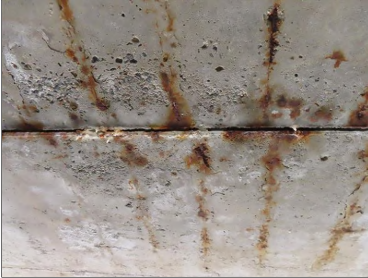
Pohled na spodní líc NK 9-10. nosník - průsaky spárou mezi nosníky - krápníky Rezavé výluhy v poloze třmínků
