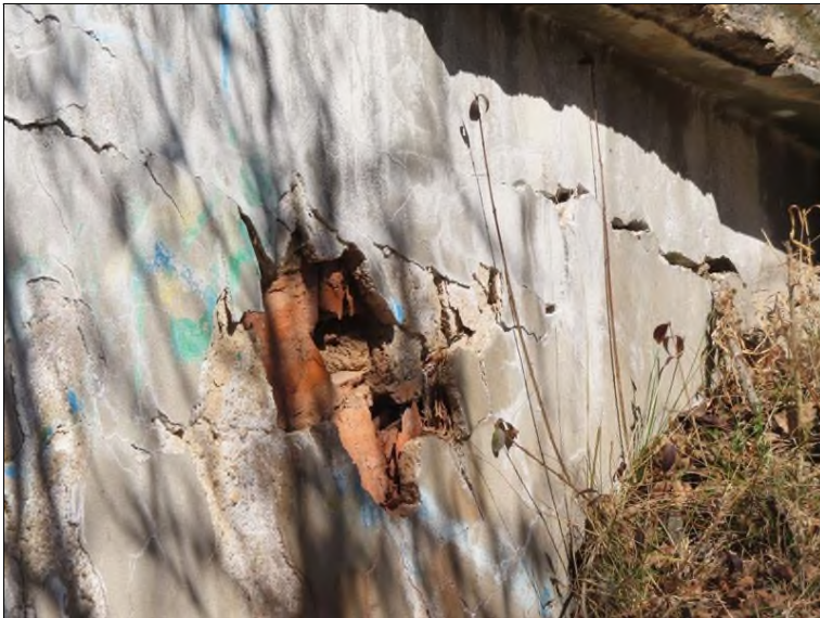
Pohled na křídlo OP1 zleva Konec křídla - hloubkový rozpad
