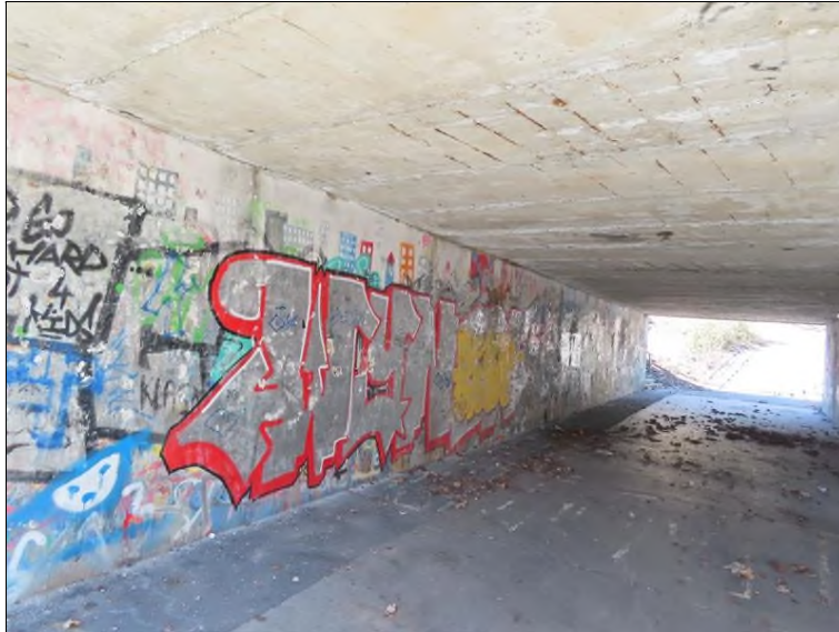
Pohled na OP2 zleva a do mostního otvoru Spodní líc nosníků- obnažení korodující výztuže
