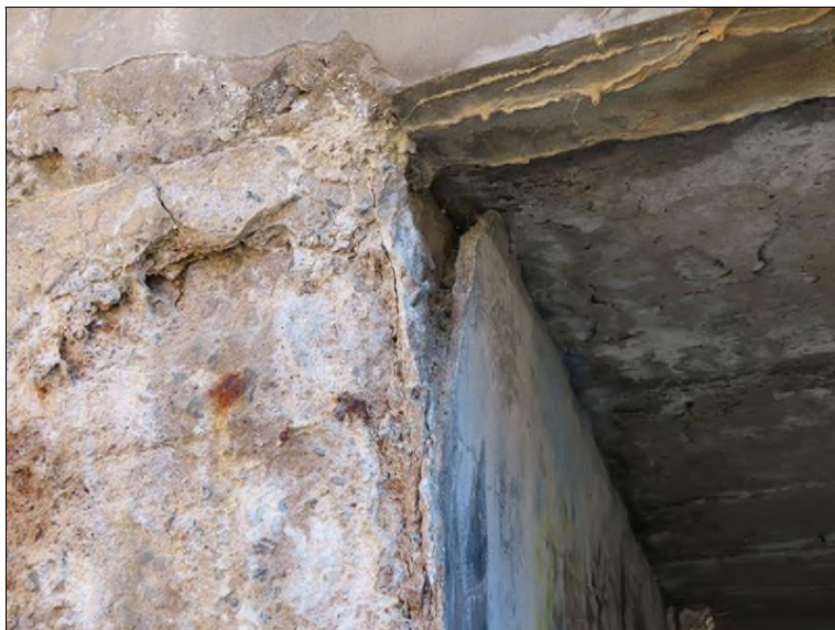
Pohled na OP1 a křídlo zprava Plošné odpadnutí omítky, místy obnažená výztuž
