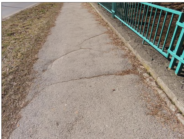
Pravá strana před OP1 Chodník - trhliny a pokles
