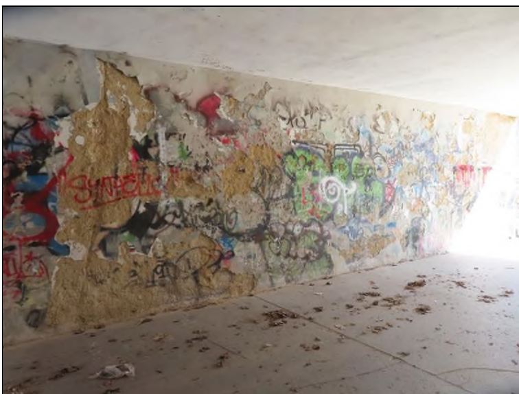
Pohled na OP1 LS Hlubková degradace omítky,
