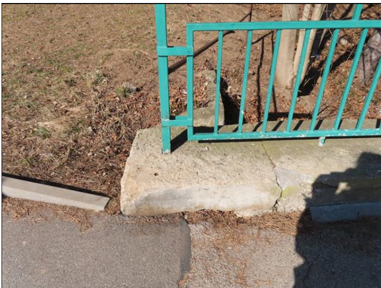
Pravá strana za OP2 Římsa - utržený konec
