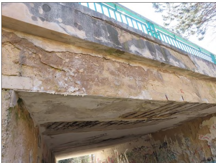
Pohled na bok 19. nosníku zprava od OP1 Projevy zatékání pod římsou Plošné odpadnutí omítky, separace Římsa - oddělení nadbetonávky
