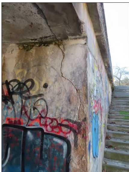
Pohled na OP2 PS Utržená rohová část pod debetonávkou čela 21. nosníku
