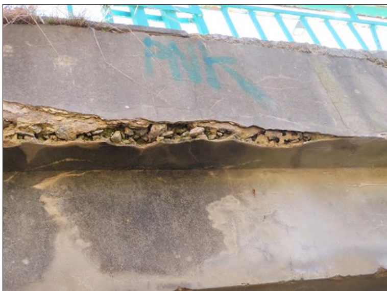
Pohled nad bok 21. nosníku zprava od OP21 Římsa -rozpad hrany
