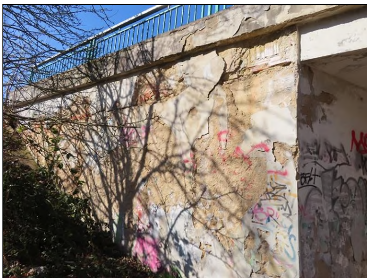
Pohled na OP2 a křídlo zleva Nekvalitně provedené dozdění boku nosníku a horní části křídla Separace omítky
