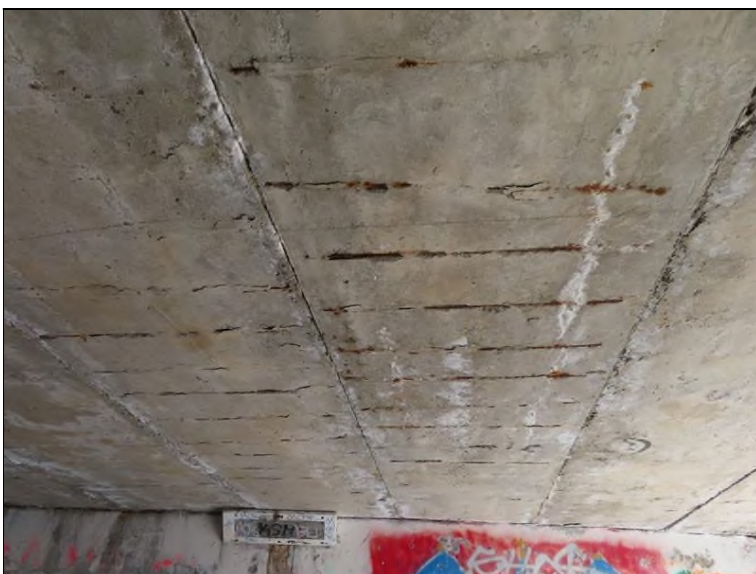
Pohled směrem k OP1 zleva 4. nosník - trhliny s výluhy v linii hlavní výztuže Zatékání spárou mezi 4-5. nosníkem
