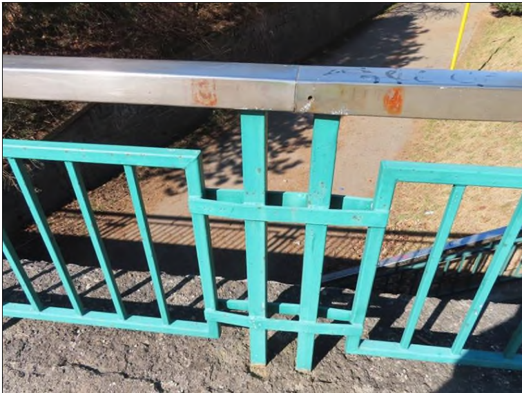
Pravá strana Zábradlí - koroze sloupků ve vetknutí
