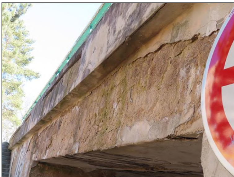
Pohled na bok 19. nosníku zprava od OP2 Projevy zatékání pod římsou Plošné odpadnutí omítky, separace
