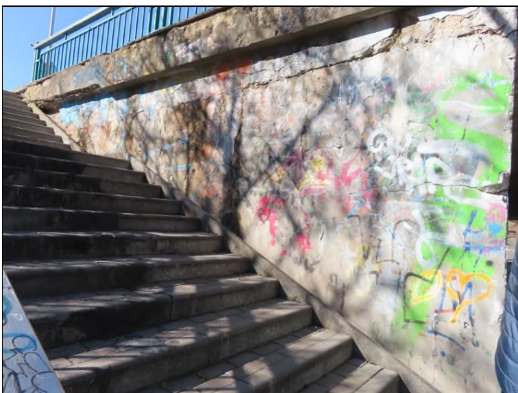
Pohled na OP2 a křídlo zleva Otevřená horizontální pracovní spára s projevy zatékání, separace a odpadnutí omítky
