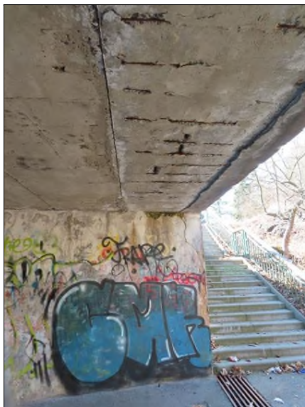
Pohled směrem k OP2 PS 21. nosník - separace a odpadnutí krycí vrstvy
