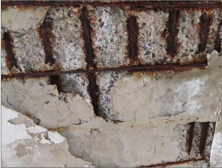
Pohled od OP2 PS na 15. nosník Plošné odpadnutí omítky a krycí vrstvy, její separace Obnažení 7 prutů hlavní výztuže- silná koroze s oslabením Silné oslabení třmenu
