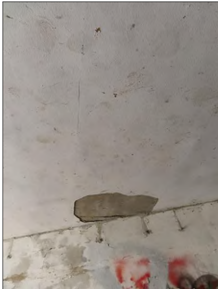
Pohled zleva od OP1 na 9. nosník Plošné odpadnutí omítky a její separace Trhlina ve spáře mezi nosníky
