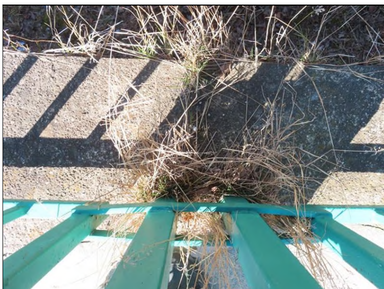
Pravá strana Zábradlí- zarostlé kotvení Římsa - příčná trhlina
