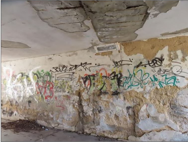
Pohled na OP2 PS Pod 14-15. nosníkem Hlubková degradace omítky
