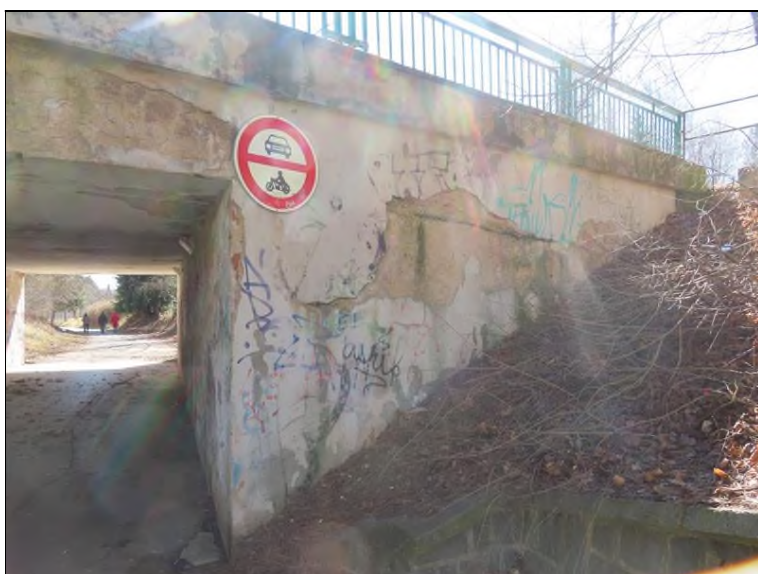
Pohled na OP2 a křídlo zprava Projevy zatékání horizontální pracovní spárou
