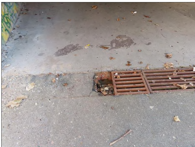
Pohled na zprava Příčný odvodňovací žlab - chybí mříž
