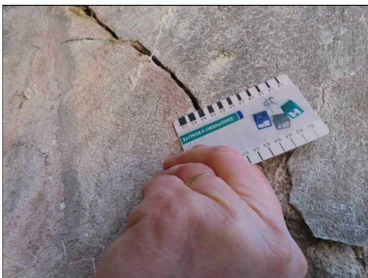
Pohled na OP2 PS Utržená rohová část pod debetonávkou čela 21. nosníku š.- trhliny 4 mm
