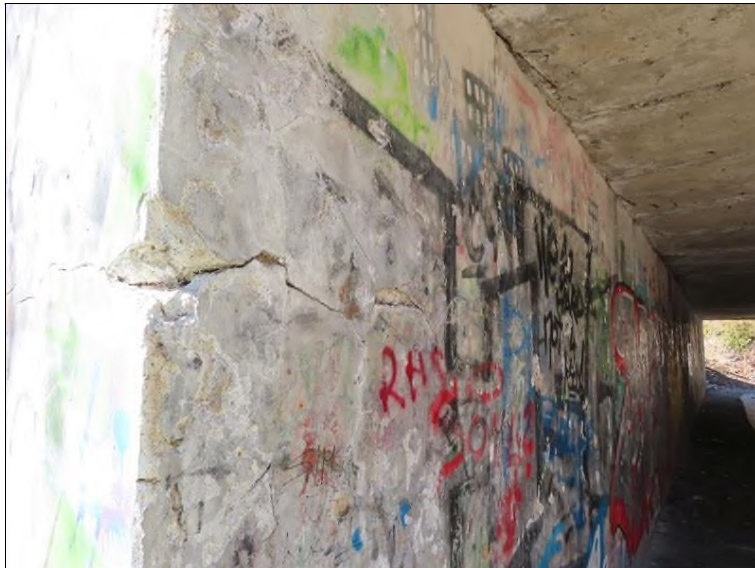
Pohled na OP2 a křídlo zleva Horizontální trhlina v omítce v betonu
