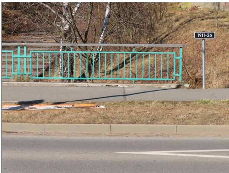
Pohled nad křídlo OP1 zprava Pokles přechodové oblasti
