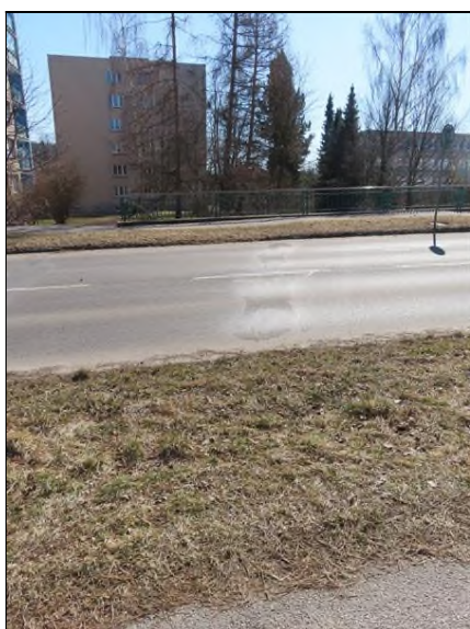
Pohled zprava nad OP1 Vozovka - příčné trhliny, z části zalité
