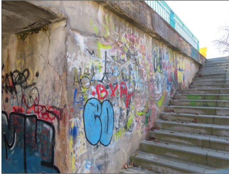
Pohled na OP2 a křídlo PS Trhliny v sanaci
