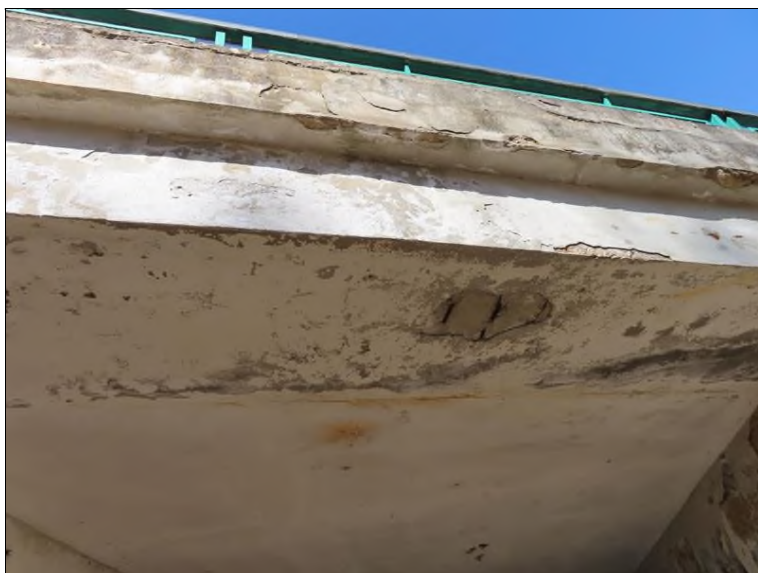
Pohled zleva od OP2 na 1. nosník Projevy zatékání spárou mezi 1-2. nosníkem do spodního líce, separace, odpadnutí omítky
