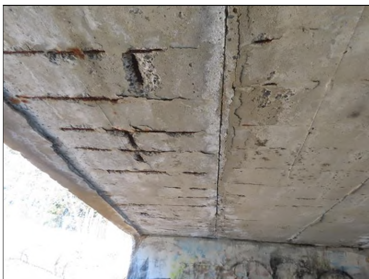
Pohled směrem k OP1 PS 21. nosník - separace a odpadnutí krycí vrstvy Obnažená hlavní výztuž
