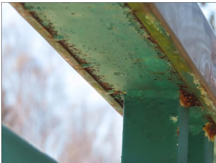
Pohled zprava Zábradlí - koroze madla
