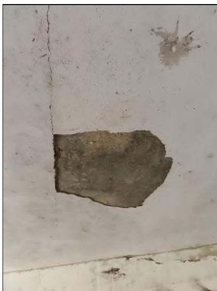
Pohled zleva od OP1 na 12. nosník Plošné odpadnutí omítky a její separace Trhlina ve spáře mezi nosníky
