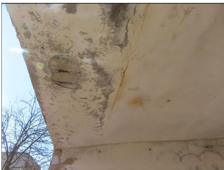
Pohled zleva od OP1 na 1. nosník Projevy zatékání spárou mezi 1-2. nosníkem do spodního líce, separace, odpadnutí omítky
