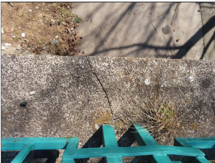
Levá strana Římsa - utržení horní dobetonávky
