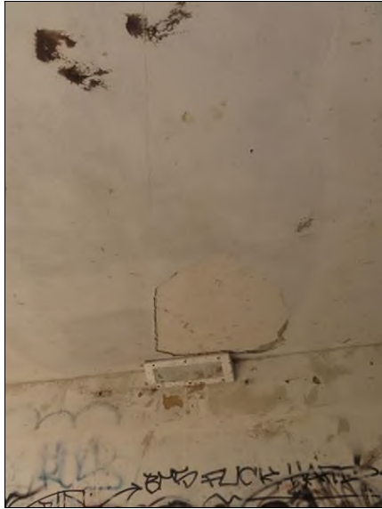
Pohled zleva od OP1 na 5. nosník Plošné odpadnutí omítky a její separace Trhlina ve spáře mezi nosníky
