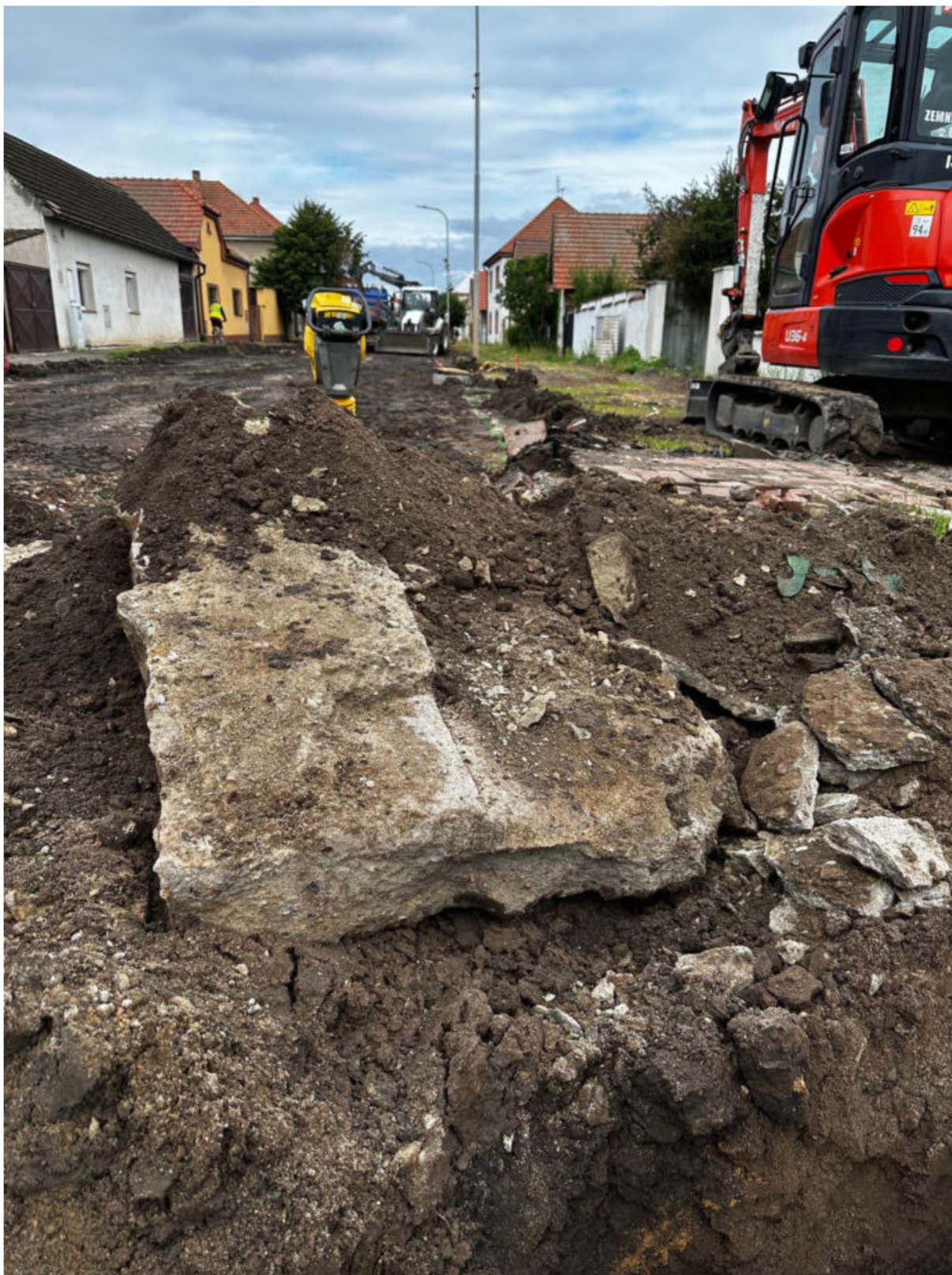
Příloha č.1 - fotodokumentace o výskytu betonů v místě drenáží ze dne 02. 08. 2023
