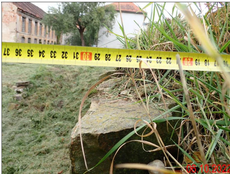
1.2 Opěrná zeď u opěry O3 vlevo - vykloněná.JPG
