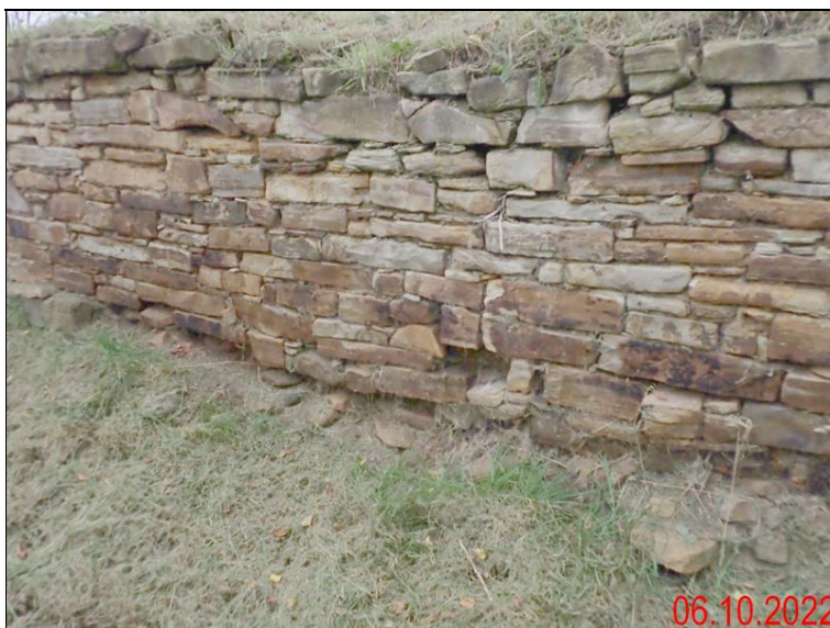
1.2 Opěrná zeď u opěry O3 vlevo - vypadané kameny_1.JPG
