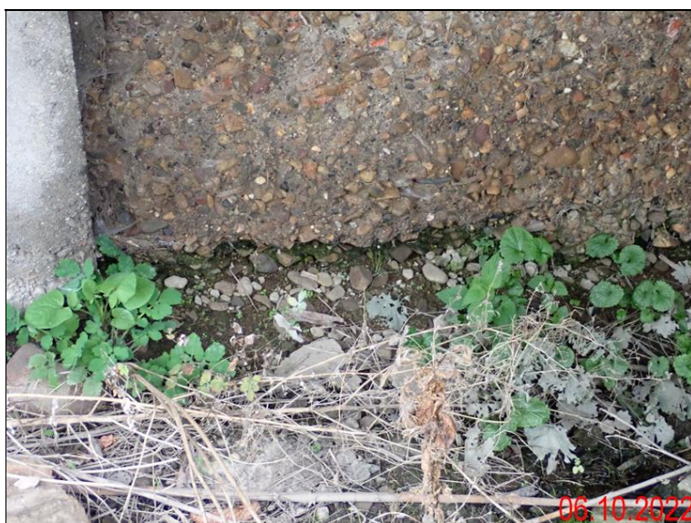
1.2 Opěra O1 - beton v patě vymletý.JPG
