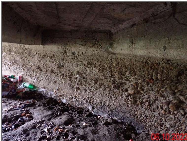
1.2 Opěra O2 - vymletý povrch betonu.JPG
