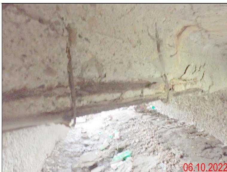
2.1 Nosná konstrukce - odpadlý beton a koroze výztuže trámu_2.JPG
