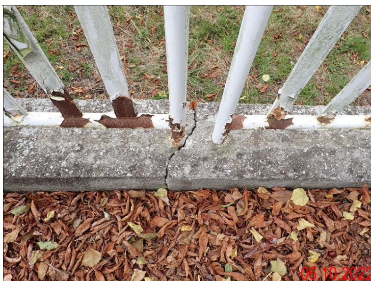
3.3 Římsa vpravo - příčná trhlina.JPG
