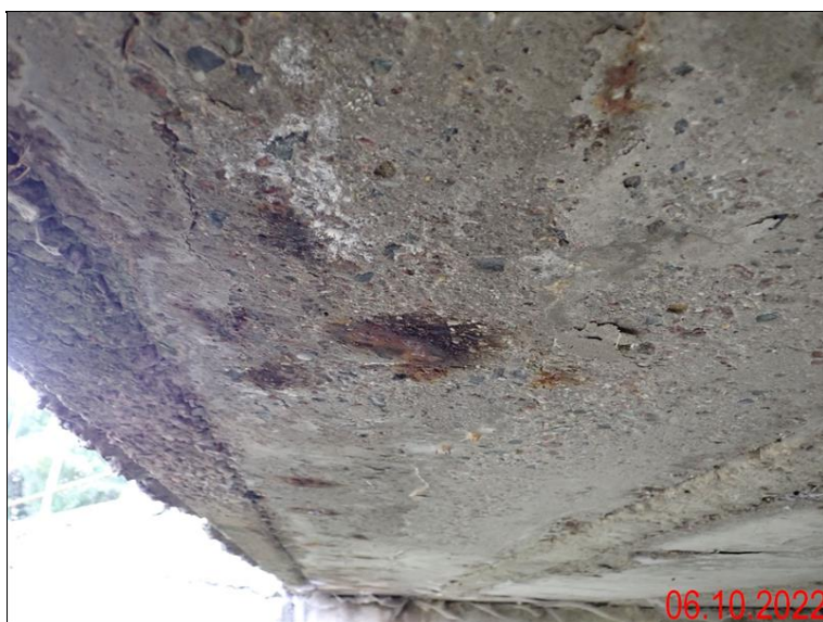
1.2 Nosná konstrukce vpravo - výluhy pojiva a koroze na podhledu.JPG
