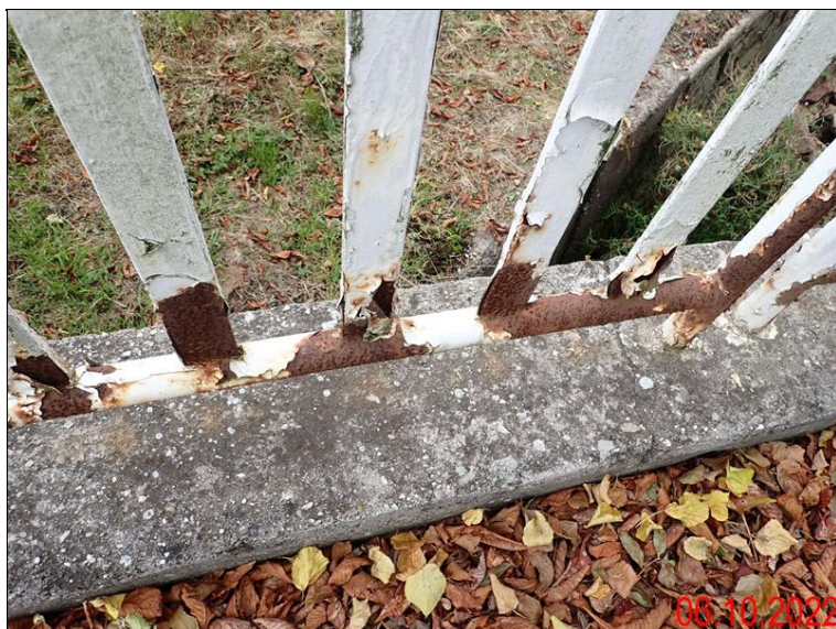
4.2 Zábradlí vpravo - koroze.JPG
