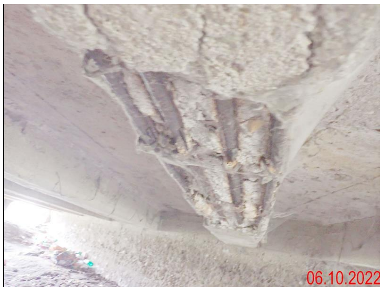
2.1 Nosná konstrukce - odpadlý beton a koroze výztuže trámu_3.JPG
