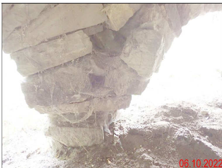
1.2 Píliř P2 - vypadlé kameny zdiva v patě.JPG
