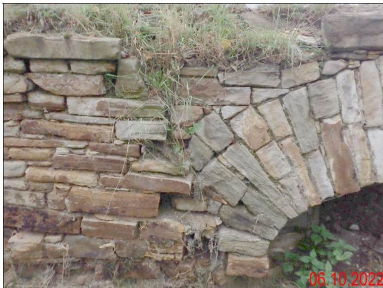
1.2 Opěrná zeď u opěry O3 vlevo - vypadané kameny_2.JPG
