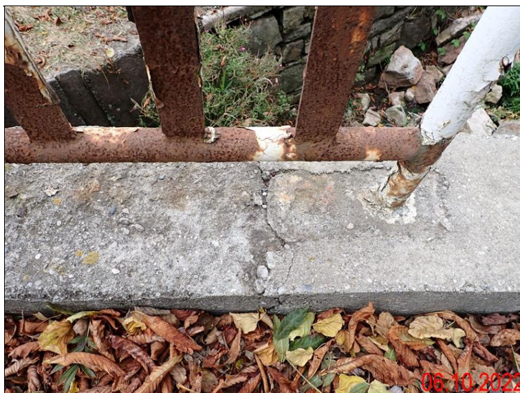
3.3 Římsa vpravo - degradovaný horní povrch.JPG
