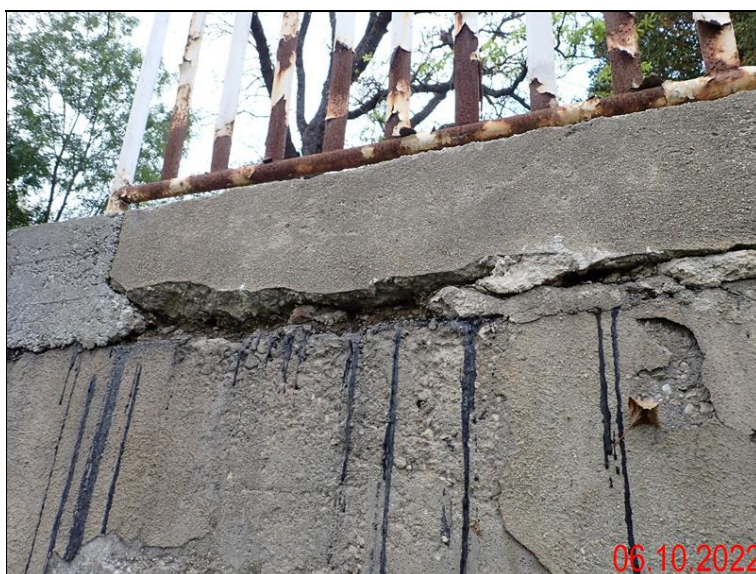
3.3 Římsa vpravo - rozpadlý beton ve spáře mezi římsou a křídlem.JPG
