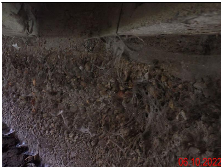
1.2 Opěry - vymletý povrch.JPG
