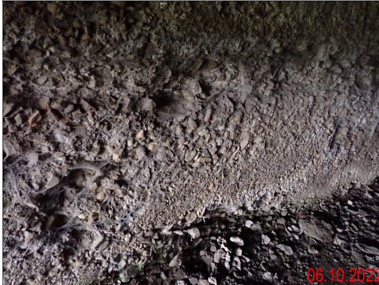
1.2 Opěra O1 - kaverna vlevo v patě.JPG
