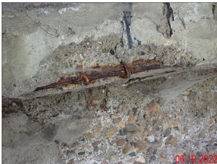
2.1 Nosná konstrukce - odpadlý beton a koroze výztuže trámu_1.JPG
