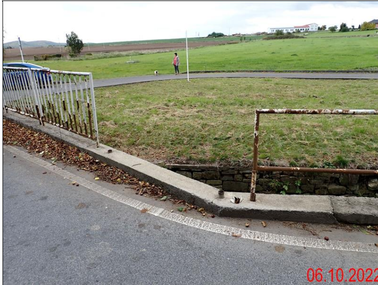
4.2 Zábradlí vpravo na mostě - první díl chybí.JPG
