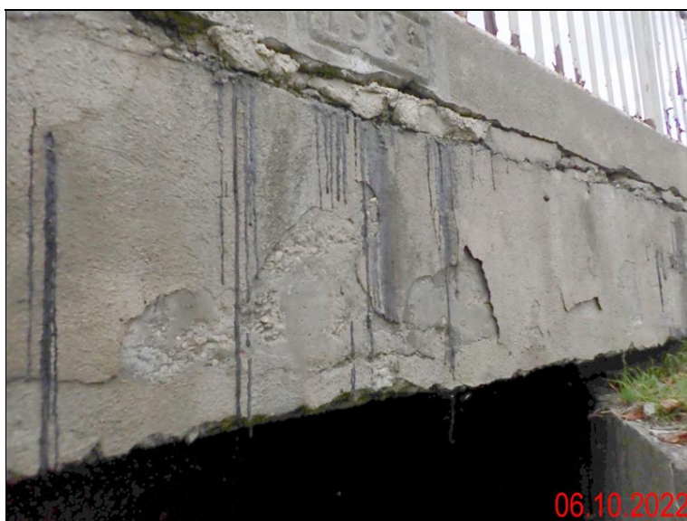
2.1 Nosná konstrukce vpravo - separovaná povrchová vrstva betonu na boku.JPG
