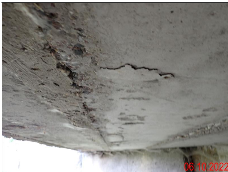
2.1 Nosná konstrukce vpravo - na podhledu separovaná krycí vrstva betonu.JPG
