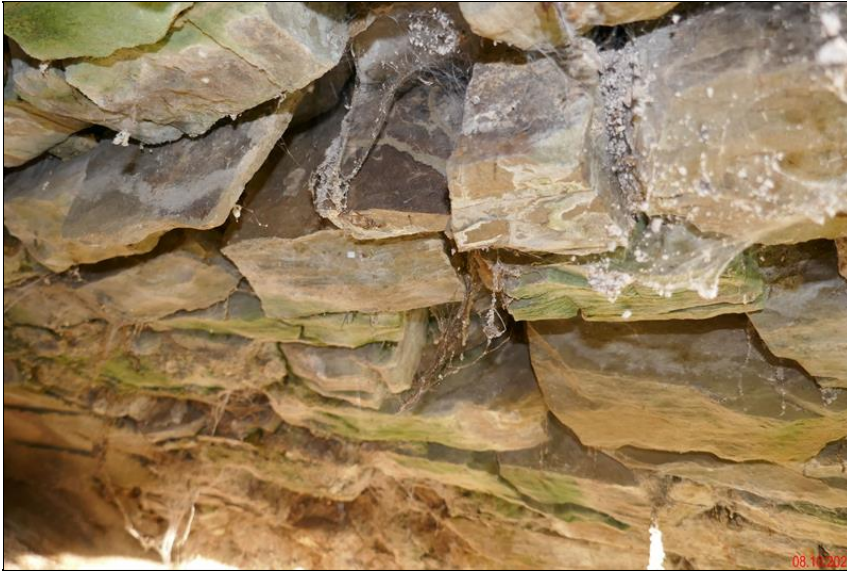
2.1 Vydrolené spárování a vypadlé kameny v klenbě vpravo_2.JPG
