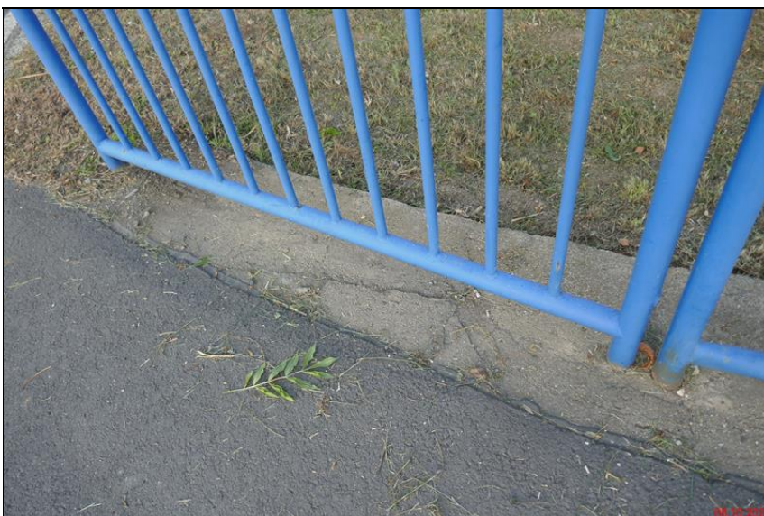
3.3.1 Degradace betonu horního povrchu levé římsy.JPG
