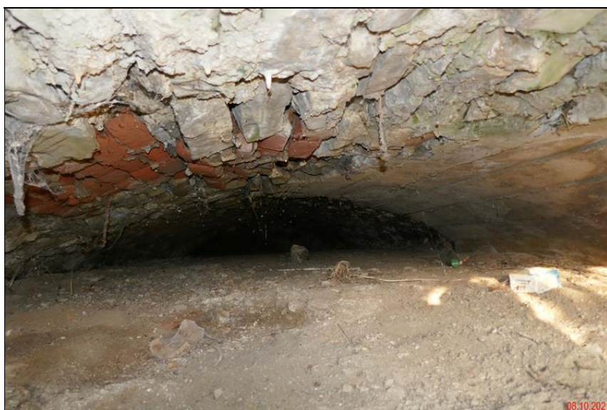
2.1 Vydrolené spárování a vypadlé kameny v klenbě vpravo_1.JPG
