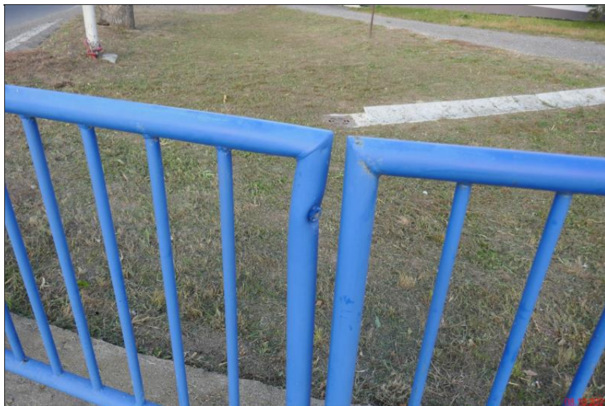
4.2 Deformace sloupku zábradlí vlevo.JPG
