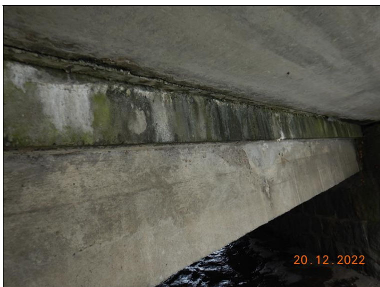
Zatékání na levý bok NK, bionapadení.
