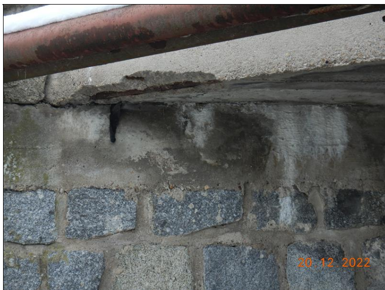
NK u OP1 vpravo - odtržení krycí vrstvy výztuže v důsledku zvětšování objemu korozních produktů výztuže.
