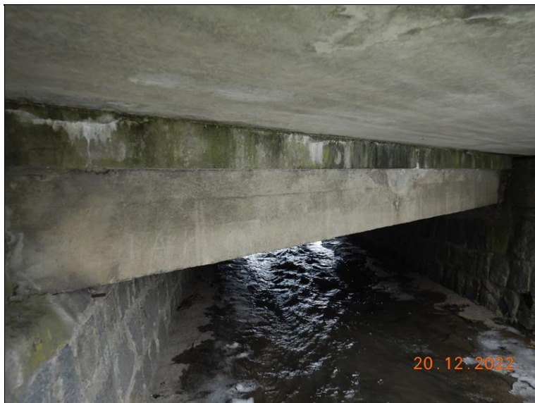
Stopy po zatékání s výluhy na levý bok NK.
