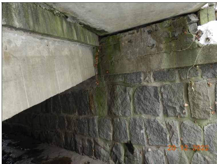
Uložení chodníku na OP1, zatékání na bok NK.
