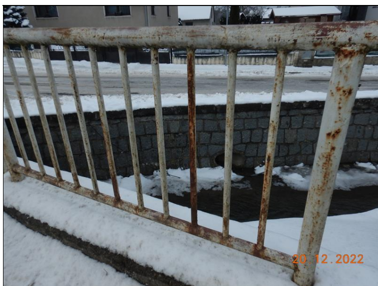
Detail zábradlí vpravo - degradace nátěru a koroze.
