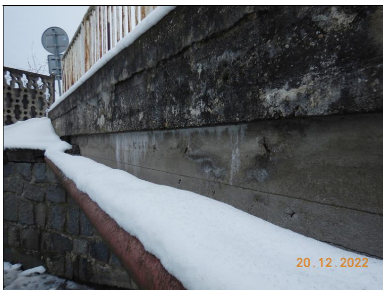
Pravý bok- průsaky s výluhy zpod římsy, lokálně obnažená výztuž NK.
