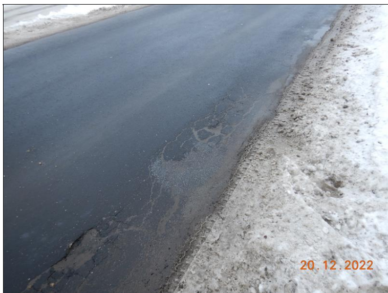
Výtluk ve vozovce.
