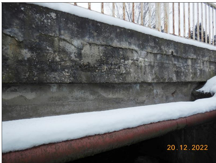
Degradace betonu pravé římsy, trhliny.
