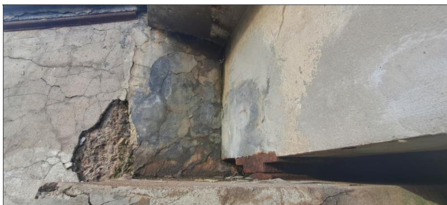
Ložisko na OP02 (LS) - koroze ložiska, potřhaná omítka zdiva a jeho rozpad
