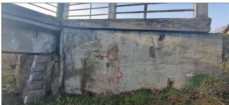
OP02, PS, křídlo - stav omítky, zdiva a řimsy
