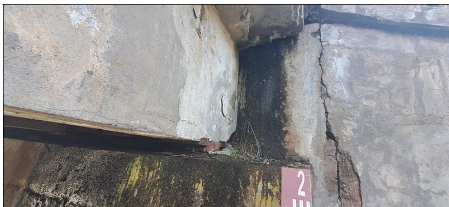
OP02, PS, dilatace - detail - průsaky, trhliny ve zdivu
