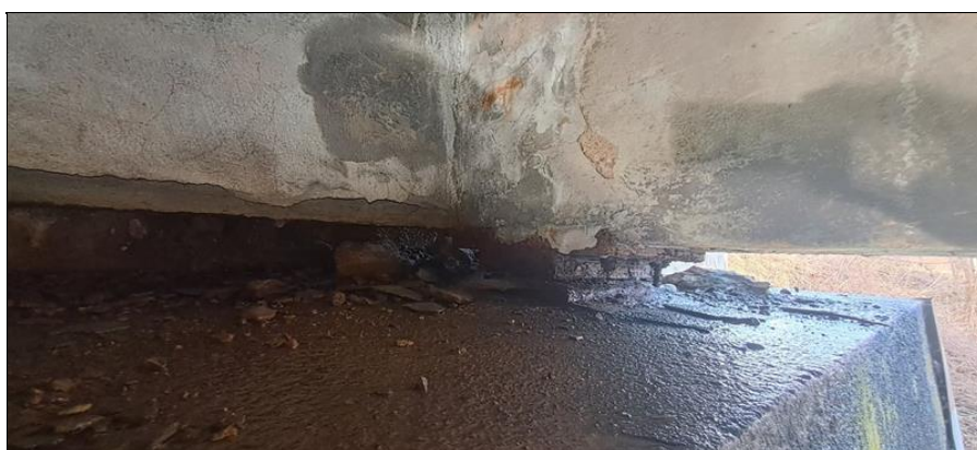
Ložisko na OP02(PS) - koroze, zatékání dilatační spárou na ul.práh
