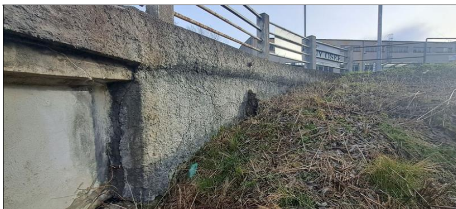
OP01, LS, křídlo - stav omítky
