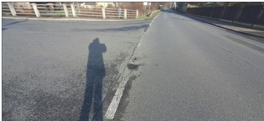
Vozovka v křižovatce - výtluk
