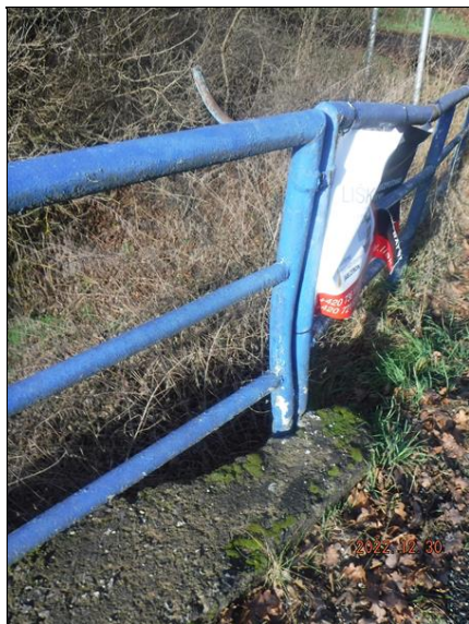
Detail silně zdeformované špatně kotveného sloupku zábradlí na pravé straně nad O1.
