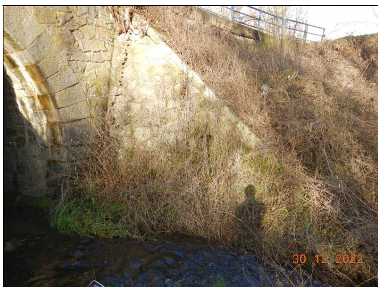
Pohled na levé křídlo opěry O1, silně zarostlé vegetací.
