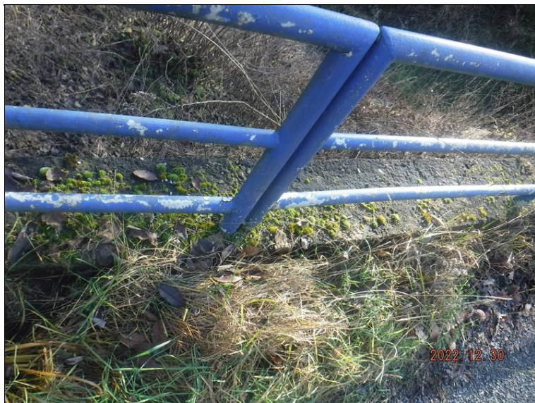
Na zábradlí jsou časté lokální poruchy PKO.
