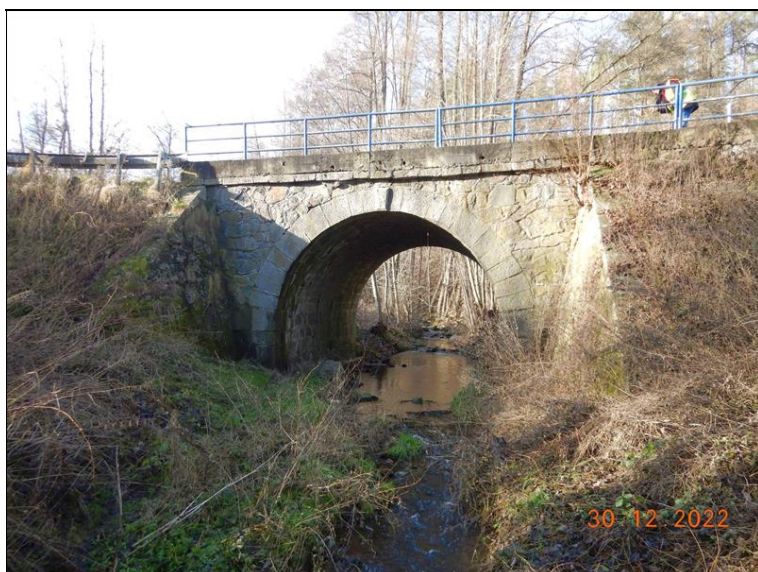
Celkový pohled zleva. Degradace betonu římsy.
