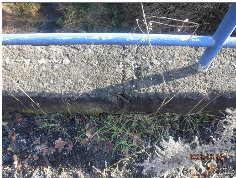
Detail povrchové degradace betonu říms, jednotlivé trhliny, lokálně odhalená výztuž.
