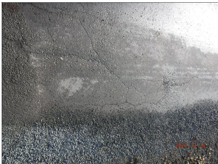
Ve vozovce jsou sítě trhlin.
