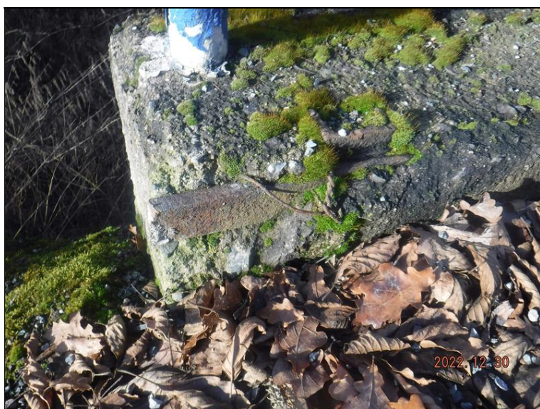
Detail vyčnívajícího rohové ocelového profilu v římsa. Římsy jsou porostlé mechy.
