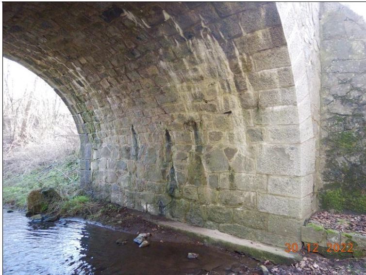
Silné stopy zatékání na levé straně klenby (O1). Výluhu pojiva, na povrchu uchycené sinice/mechy. Lokálně poruchy spárování.
