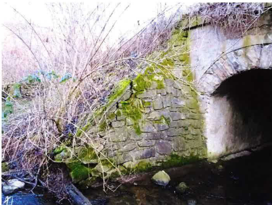
podemleté křídlo mostu 125-008
