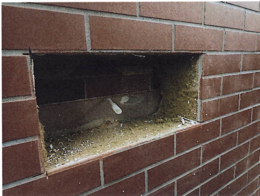
Obr. 3.10: Sonda 3 v řezu, absence lepicí hmoty na podkladu
