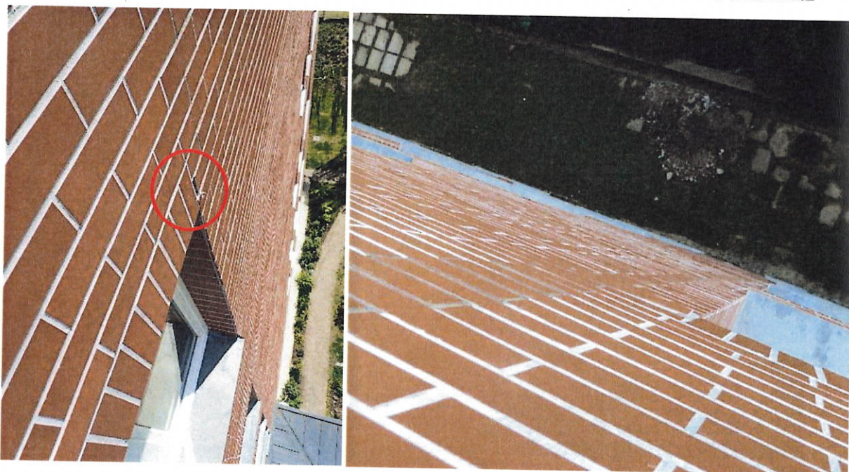
Obr.1.4: Jižní fasáda, 5. NP, samovolné vydrolení spárovací hmoty obkladové dlaždice Obr.1.5: Severní fasáda, 3. NP, uvolnění obkladového pásku v blízkosti styku ostění a nadpraží v místě vertikální dilatace
