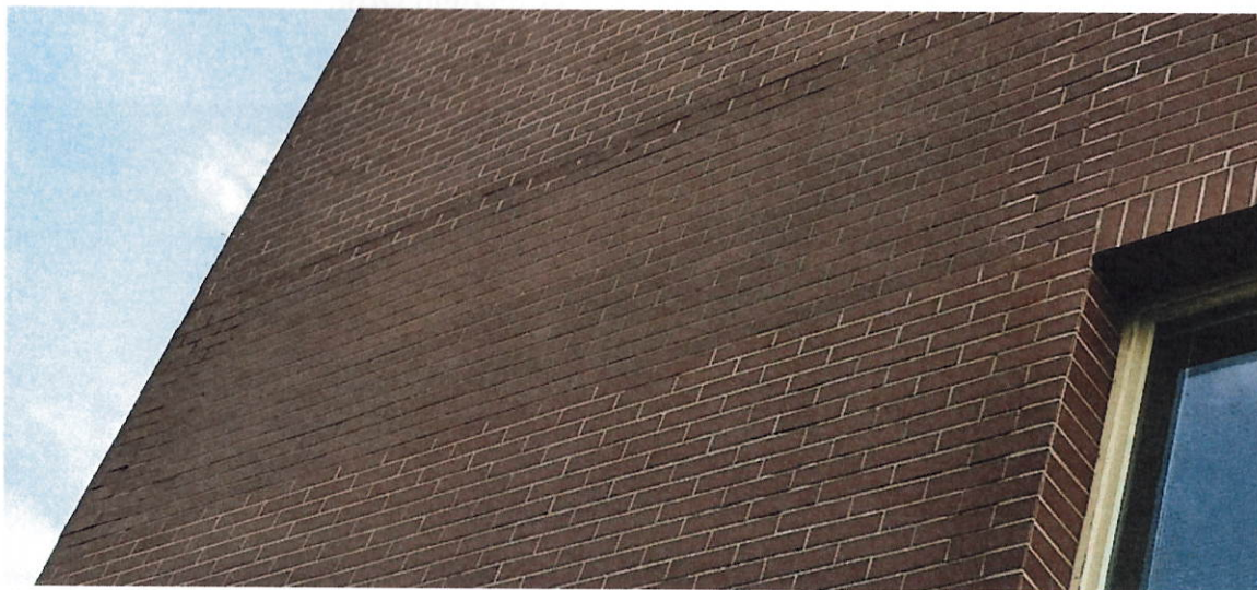
Obr.1.24: Severní fasáda, 3. NP, projevy vlhkosti po dešti
