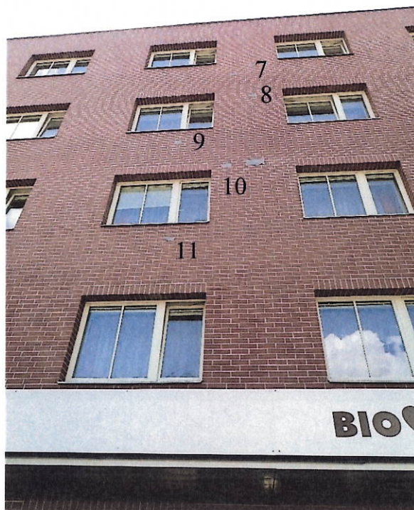
Obr. 2.4: Severovýchodní fasáda, oblast 2, místa odtrhových zkoušek 7 až 11
