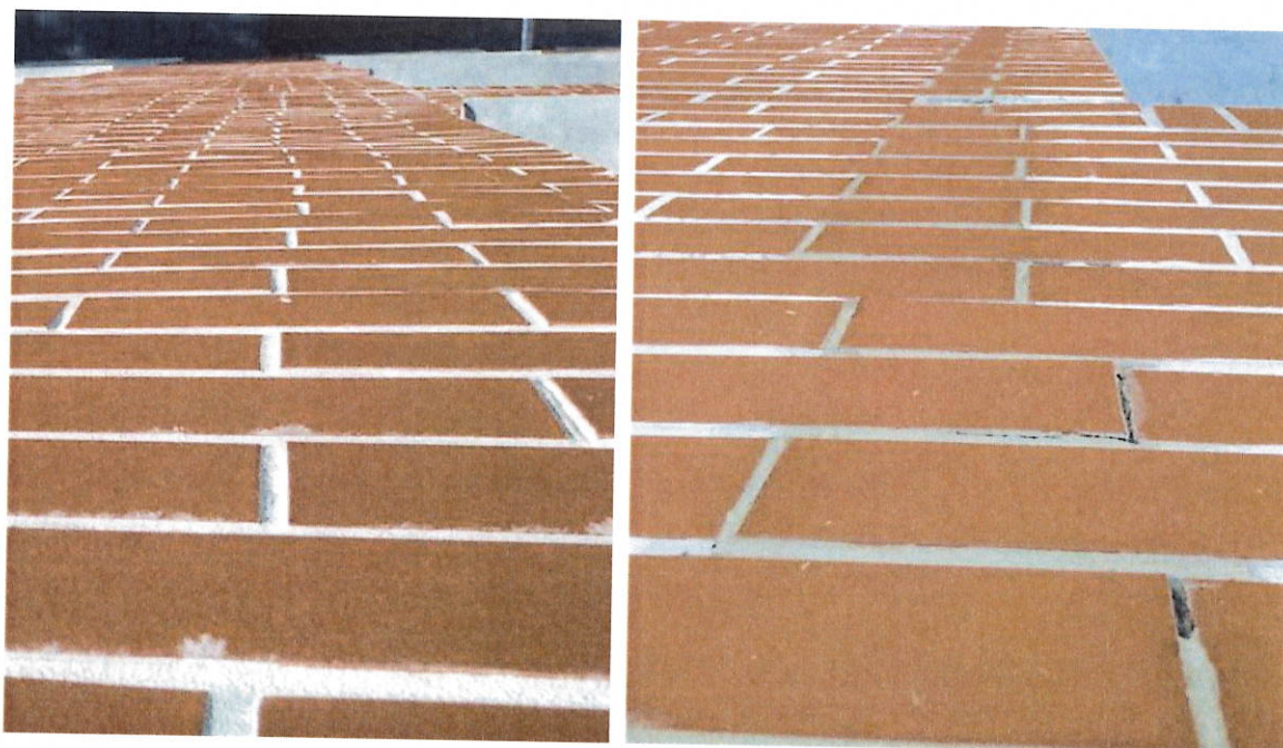
Obr.1.6: Jižní fasáda, 5. až 1. NP, vadná rovinnost keramického obkladu Obr.1.7: Severní fasáda, 5. NP, samovolné uvolnění obkladové dlaždice, trhliny ve výplni dilatační spáry
