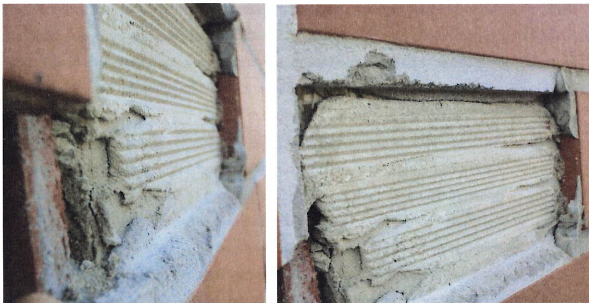
Obr. 7, 8: Zjištěný stav vrstvy lepidla po odstranění uvolněné dlaždice; tento druh separace je podle zkušeností z praxe typický pro jednostranné nanášení lepidla na podklad (floating)
