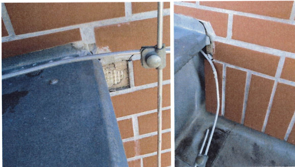
Obr.1.16: Západní fasáda střešní nástavby v západní části objektu, uvolnění keramického obkladového pásku v místě napojení atiky na fasádu z vnější strany
