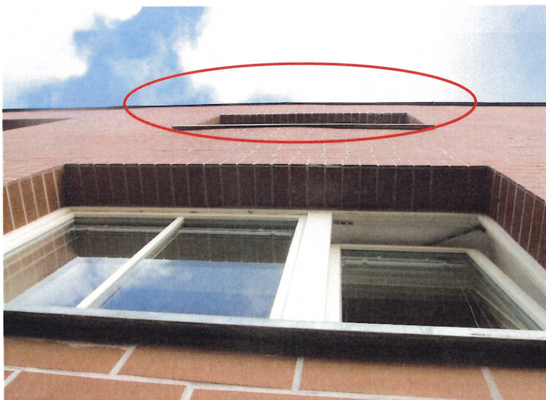
Obr.1.23: Jižní fasáda, 5. NP, nerovnost v ploše obkladu, existence boulí
