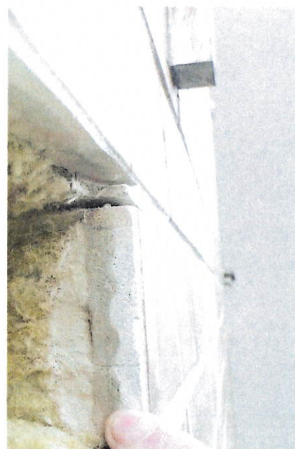
Obr. 3.9: Sonda 2, detail vlhké zóny ve stěrce a na řezu spárovací hmoty
