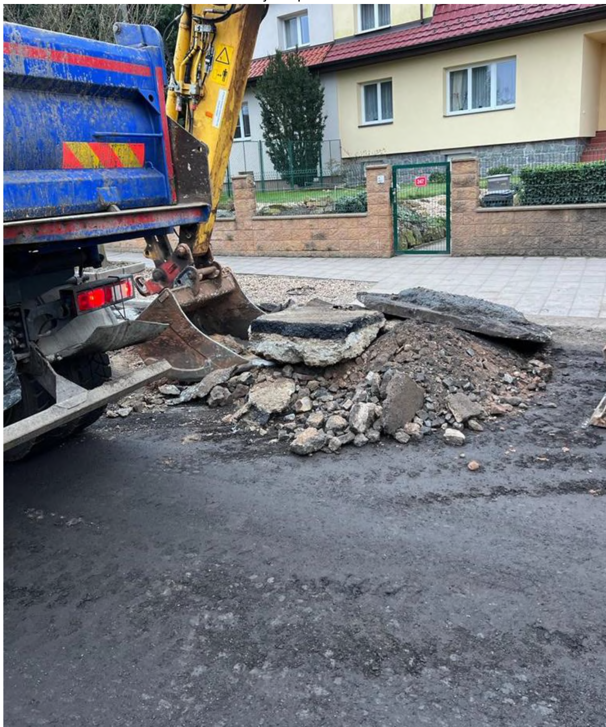
Příloha č. 3 – Fotodokumentace stavu stávajících podkladních vrstev
