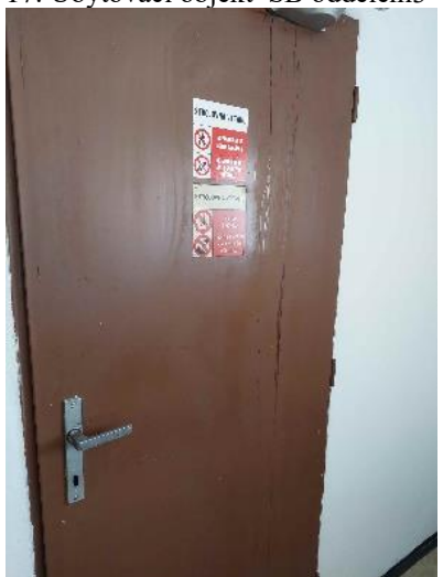
18. Ubytovací objekt –SB strojovna
