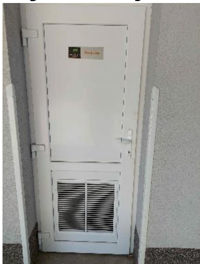
32. Ubytovací objekt – Stravování strojovna
