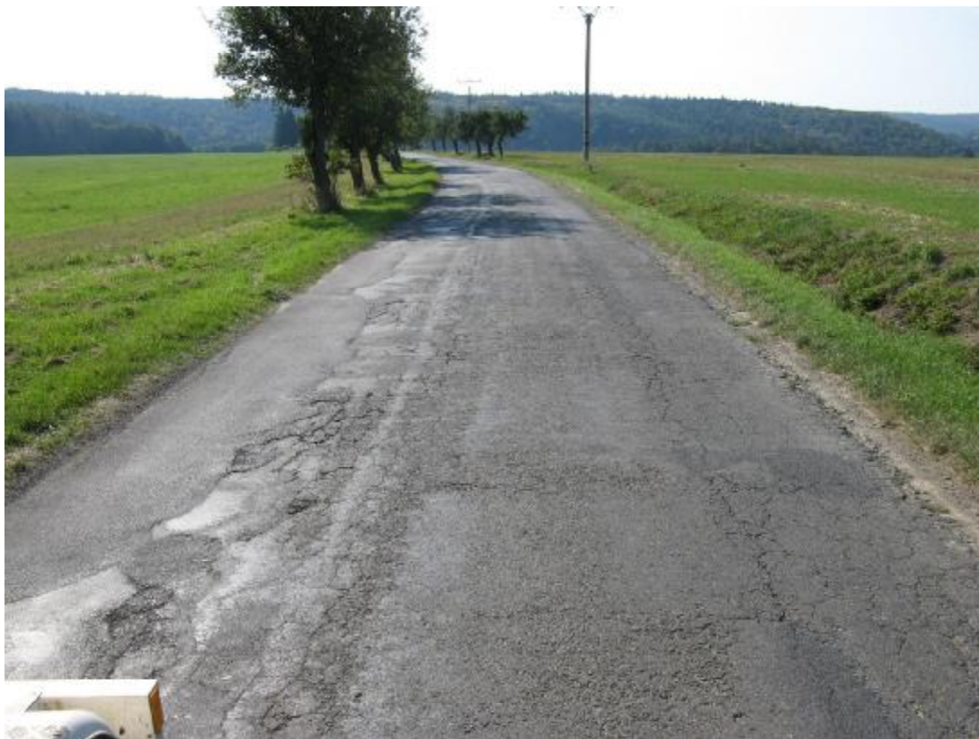
F93, km 9,100- Síťové trhliny, plošné deformace a vysprávký podél okrajů vozovky.
