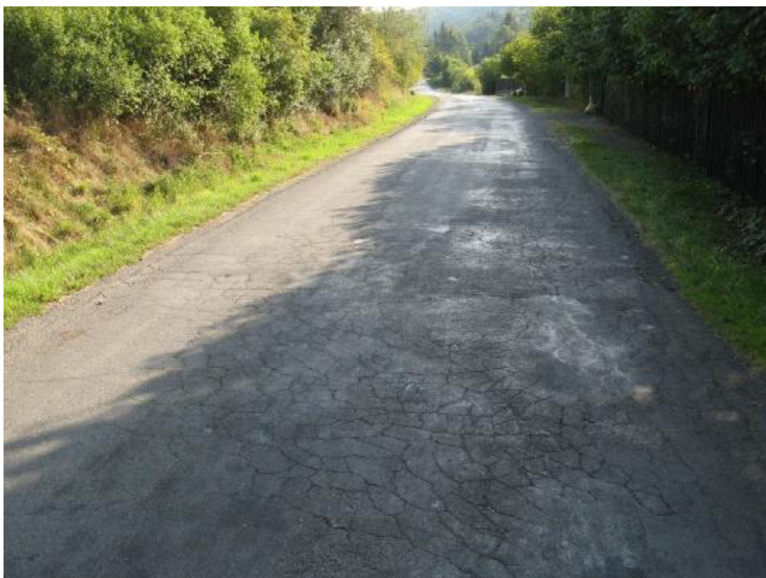
F19, km 4,510+ Síťové trhliny a plošné deformace v celé šířce vozovky.
