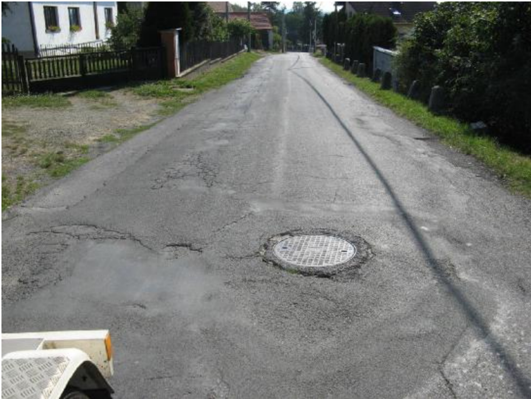
F121, km 10,500- Síťové trhliny a deformace podél okrajů a na zapravených rýhách.
