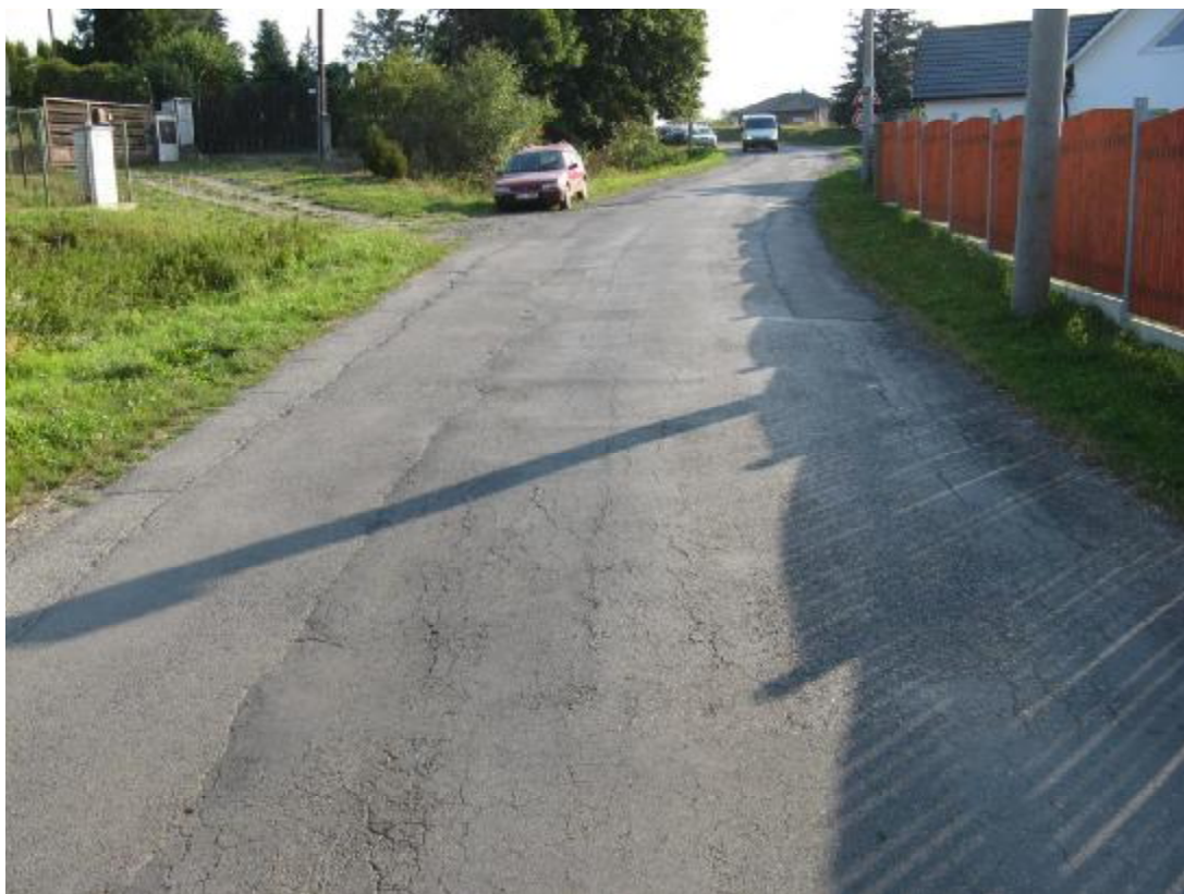
F02, km 3,430+ Plošné deformace, síťové trhliny, vysprávkvy.
