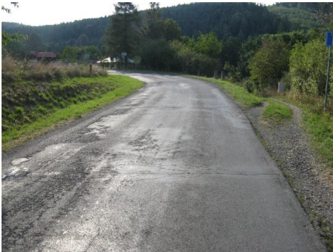
F15, km 4,210+ Hluboká koroze, vysprávký a příčné rozvětvené trhliny.
