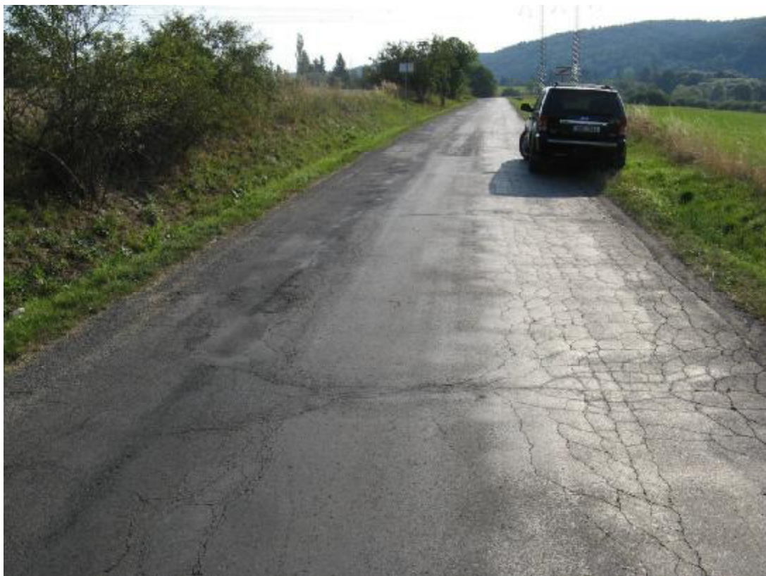
F08, km 3,710+ Plošné deformace, síťové trhliny zejména podél okrajů vozovky.
