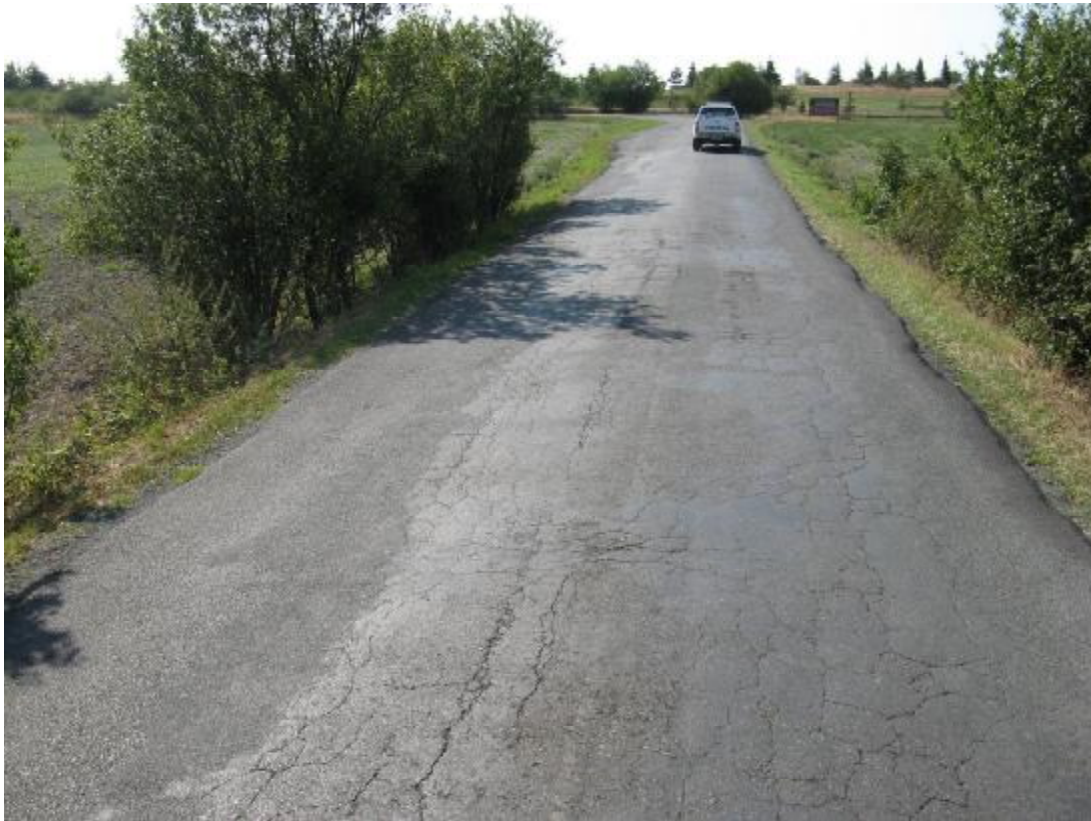
F21 km 0,910+ Síťové trhliny, vysprávkky a plošné deformace podél obou okrajů vozovky.
