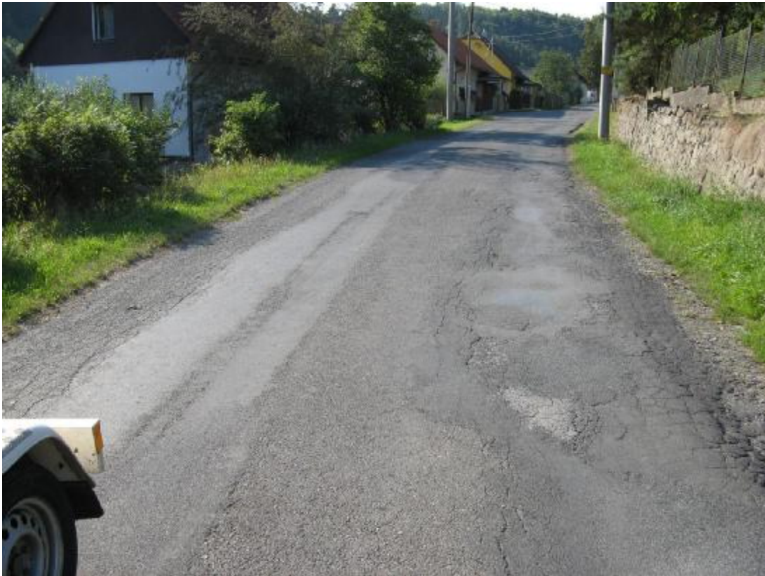
F53, km 6,300- Síťové trhliny a plošné deformace podél okrajů vozovky.
