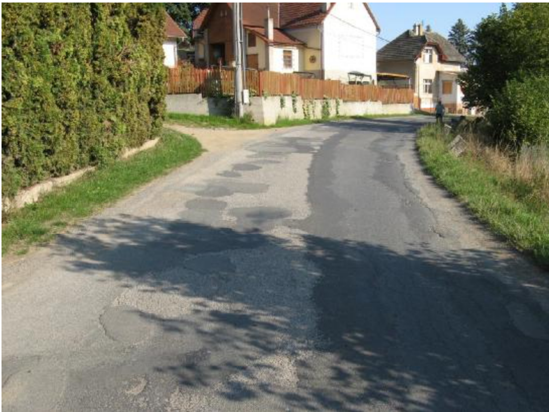
F45, km 5,910+ Síťové trhliny a vysprávký podél okrajů vozovky.
