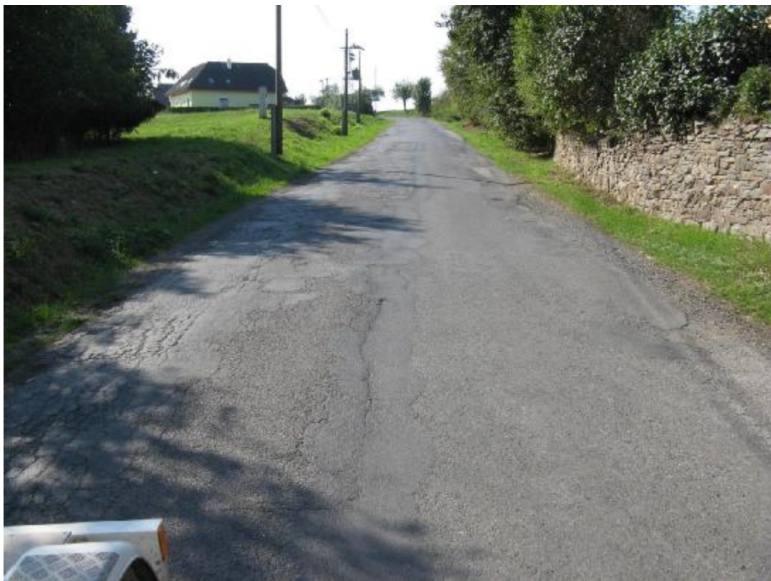
F105, km 9,700- Síťové trhliny, plošné deformace a vysprávký podél okrajů vozovky.
