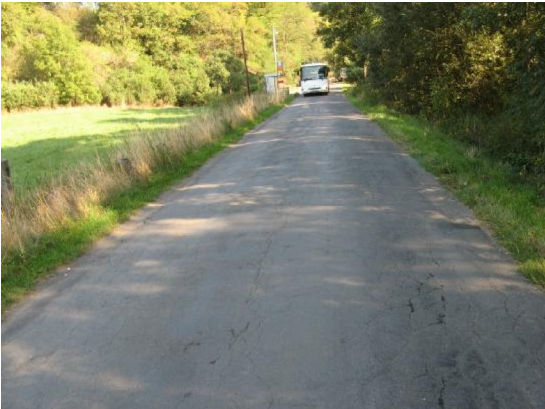
F65, km 6,910+ Síťové trhliny a plošné deformace.
