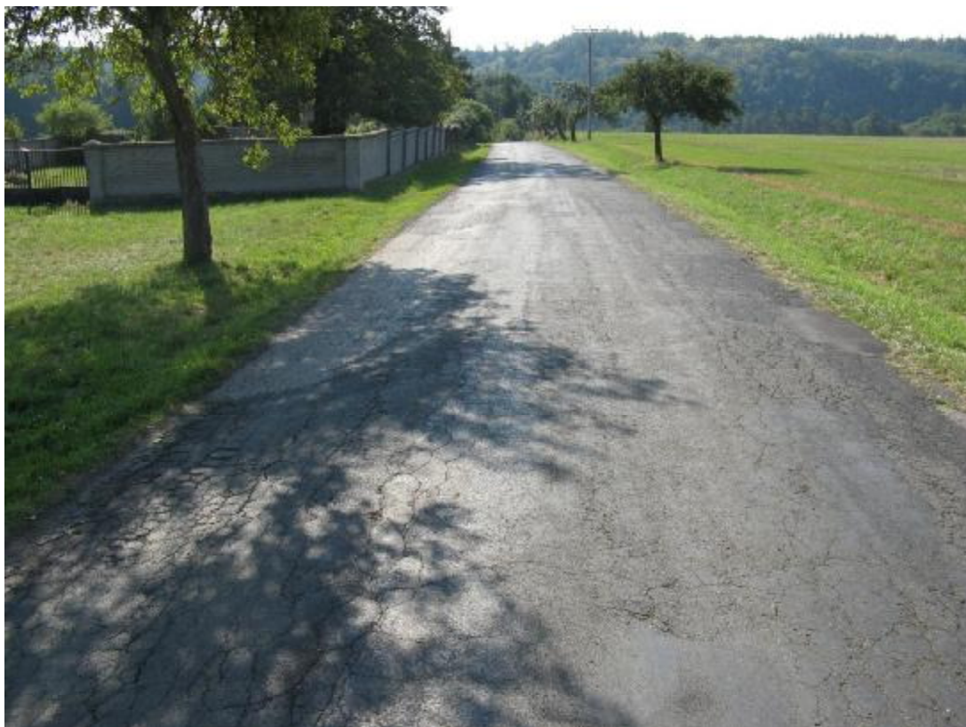
F87, km 8,800- Síťové trhliny a plošné deformace.
