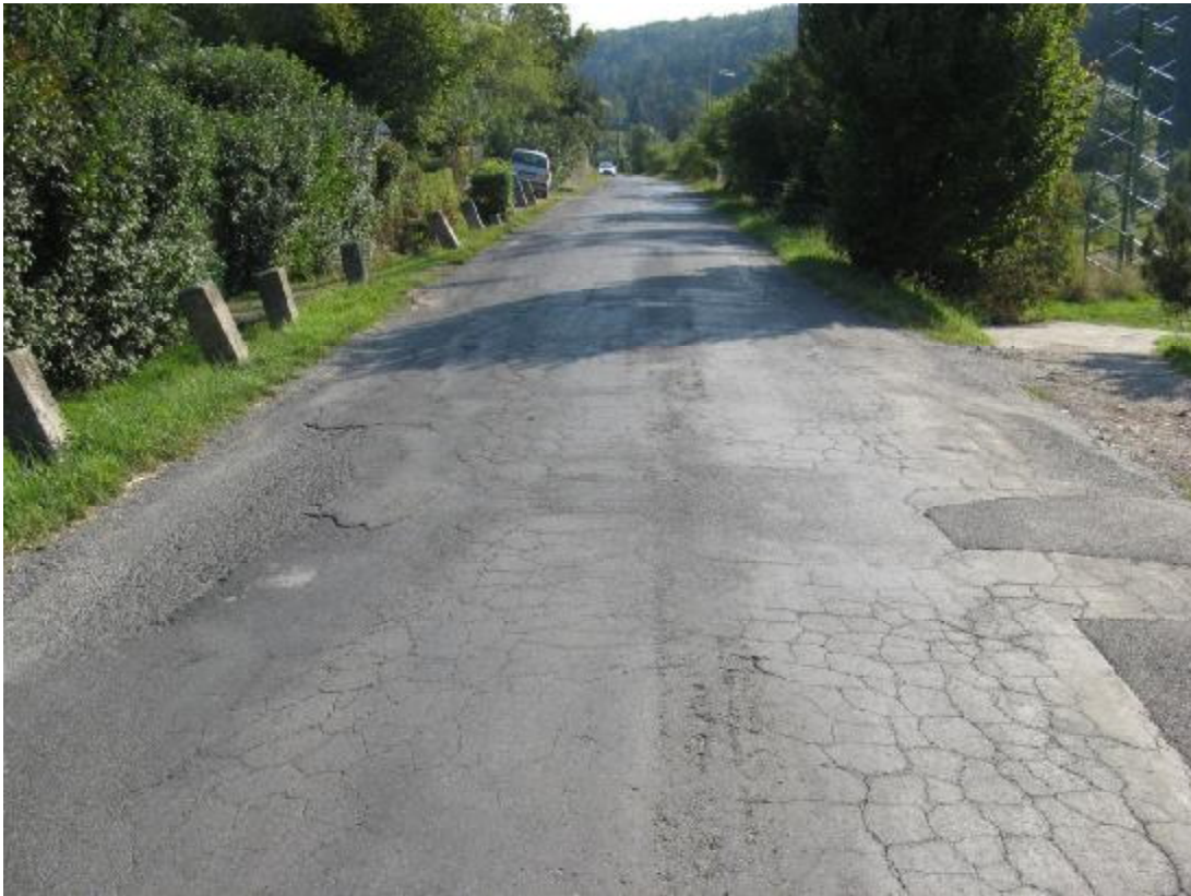
F30, km 5,110+ Síťové trhliny a plošné deformace v celé šířce vozovky.
