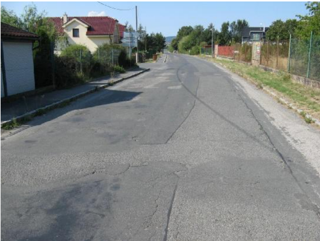
F04, km 0,110+ Vpravo je zapravená rýha s plošnými deformacemi, vlevo koroze EKZ.
