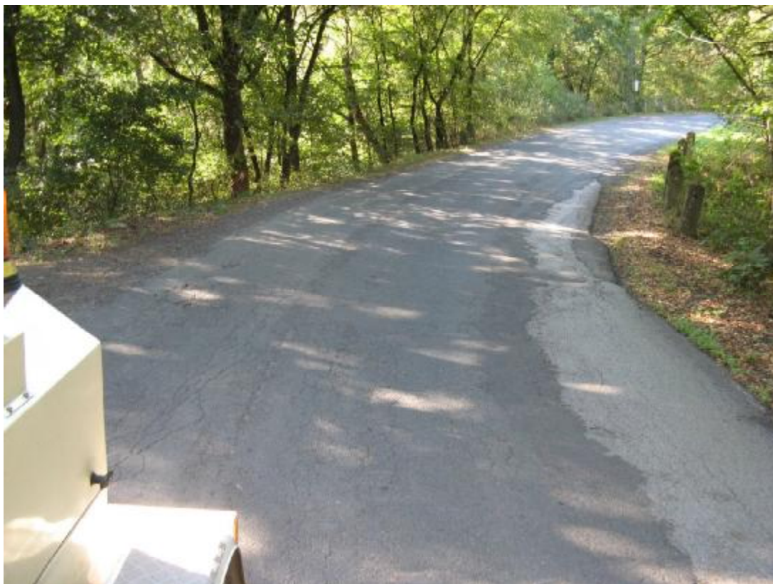
F79, km 8,400- Síťové trhliny a vysprávkky podél obou okrajů vozovky.
