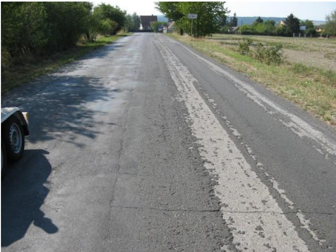
F132, km 11,000- Příčné trhliny, koroze EKZ a nepravidelné hrboły od vysprávek.
