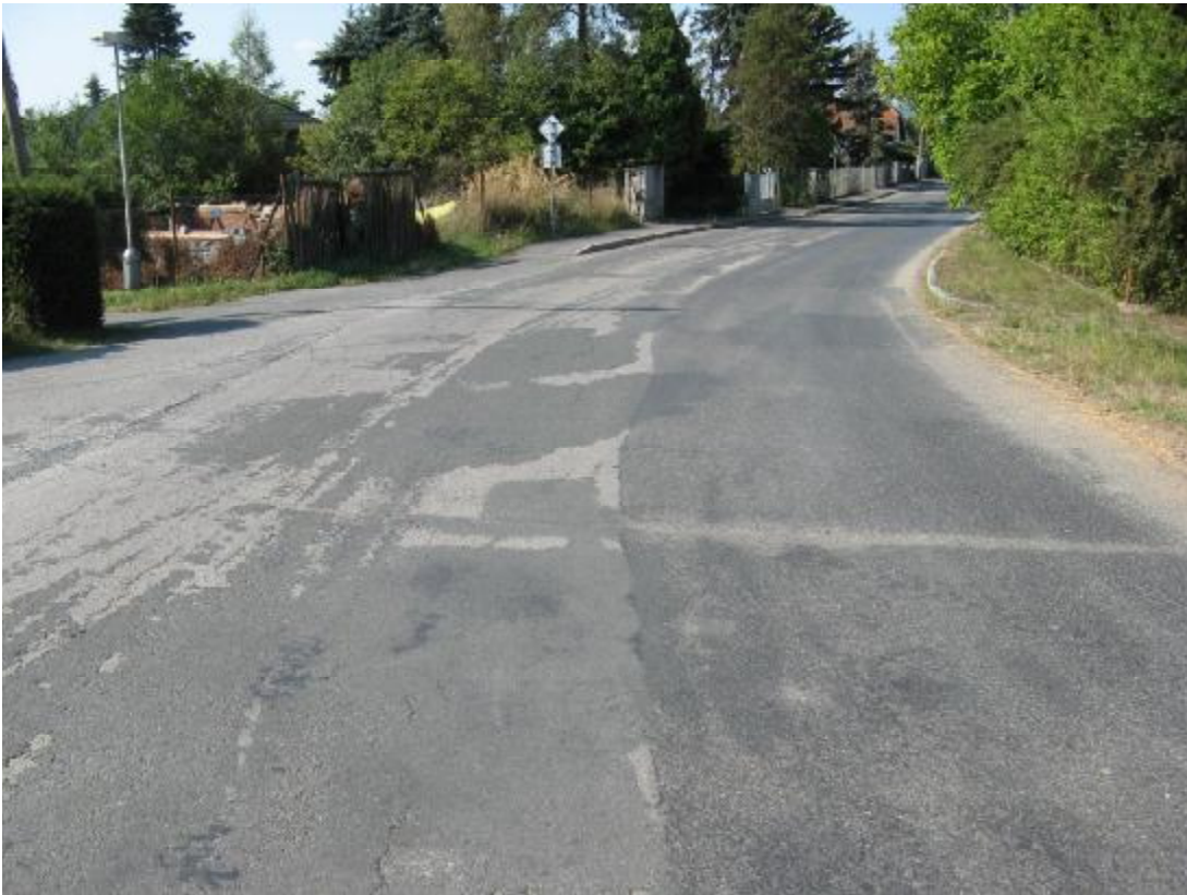
F02, km 0,015+ Příčná trhlina, koroze EKZ.
