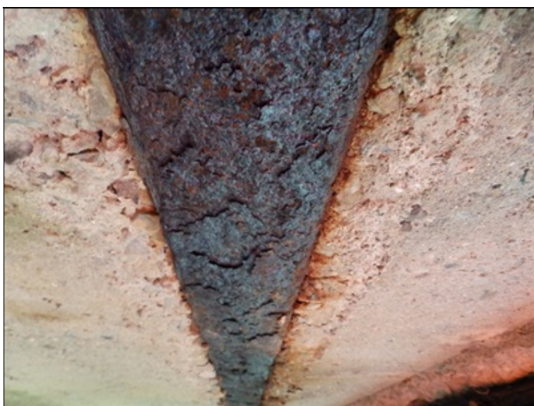
Koroze nosníků rozšíření na levé straně mostu
