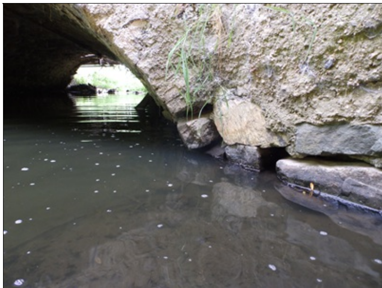
Rozvolněné zdivo v patní části Op 2 na pravé straně
