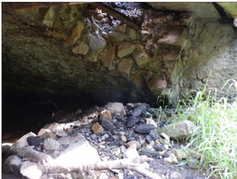
Destrukce zdiva klenby na levé straně mostu
