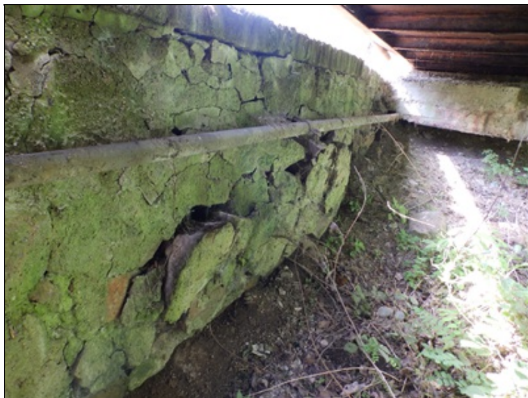
Vyboulené rozpadající se zdivo opěrné zídky komunikace navazující na pravé řídlo Op2.
