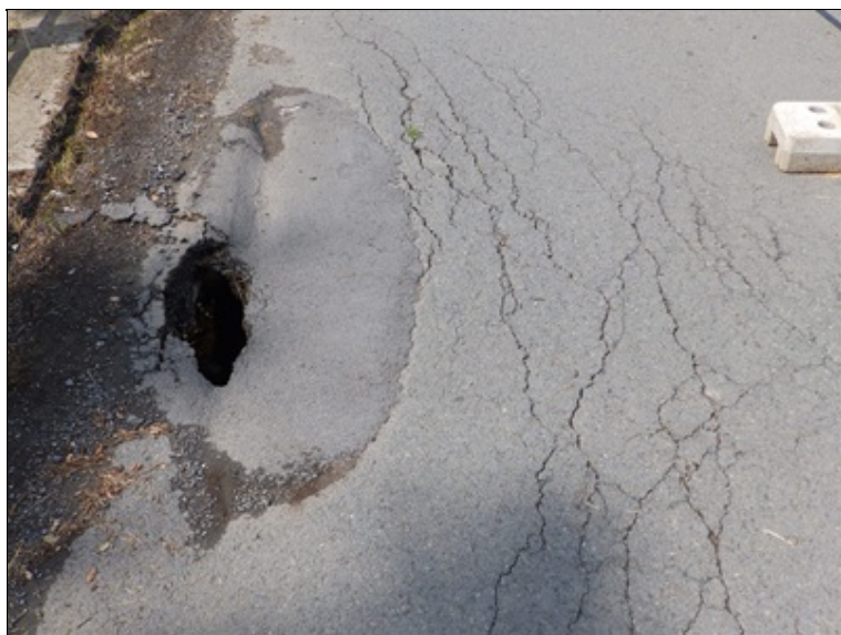
Detail propadlé vozovky na levé straně konstrukce
