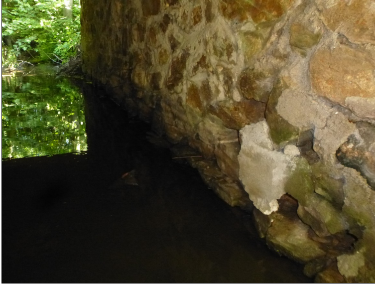
střední část zdiva opěry 1
