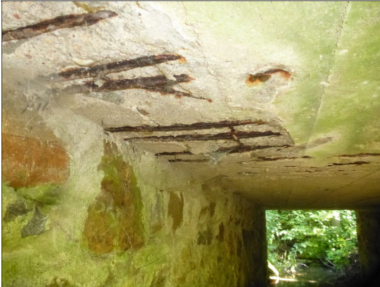
koroze obnažené nosné výztuže na spodním líci desky u opěry 2
