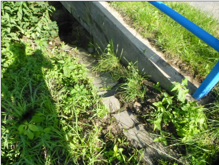
rozpad odvodňovacího skluzu
