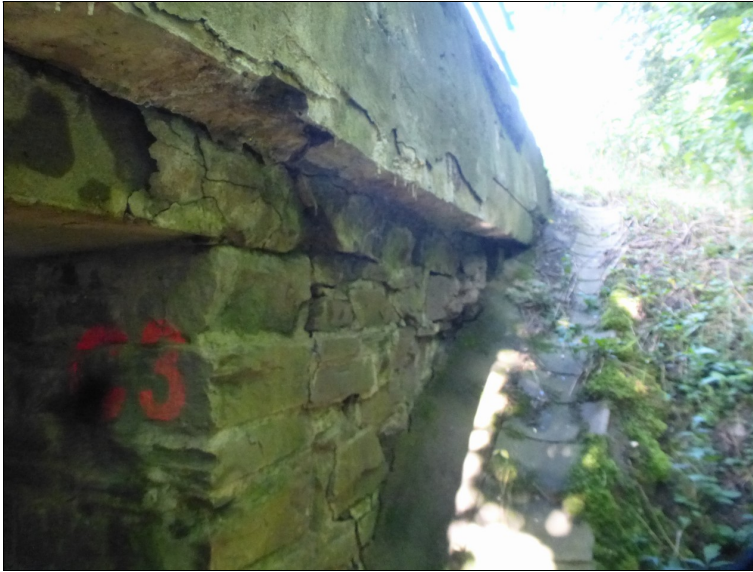
rozpad zdiva pravého křídla opěry 2, hloubková degradace betonu a separace krycí vrstvy na boku desky a na spodním líci římsy
