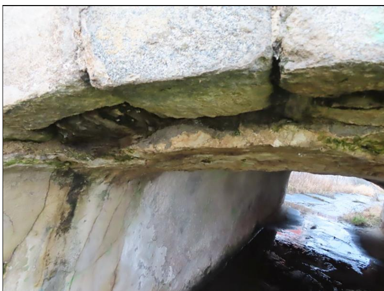
Pohled zprava z čela do 4. pole Plošná separace torkretu a pokles vnitřního klenebního pásu
