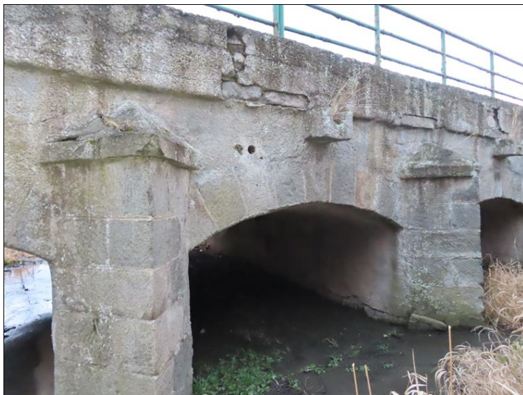
Pohled zleva do 3. pole Čelní zeď - poteklé a vodorovné trhliny v torkretu Římsa - odpadlý torkret
