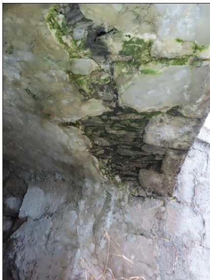
2. pole Pohled směrem k Pi3 Podélná široká trhlina s vypadávajícími kameny
