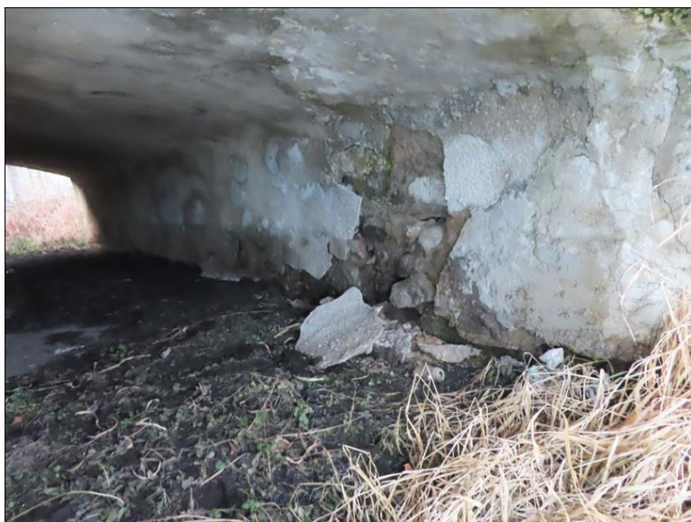
2. pole Pohled na Pi3 Vyboulení a odpadnutí torkretu
