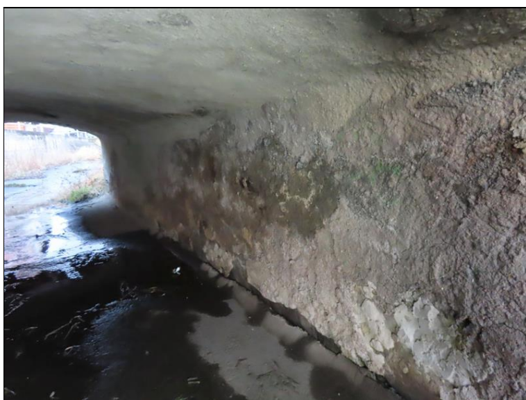
Pohled na OP5 zprava ze 4. pole Průsaky
