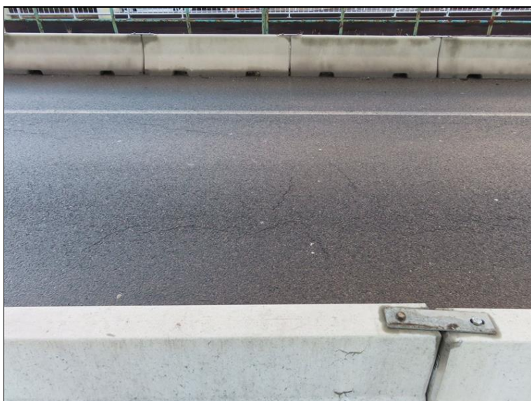
Pohled zprava Vozovka -pravá strana - podélné trhliny cca ve středu vozovky - v jízdnicích stopách v PJP - příčné trhliny
