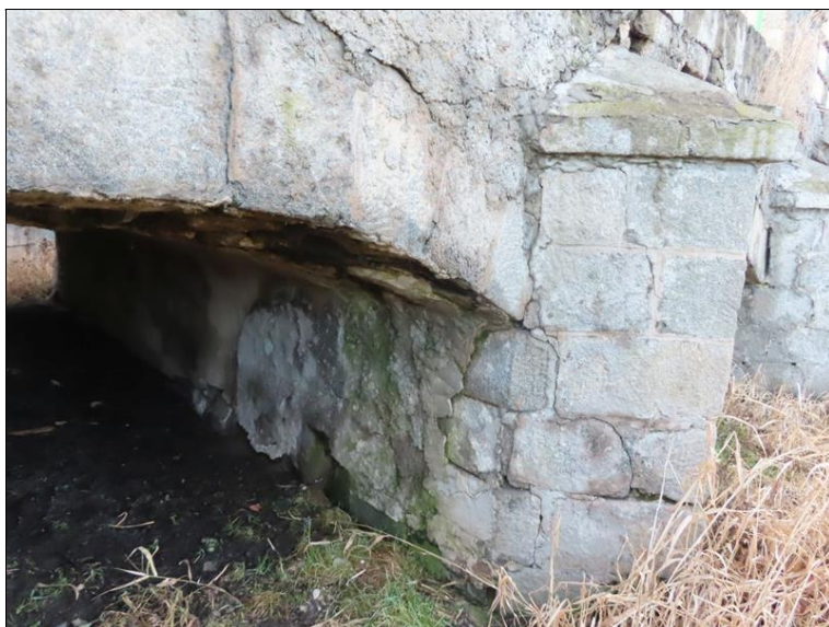
1. pole Pohled na Pi2 zprava Vyboulení torketu v klenbě a na stěně
