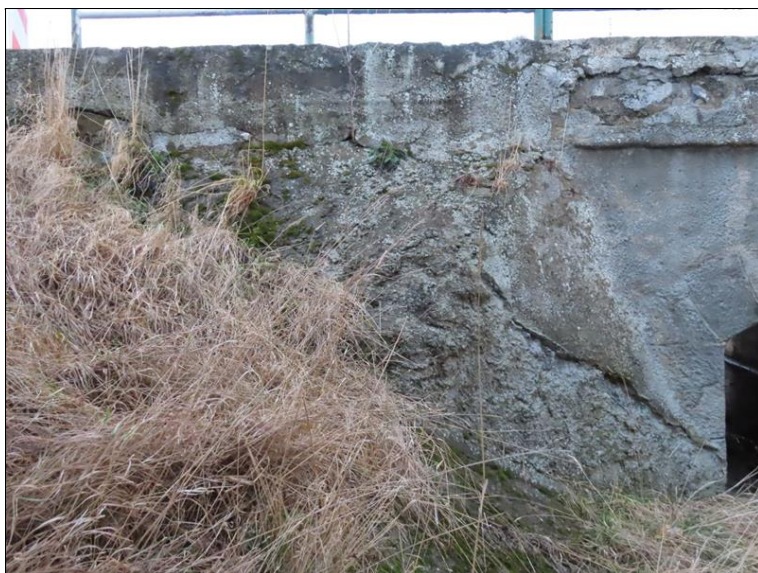
Pohled na OP5 a křídlo zleva Degradace čelní zdi a křídla
