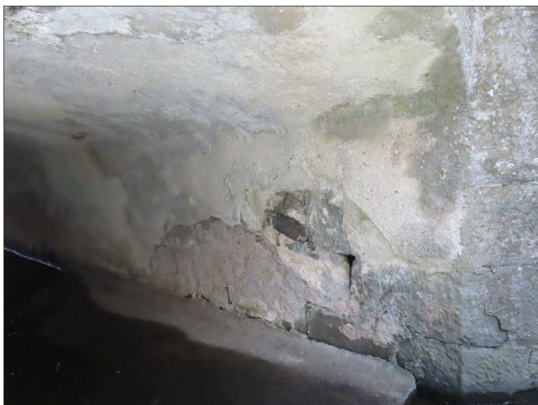
Pohled zleva do 4. pole na Pi4 Plošné odpadnutí vrstvy torkretu
