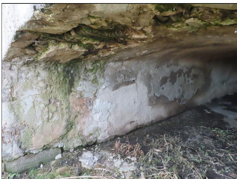
Pohled na Pi2 zprava 2. pole Rozpadlý podemletý torkret, svislá trhлина
