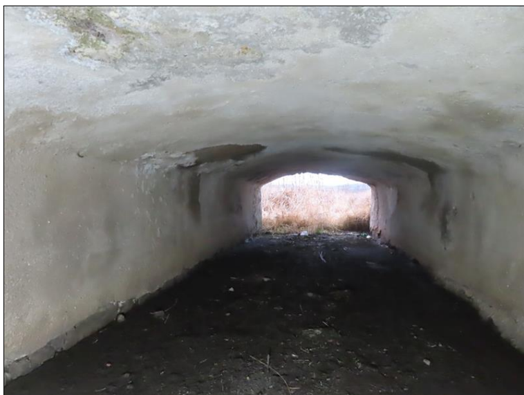
Pohled zleva do 3. pole Projevy zatékání -zavlhě
