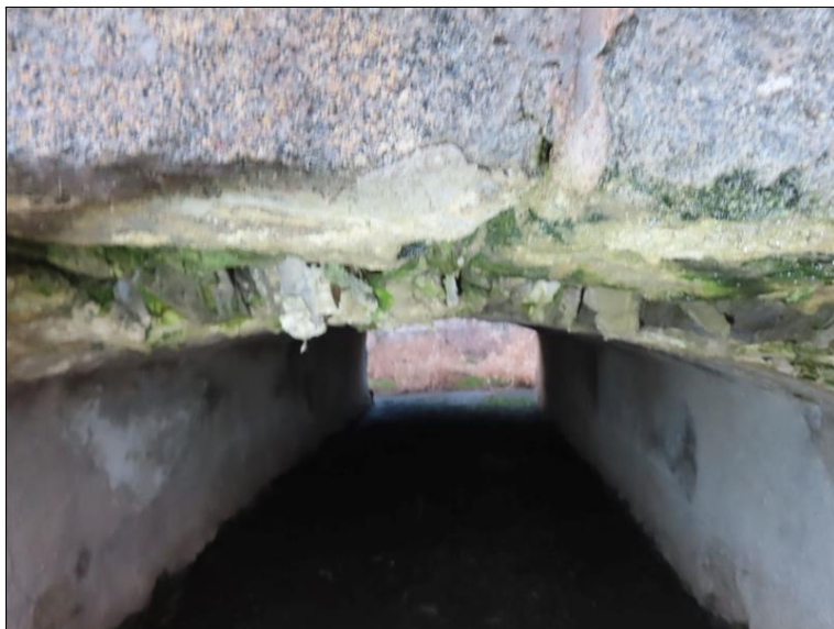
Pohled zprava z čela do 3. pole Pokles vnitřního klenebního pásu
