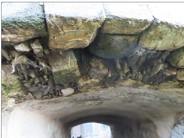
1. pole Pohled z čela Zcela rozvolněné kameny ve vrcholu klenby
