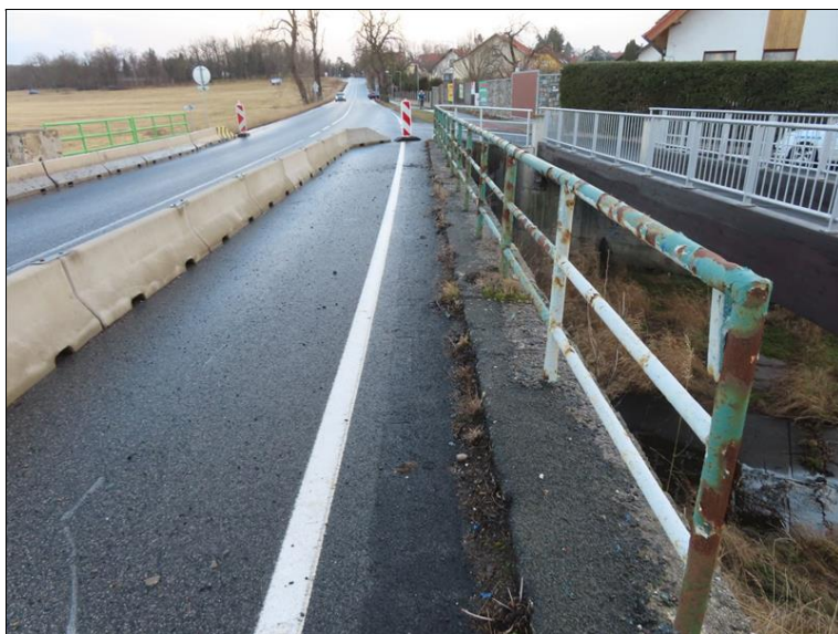
Levá strana Zábradlí -silná koroze
