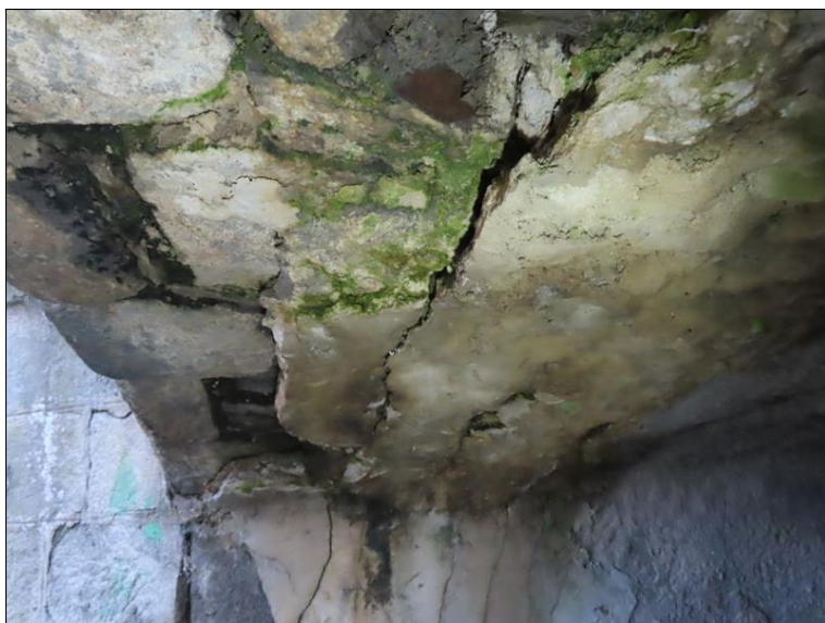
4. pole Pohled směrem k Pi4 Podélná široká trhlina v torkretu
