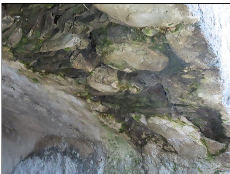
1. pole Pohled na Pi2 zprava Zcela rozvolněné kameny u paty klenebního pásu
