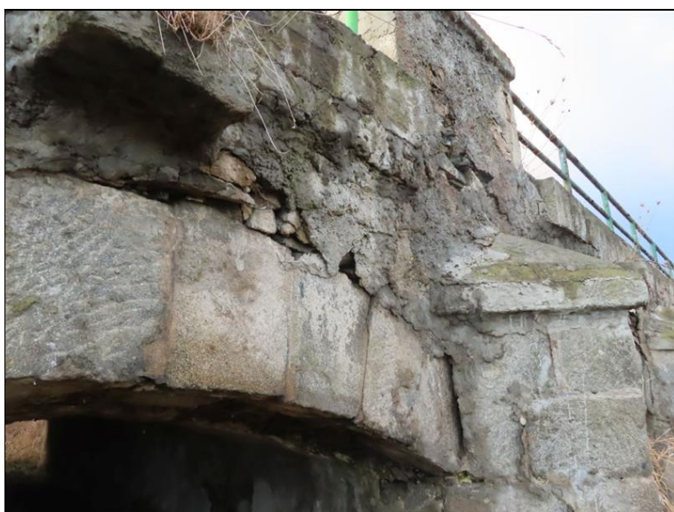
Pohled zprava do 2. pole směrem k Pi3 Čelní zed' - rozvolněna, rozpadající se
