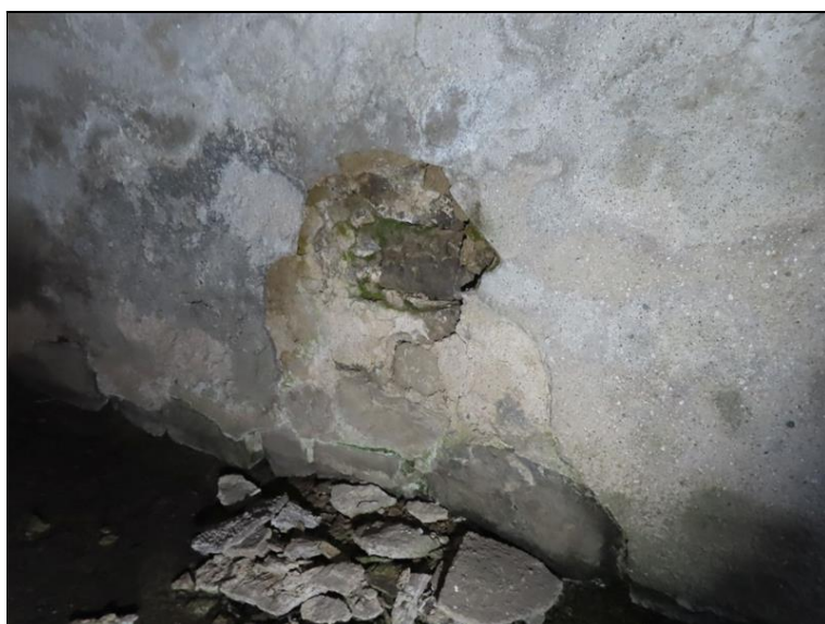
Pohled zleva do 1. pole směrem k OP1 Odpadlý torkret
