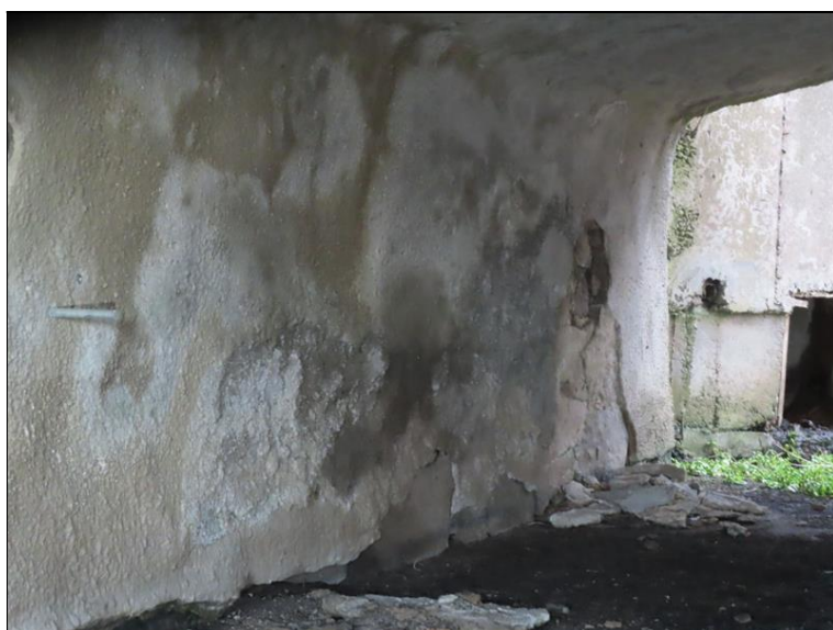
Pohled na OP1 LS 1. pole Plošné odpadnutí silné vrstvy torkretu
