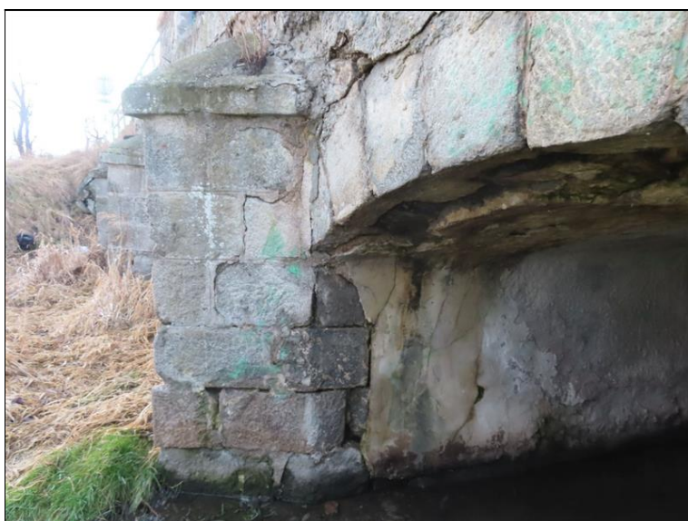
Pohled na Pi3 zprava 4. pole Četné svislé trhliny v torkretu
