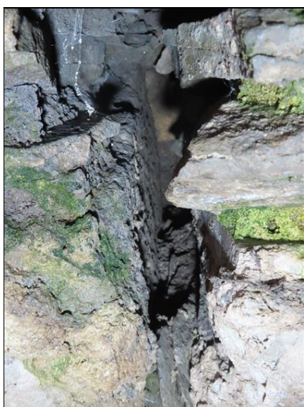
3. pole Pohled směrem k Pi3 Podélná široká trhlina s vypadlými kameny- hl. až na nadnásyp
