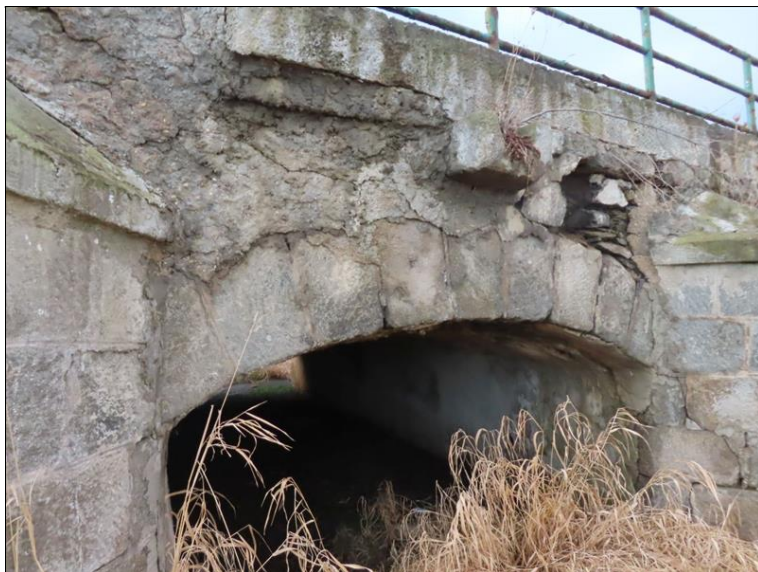
Pohled zprava do 3. pole Čelní zeď - rozvolněna, hluboká kaverna
