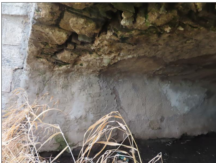
Pohled na Pi3 zprava 3. pole Četné svislé trhliny v torkretu
