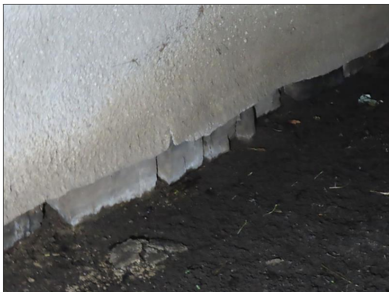
Pohled zleva do 1. pole směrem k Pi2 Odpadnutí torkretu a podemletí
