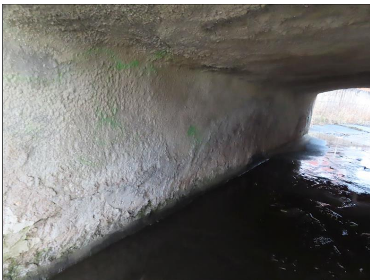
Pohled na Pi4 zprava ze 4. pole Průsaky
