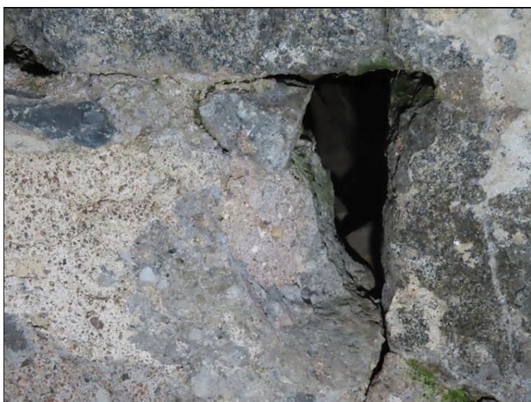
Pohled zleva do 4. pole na Pi4 Plošné odpadnutí vrstvy torkretu Hluboká kaverna
