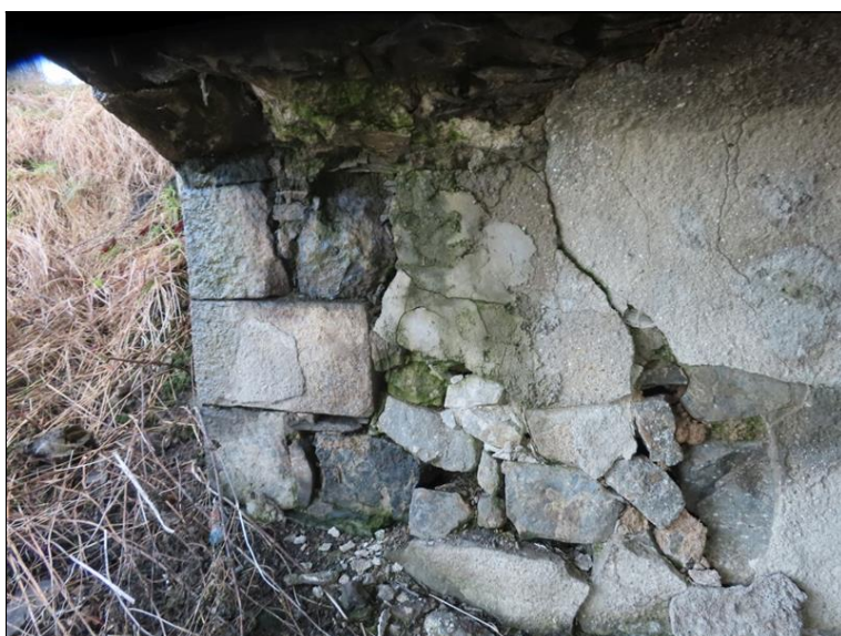
Pohled na OP1 PS 1. pole Rozpad zdiva opěry vypadané a rozvoněné kameny spojené z deformací
