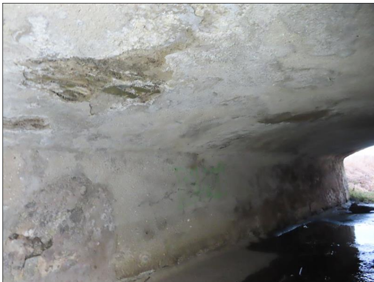
Pohled zleva do 4. pole na OP5 Zatékání - odpadnutí vrstvy torkretu
