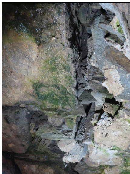
3. pole Pohled směrem k Pi3 Podélná široká trhlina s vypadlými kameny
