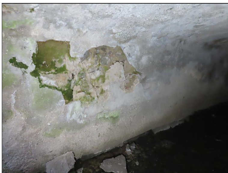
Pohled zleva do 1. pole směrem k Pi2 Odpadnutí torkretu
