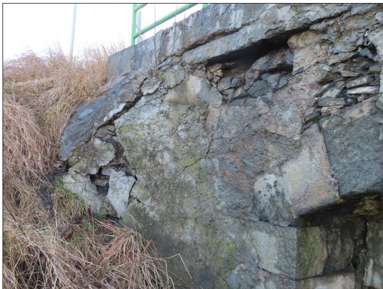
Pohled na OP1 a křídlo zprava Rozpad zdiva křídla a čelní zdi
