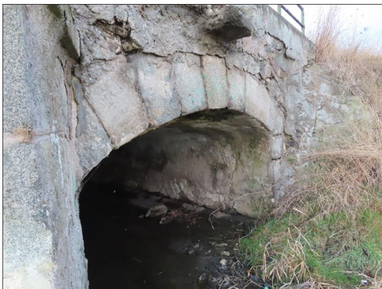
Pohled zprava do 4. pole Čelní zeď - rozpad torkretu
