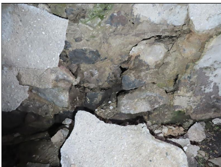
2. pole Pohled na Pi3 Vyboulení a odpadnutí torkretu- rozvolnění kamenů zdiva
