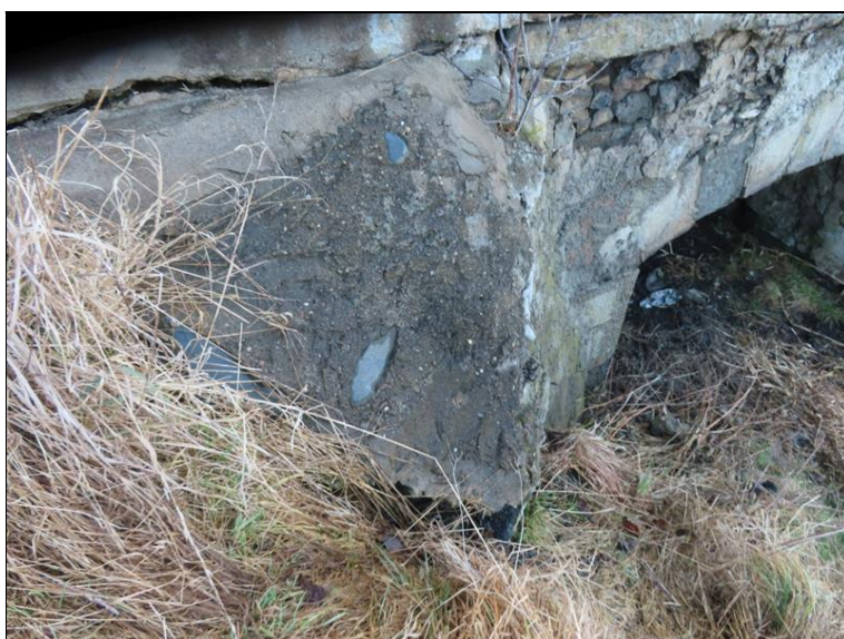
Pohled na OP1 a křídlo zprava Podemleté a utržené od čelní zdi
