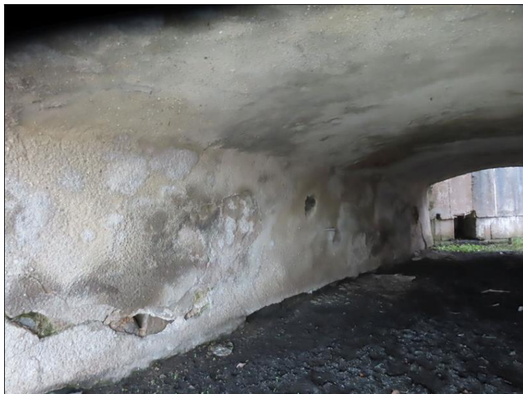
Pohled na OP1 zprava 1. pole Četné trhliny výluhy v torkretu Trhliny, separace, odpadnutí torkretu
