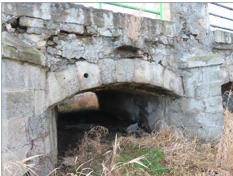
Pohled zprava do 2. pole Čelní zeď - rozvolněna, rozpadající se
