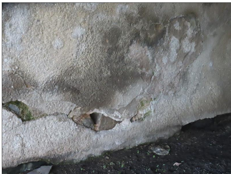
Pohled na OP1 zprava 1. pole Četné trhliny výluhy v torkretu Trhliny, separace, odpadnutí torkretu Kaverna ve zdivu
