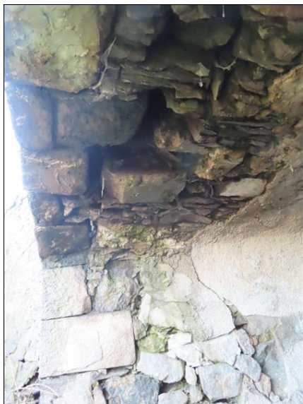
1. pole Pohled směrem k OP1 Podélná široká trhлина s vypadlými kameny Silně rozvolněné kameny Hluboké kavermy až na násypovou zeminu
