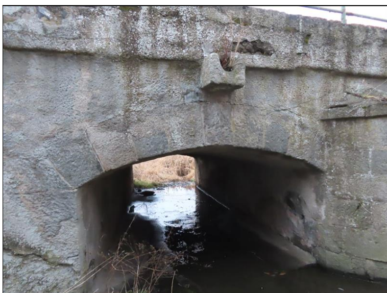
Pohled zleva do 4. pole Čelní zeď - poteklé a vodorovné trhliny v torkretu
