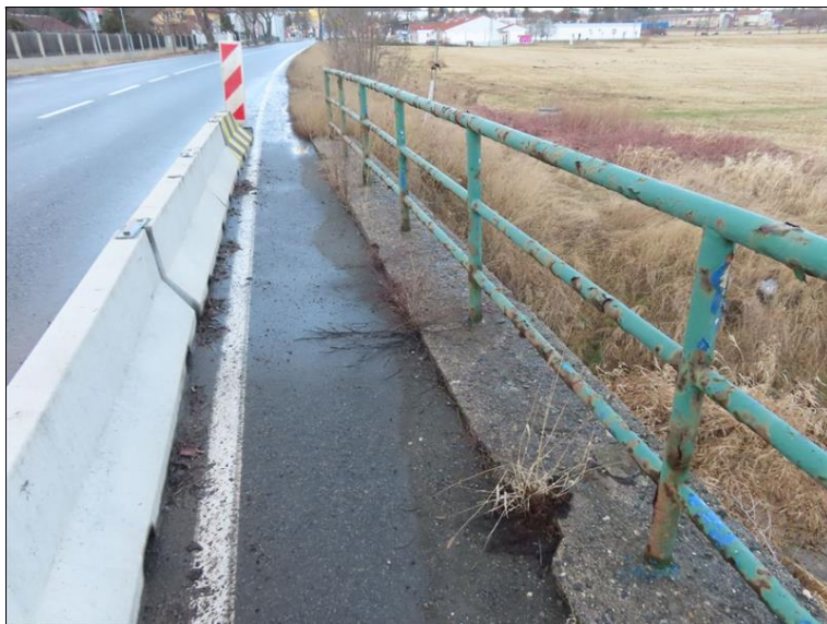
Pohled na pravou stranu Zábradlí - silná koroze
