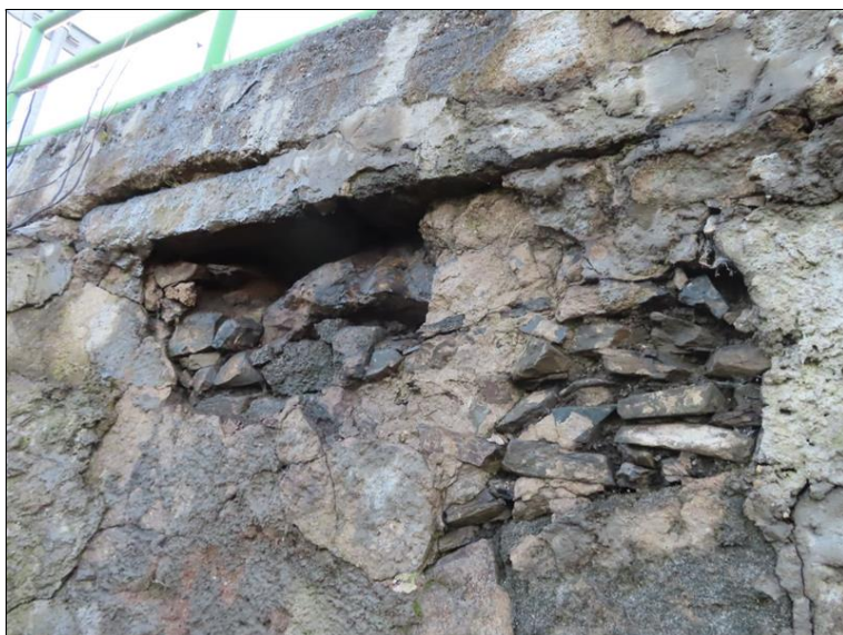
Pohled nad OP1 čelní zed' zprava Rozpad zdiva čelní zdi, vypadaná zrna - hluboké kavermy
