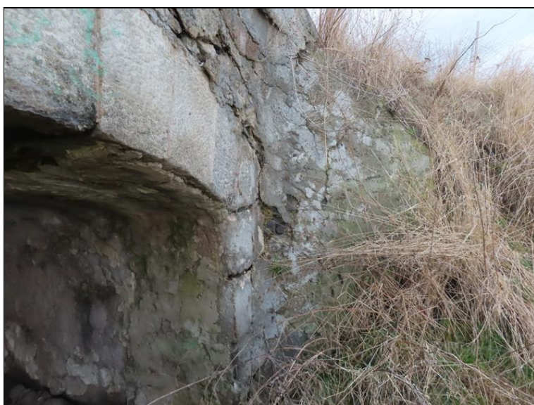
Pohled na OP5 zprava ze 4. pole Separace torkretu
