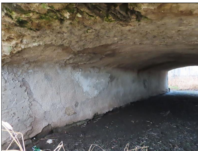
Pohled na Pi3 zprava 3. pole Četné svislé trhliny v torkretu
