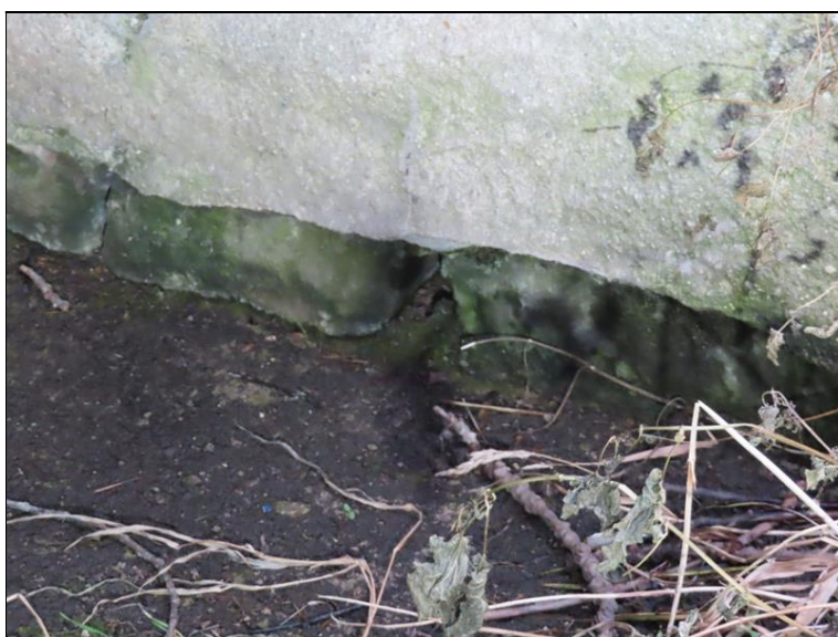
Pohled zleva do 2. pole směrem k Pi2 Odpadnutí torkretu a podemletí
