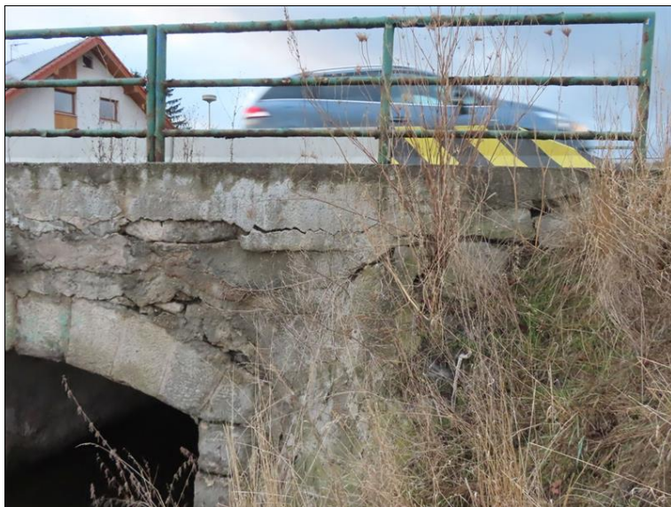
Pohled na OP5 a křídlo zprava Rozpad čelní zdi a křídla
