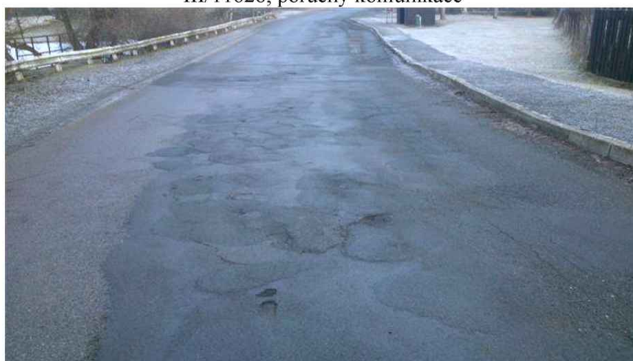
III/11628, poruchy komunikace
