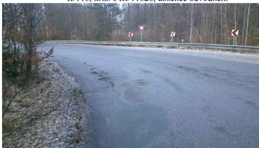
III/11628, poruchy komunikace
