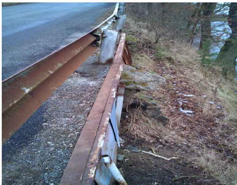
III/11628, provizorně podchycená krajnice
