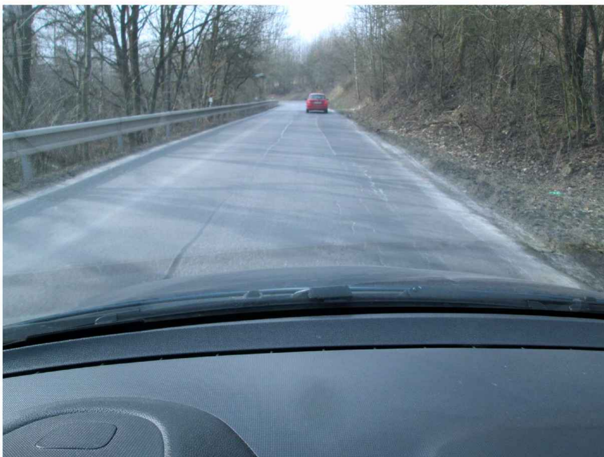
II/116, km 57,650, Nová Ves pod Pleší, pod zatáčkami
