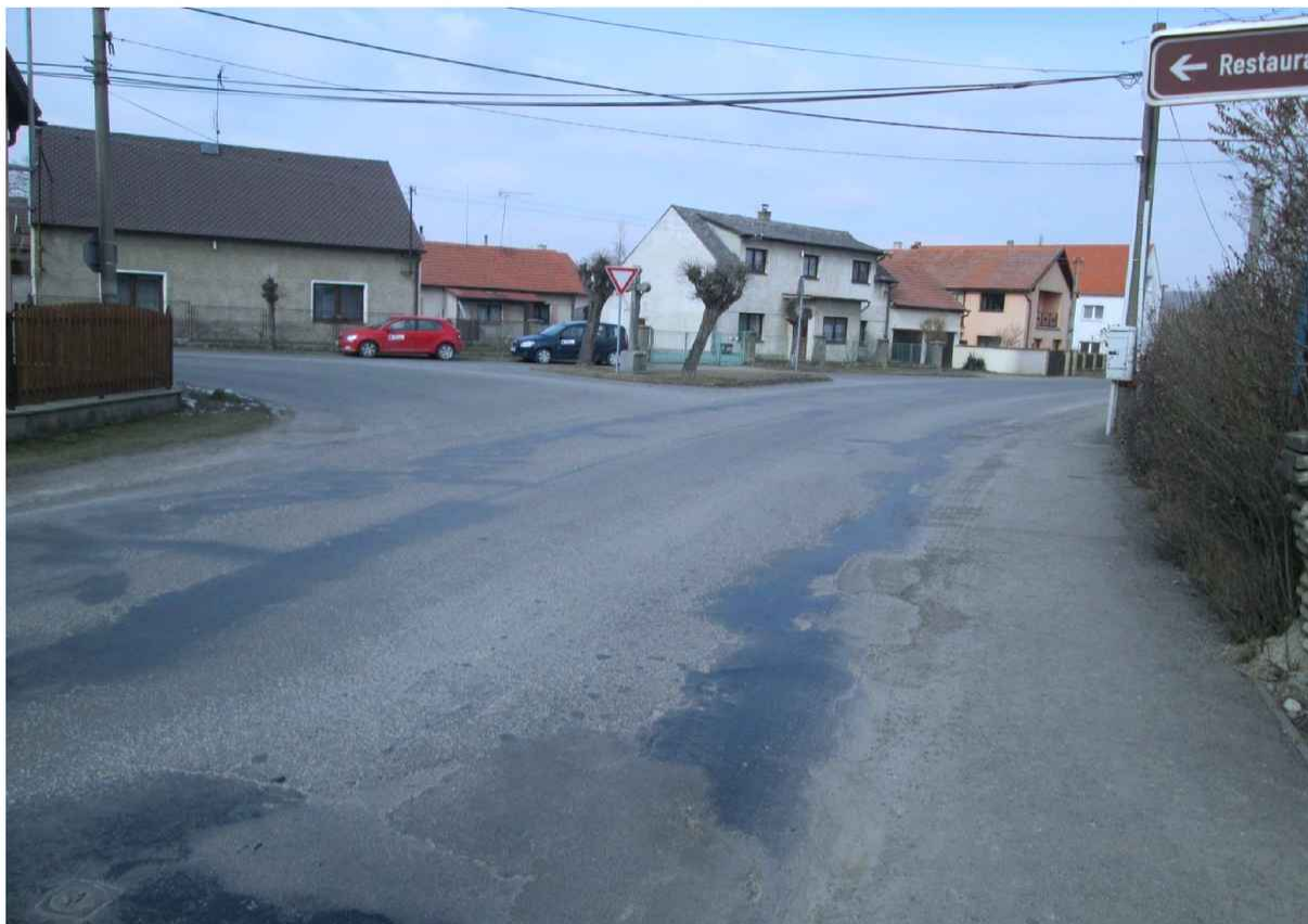
II/116, křiž. s III/11628, absence odvodnění
