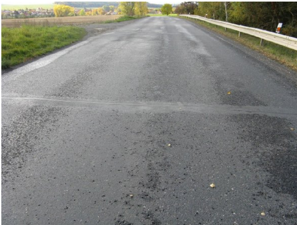
F16, km 1,510+ Příčné rozvětvené trhliny ošetřené zálivkou a tryskovými vysprávkami, kaverny, ztráta makrotextury, mírně vyjeté koleje.
