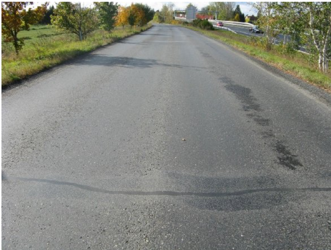
F06, km 0,510+ Příčné rozvětvené trhliny ošetřené zálivkou a tryskovými vysprávkami, kaverny, ztráta makrotextury, mírně vyjeté koleje.
