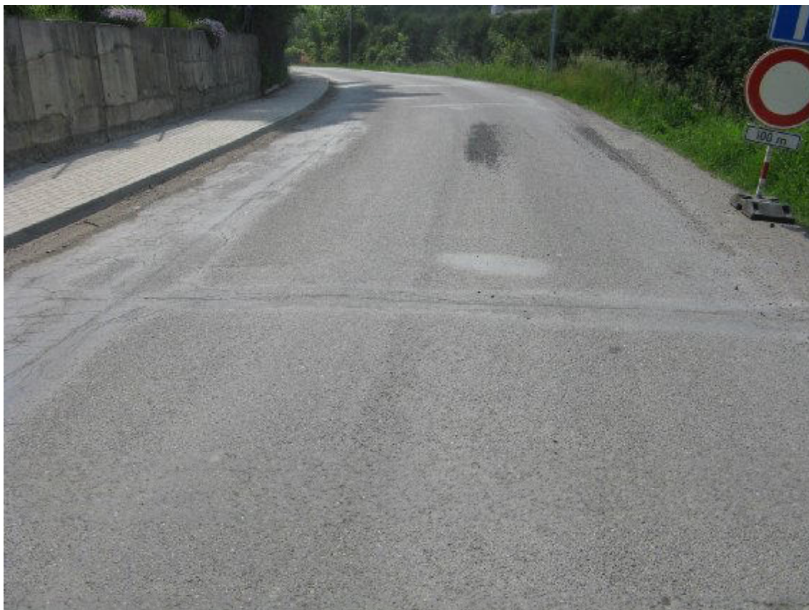
F11, km 0,510+ Příčná trhlina s tryskovými vysprávkami, vlevo mozaikové/sít'ové trhliny, plošné deformace a vysprávkky podél obrub.
