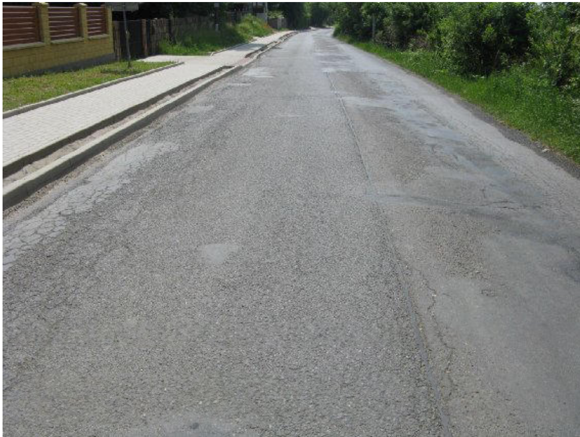
F02, km 0,050+ Sít'ové trhliny a plošné deformace podél obrub a okraje, vysprávkky, nepravidelné hrboly, ztráta asfaltového tmelu, hloubková koroze.
