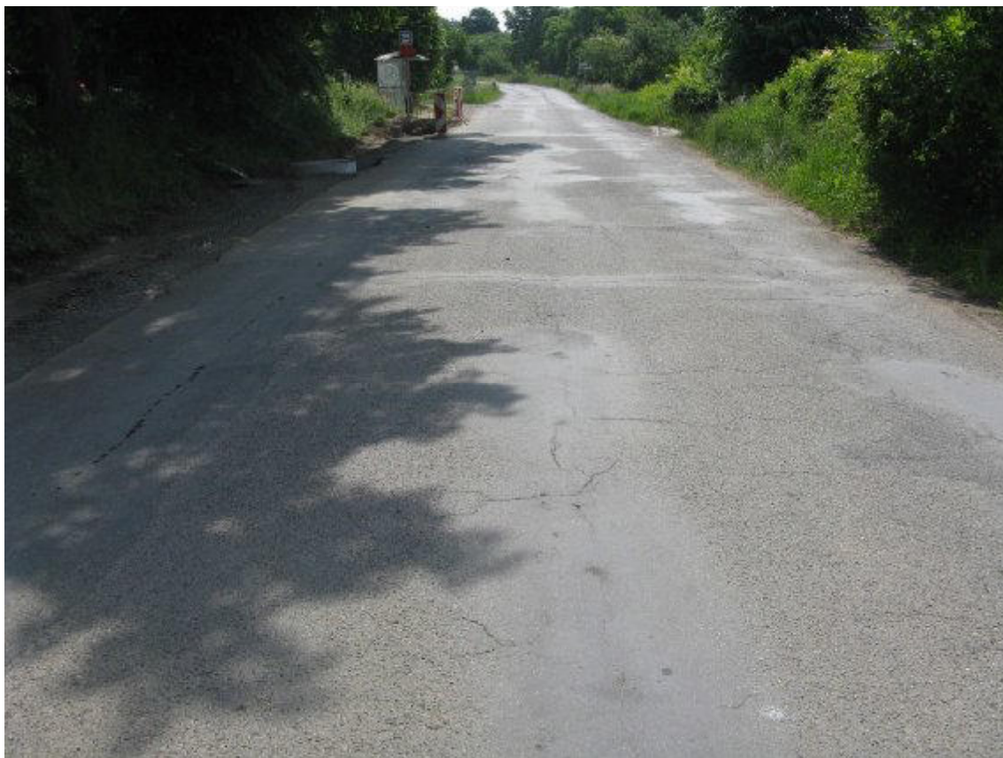
F26, km 1,250+ Mozaikové, příčné, podélné a nepravidelné trhliny, vysprávký tryskovou metodou, nepravidelné hrboly.
