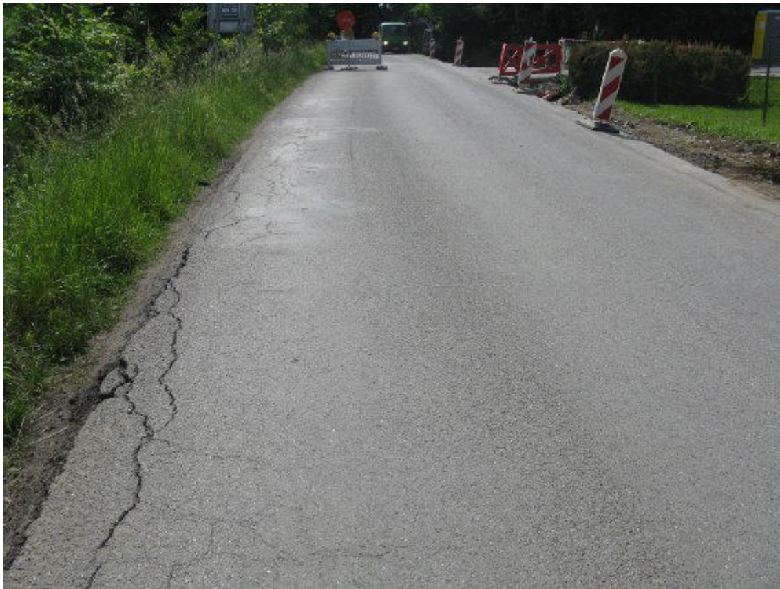
F18, km 0,850+ Olamování okraje, mozaikové a nepravidelné trhliny, vysprávký tryskovou metodou, zanesení příkopu.
