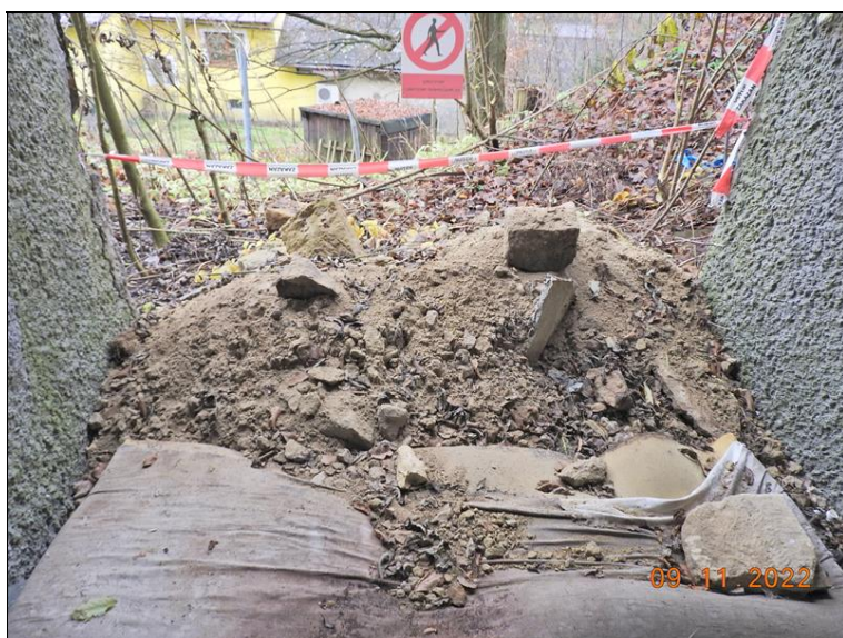
Materiál vypadnutý z nosné konstrukce.
