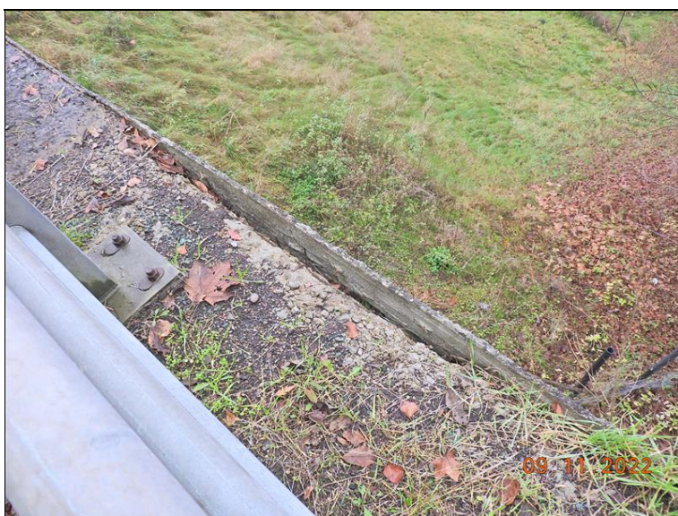
Levá strana mostu - separace boční části NK.
