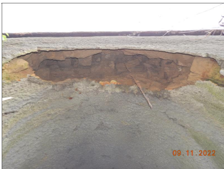
Vypadnuté kameny vlevo.
