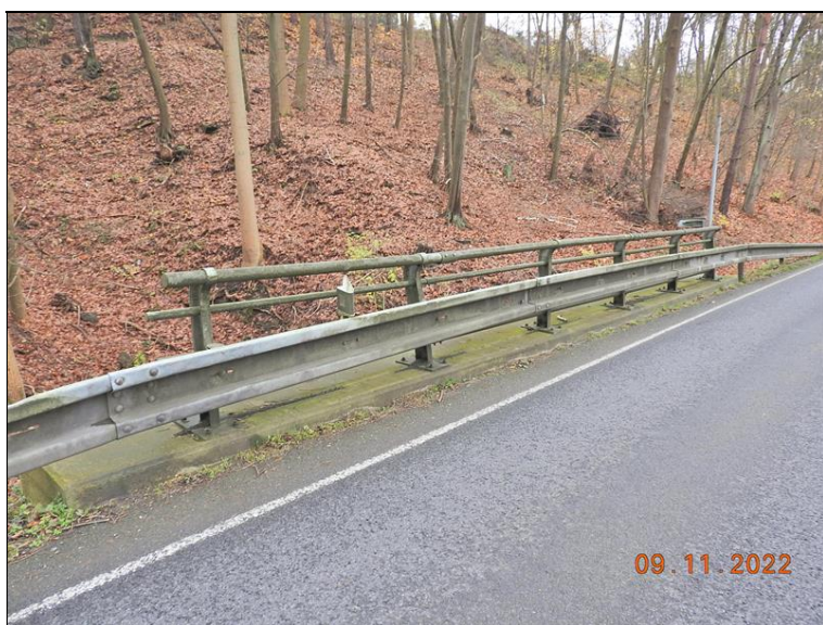
Pravá strana mostu - utržený směrový sloupek.
