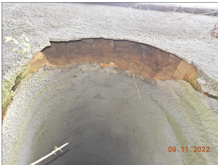
Nosná konstrukce vlevo - vypadnutá část klenby.
