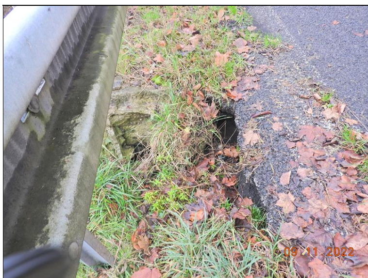
Mezera mezi levou římsou a vozovkou.
