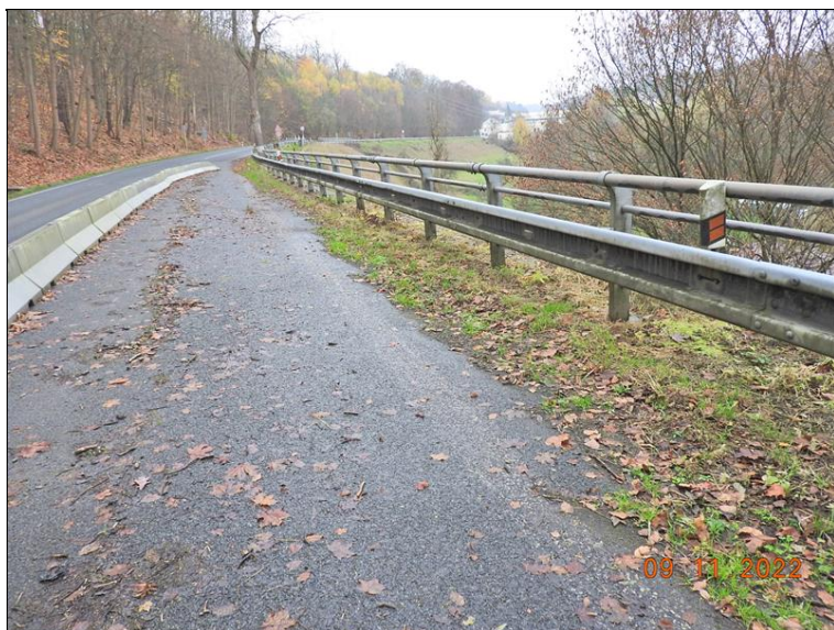
Levá strana mostu - výrazné poklesy ve vozovce.
