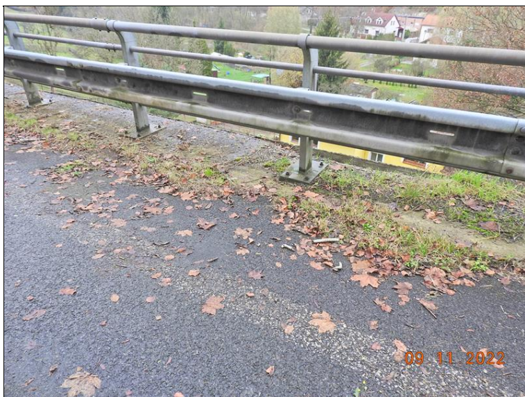
Levá strana mostu - poklesy ve vozovce.
