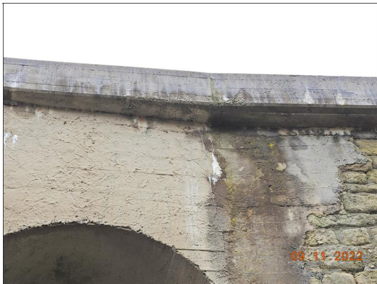
Levá římsa. Zatékání pod římsou.
