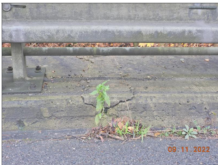
Trhlina v pravé římse.
