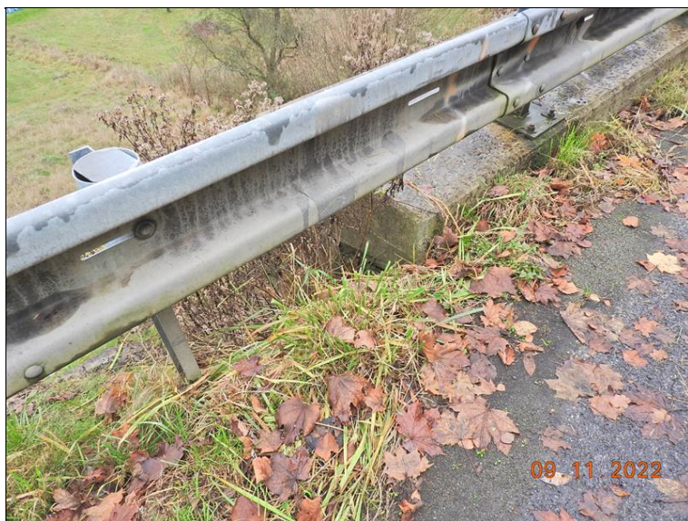
Eroze na levé straně mostu.
