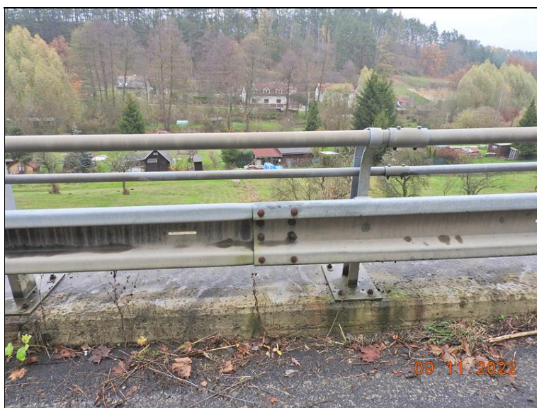
Koroze spojovacího materiálu na levé straně.
