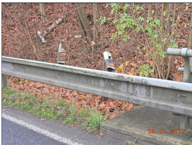
Poškozené směrové sloupky na pravé straně.
