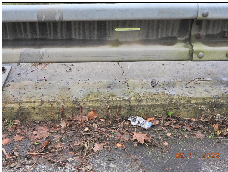
Trhlina v levé římse.
