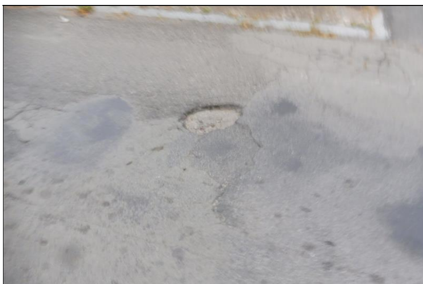
Výtluky na vozovce.
