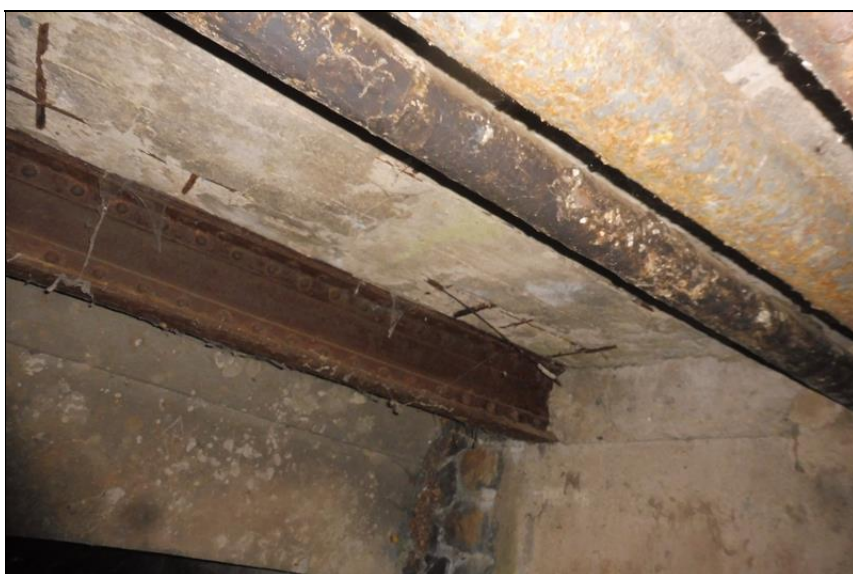
Koroze oc. nosníků.
