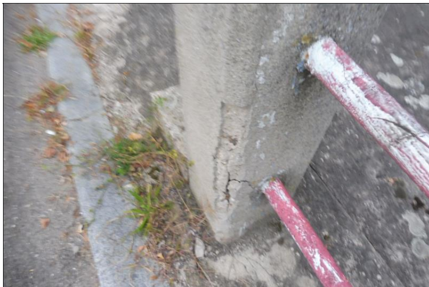
Degradace bet. sloupku, deg. nátěru zábradlí.
