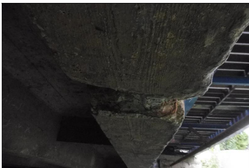
Odhalená korodující výztuž na spodku trámu.
