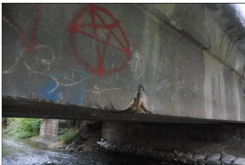
Poruchy na boku trámu.
