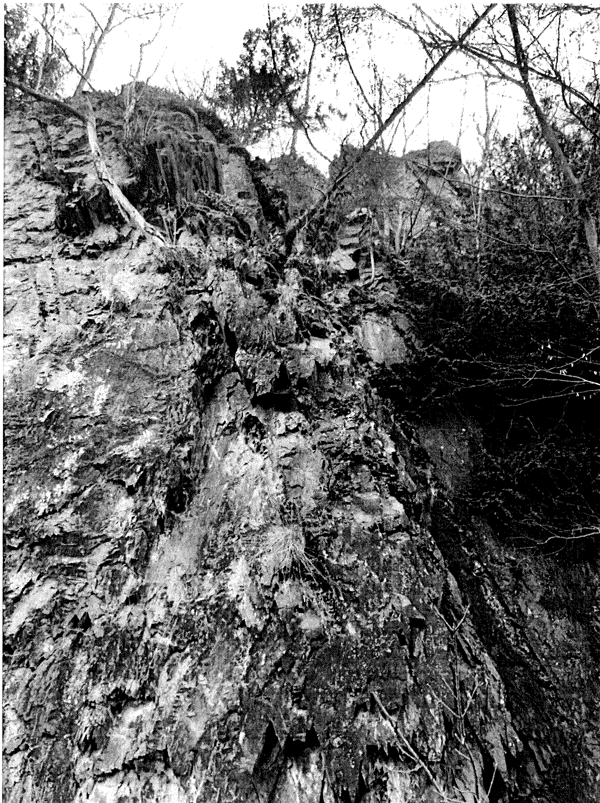
Příloha 1: nejkritičtější místo na skalní stěně – přechod mezi poměrně zdravou a zvětralou částí masivu, převislé konce a bločky nutno odlámat a skálu očistit. Tyto bločky jsou svým umístěním pod výškovou úrovní umístění ochranného plotu
