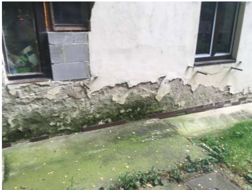
SOKLY, PATA ZDIVA ZATÉKÁNÍ
