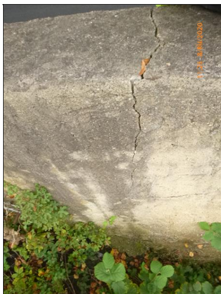
OP2 levé křídlo - trhlina ze zábradelní zídky
