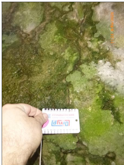
NK - kritická oblast s trhlinou a intenzivním zatékáním
