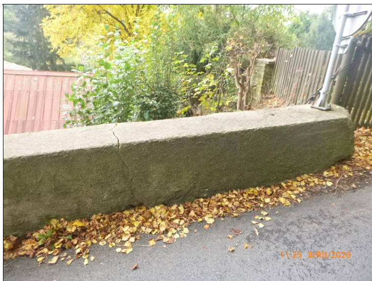
OP2 levé křídlo - trhlina zábradelní zídky
