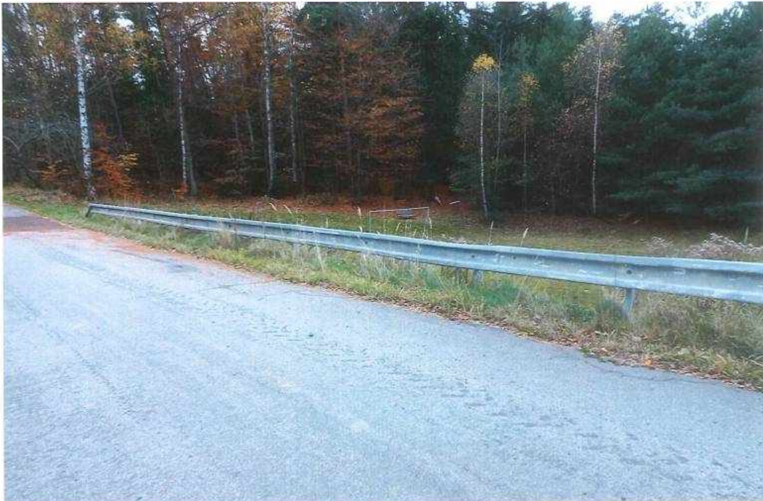
Stávající svodidla - nevyhovující stav
