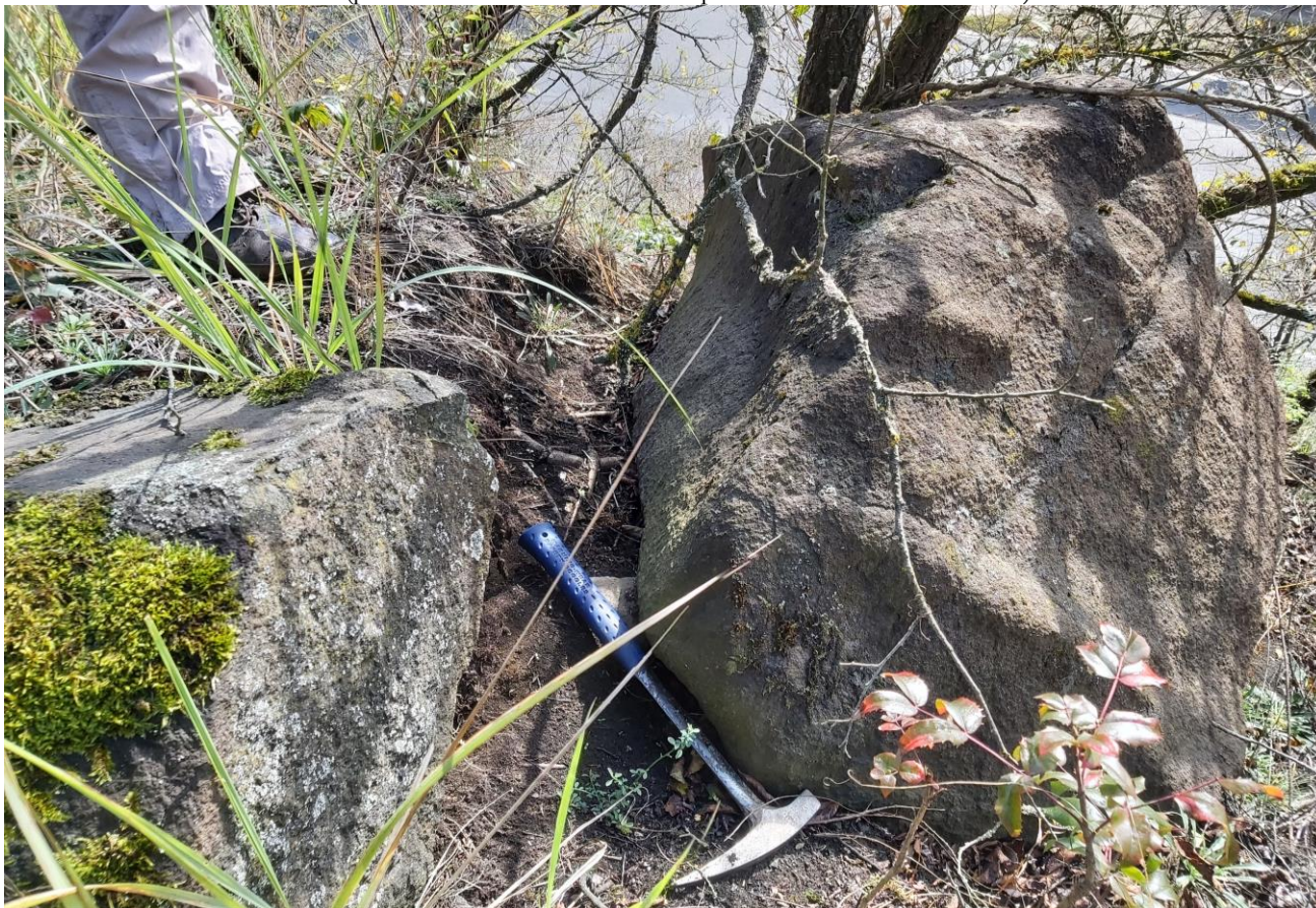
Foto 1 Vychýlení horninového bloku z původní pozice o cca 15 cm po svahu dolů.
