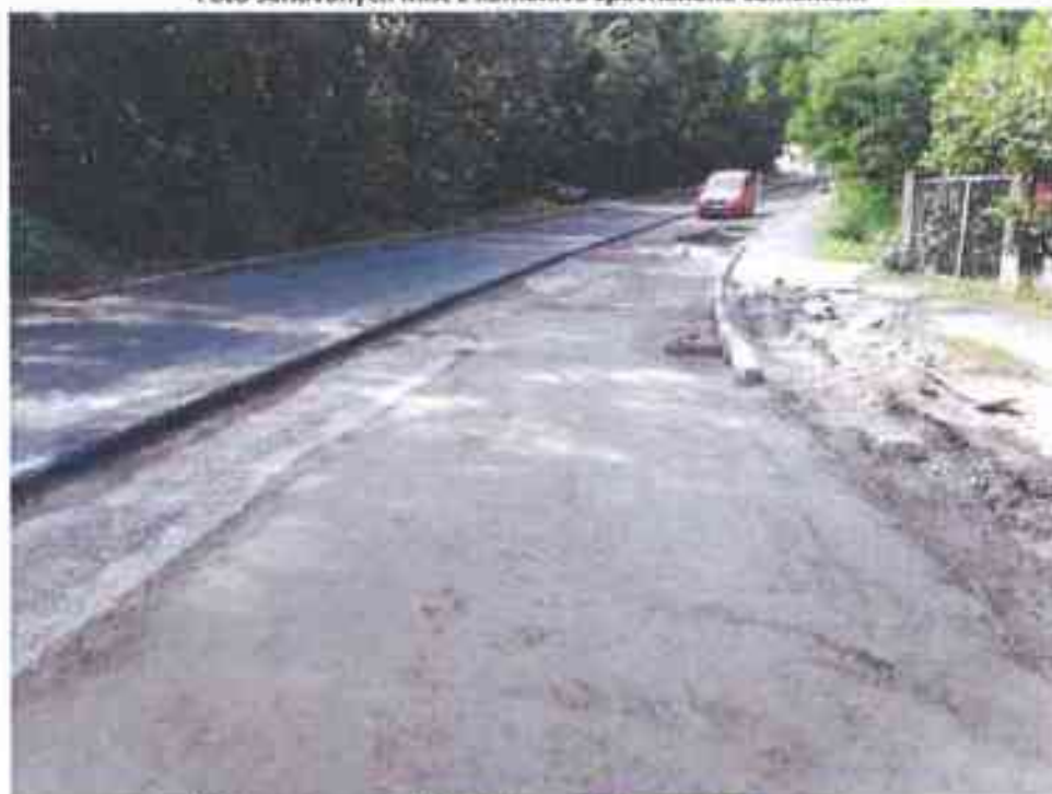
Foto sanovaných míst z kameniva zpevněného cementem
